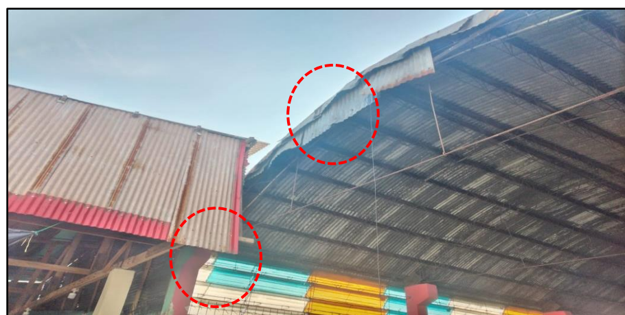
FIGURA 35: ZONA DE RIESGO - DESPRENDIMIENTO DE TECHO FOTOGRAFIA PROPIA
