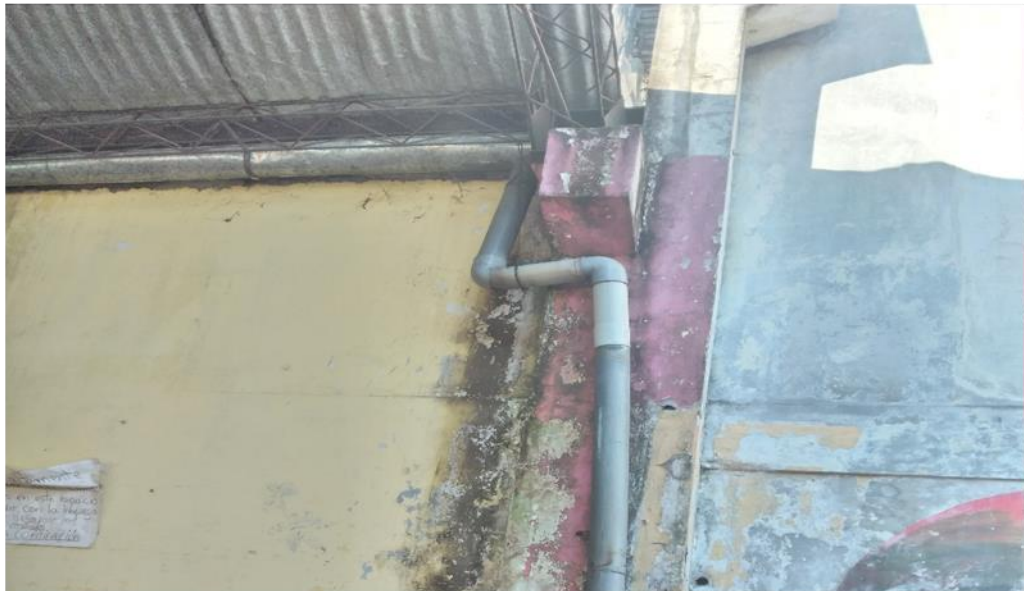
Deslizamiento de aguas fluviales no filtradas por la por tuberías de canalización. Fotografía propia)
