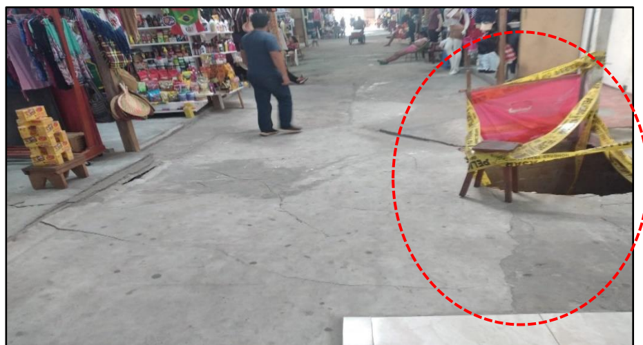
FIGURA 34: ZONA DE RIESGO - DESLIZAMIENTO Y HUNDIMIENTO DE SUELO FOTOGRAFIA PROPIA
