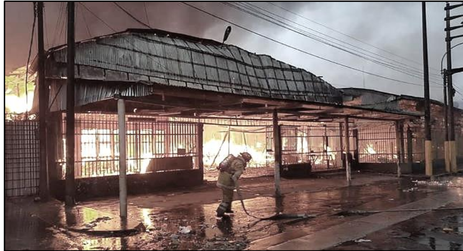
FIGURA 28: ESTADO ACTUAL - DESPUES DEL INCENDIO DEL 2019
