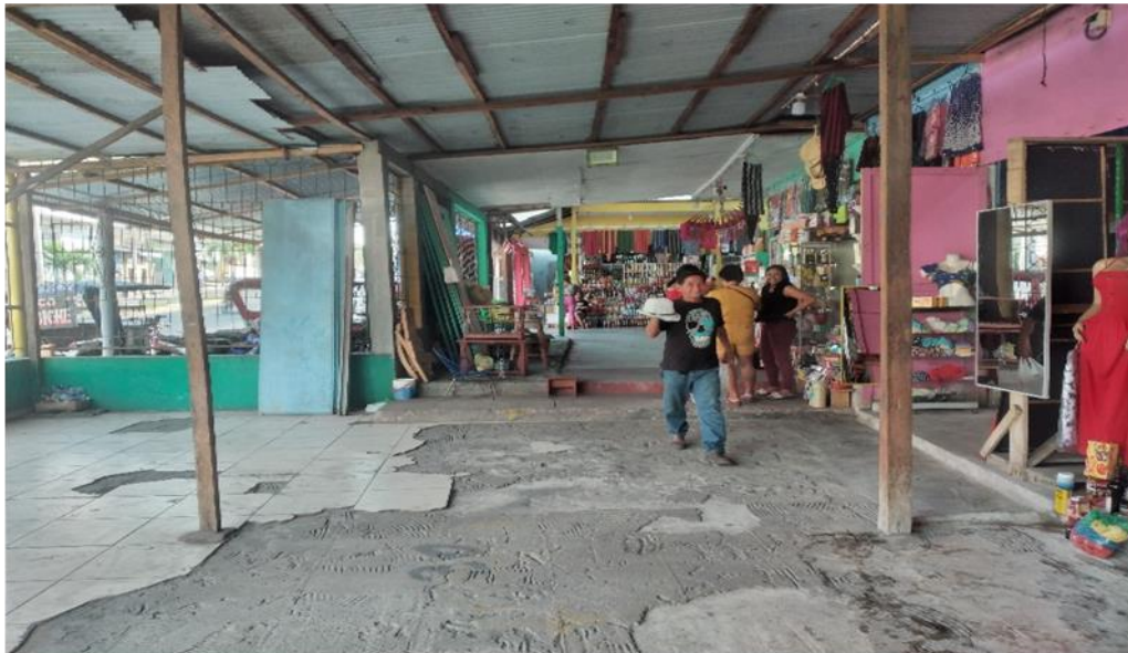
Pisos y estructura de cubierta no calificada en mal estado no aptos para la seguridad del centro comercial. (Fotografía propia)
