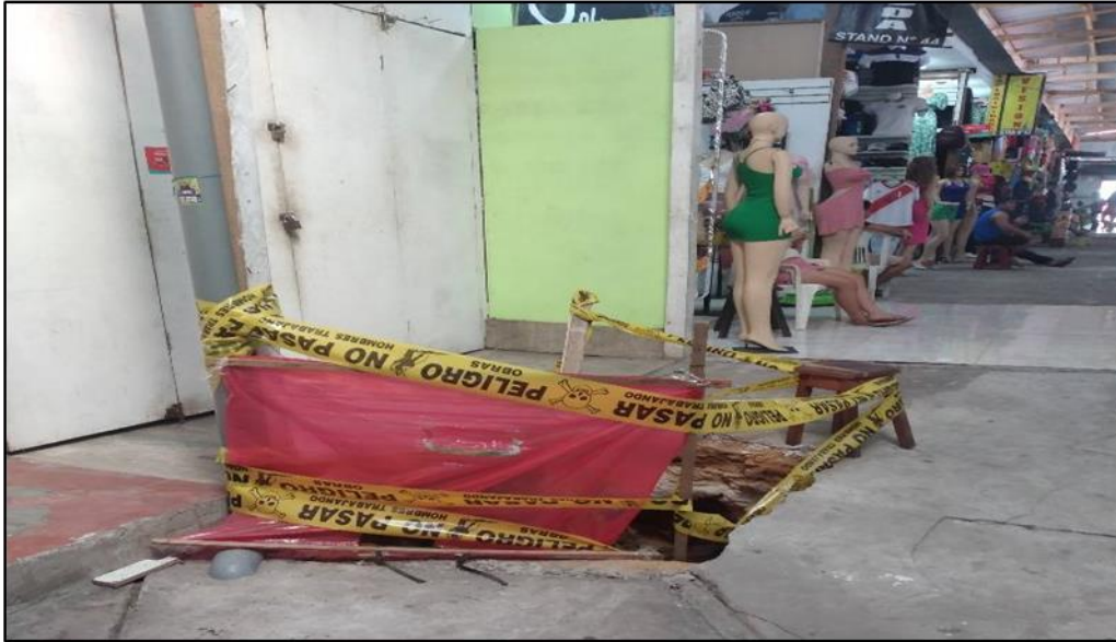
Desbarrancamiento y filtración de agua al interior del centro comercial. (Fotografía propia)
