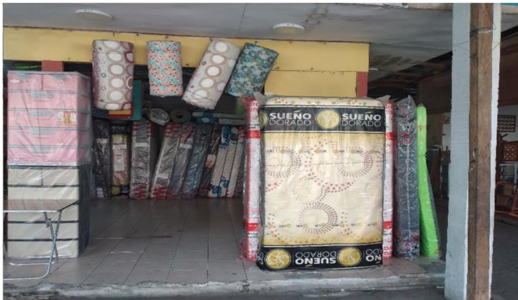
Cubiertas en las estado , filtración de agua en los cielorrasos de varios puestos de venta del centro comercial. (Fotografía propia)
