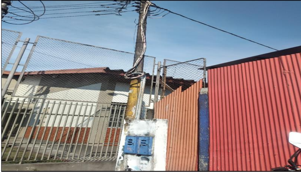
Conexión central a la matriz de electrificación, en malas condiciones, riesgo de electrocución. (Fotografía propia)
