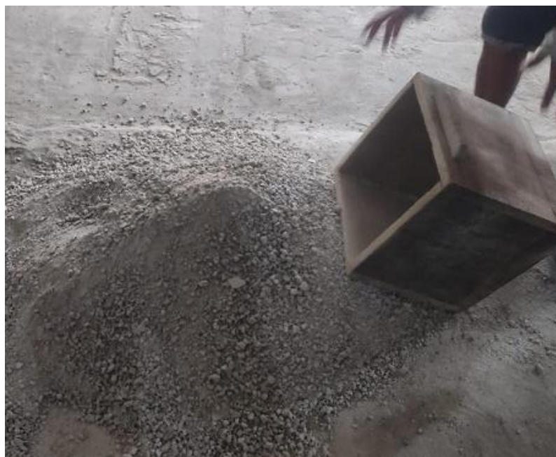
Foto N° 17 : Medición y Proporcionalidad de los Residuos de Tarrajeo para la Elaboración del Ladrillo de Mortero.
