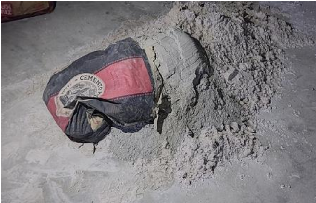
Foto N° 10 : Materiales: Dosificación de Cemento y Agregado Fino para la Elaboración del Ladrillo Convencional de Mortero.
