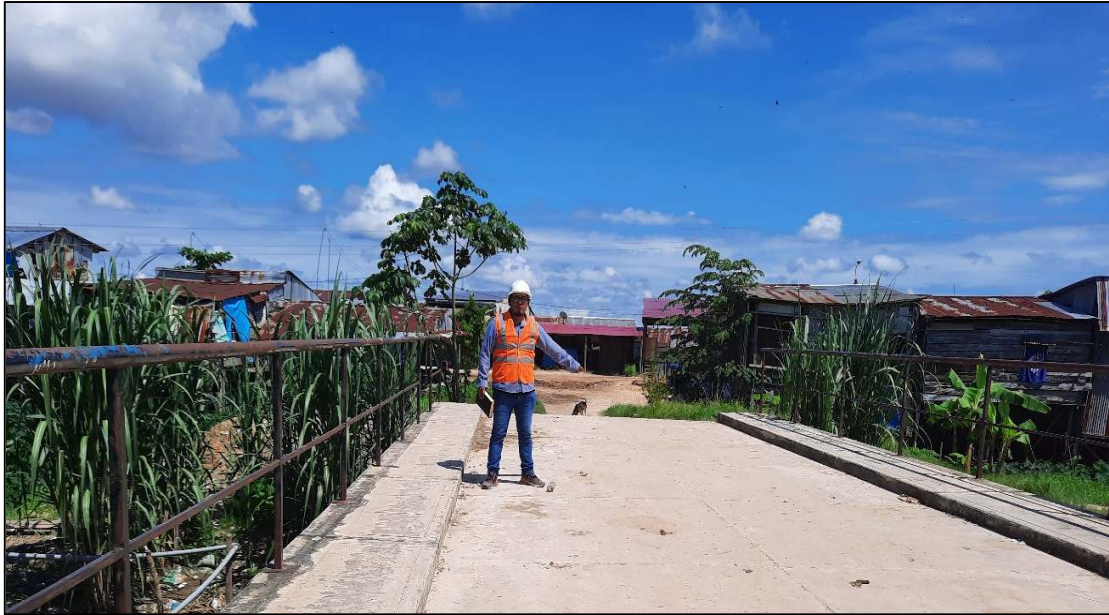
Foto 09: Evaluación superficial de pavimento rígido
