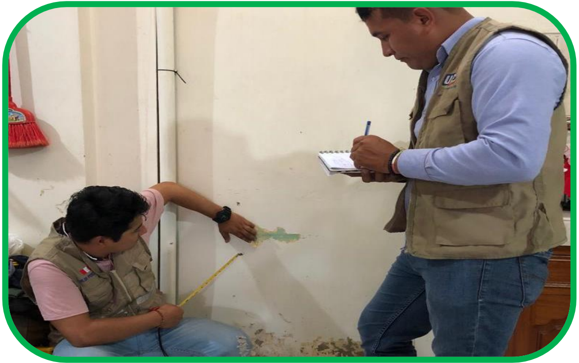
Identificación de manchas por humedad y desprendimiento de pintura.
