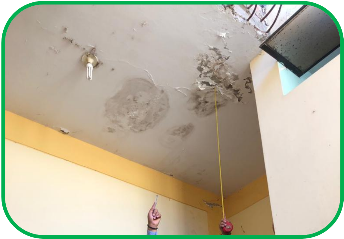
Identificación de desprendimiento de pintura por presencia de humedad.
