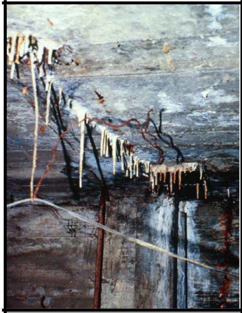
Ilustración 8: Pérdida de sección de acero útil.
