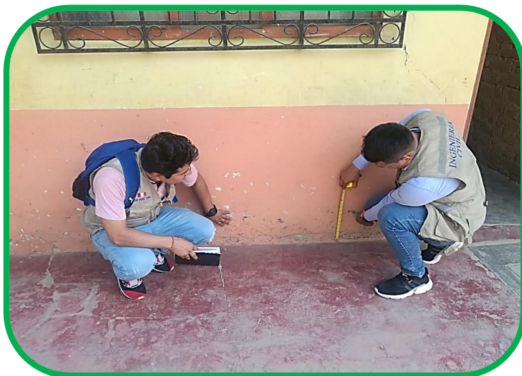
Identificación de manchas por humedad, desprendimiento de la pintura y grietas en el piso de cemento pulido.
