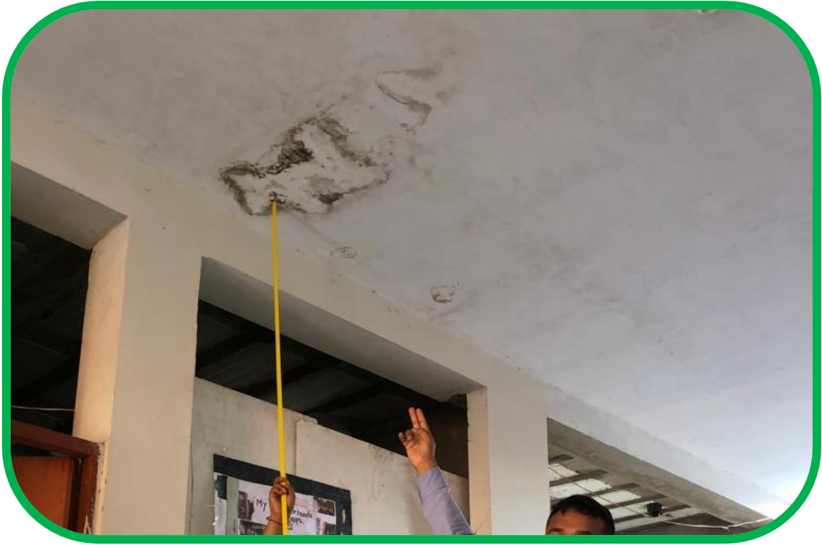
Identificación de manchas en el techo de la vivienda por presencia de humedad.
