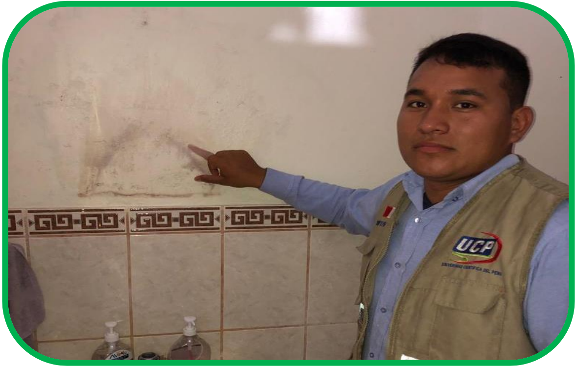
Observamos manchas en la pared causadas por humedad.
