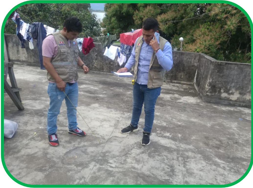
Identificación de manchas en el piso del aligerado.
