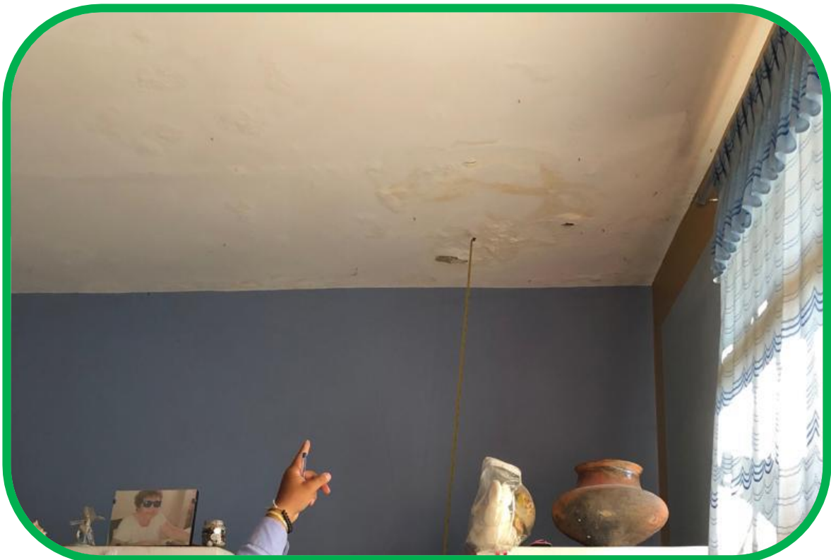
En varias partes del techo aligerado se observa el desprendimiento de pintura y manchas causadas por la humedad.
