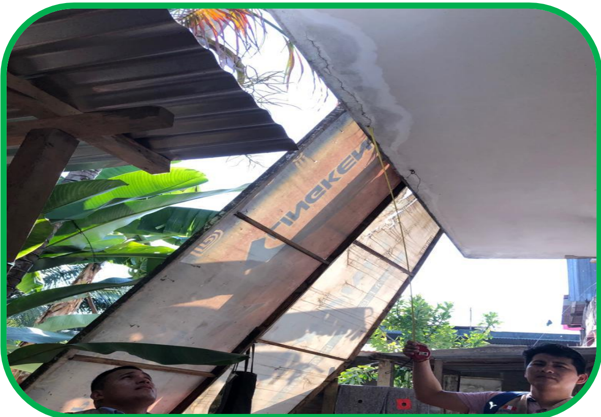
Identificación de grietas y manchas en el techo por causa de la humedad.
