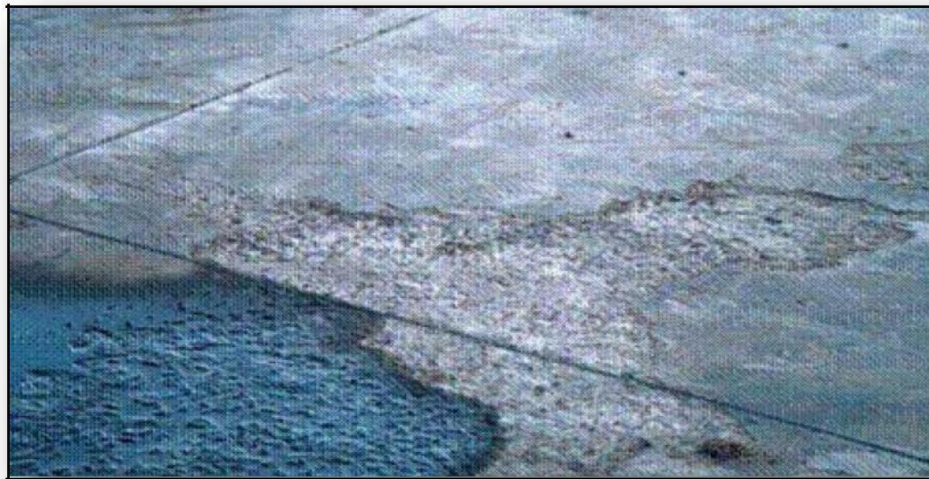
Ilustración 6: Ataque por congelamiento de una losa.
