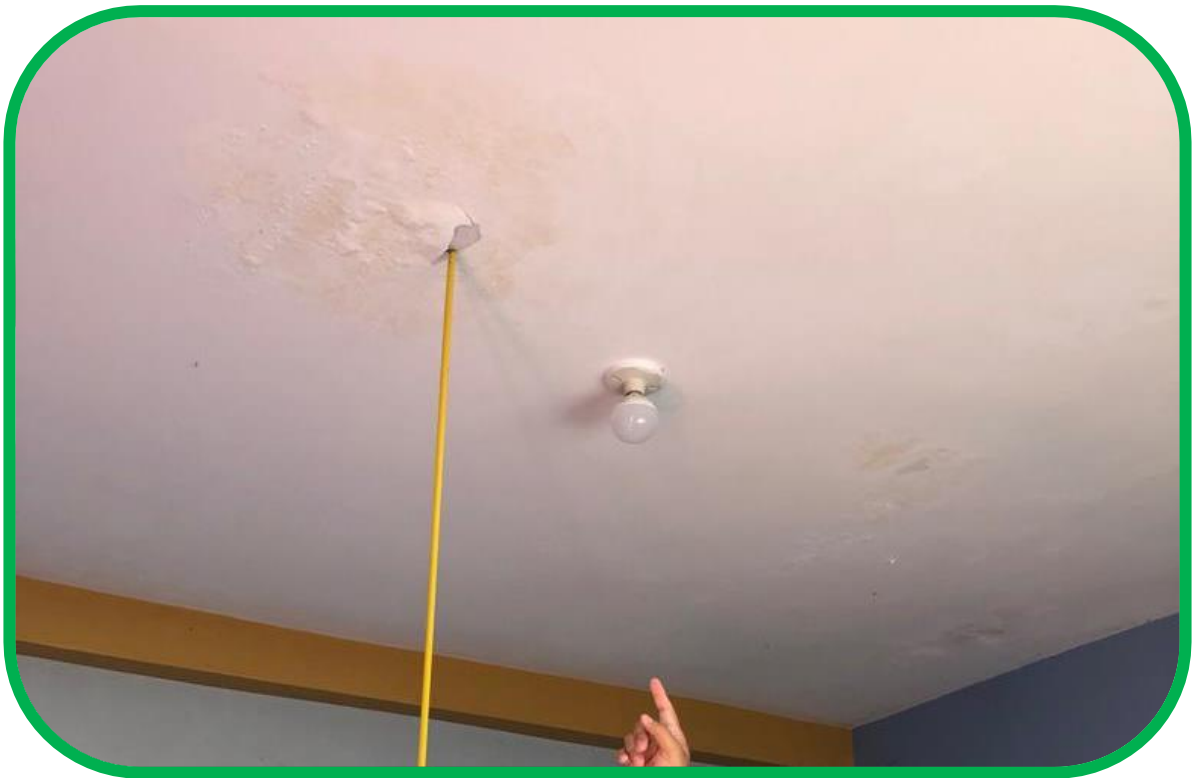
Se observa la presencia de humedad en el techo aligerado de la edificación.
