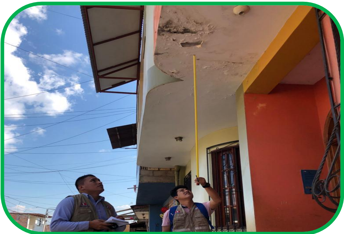
Identificación de desprendimiento de la pintura en el aligerado por causa de humedad.
