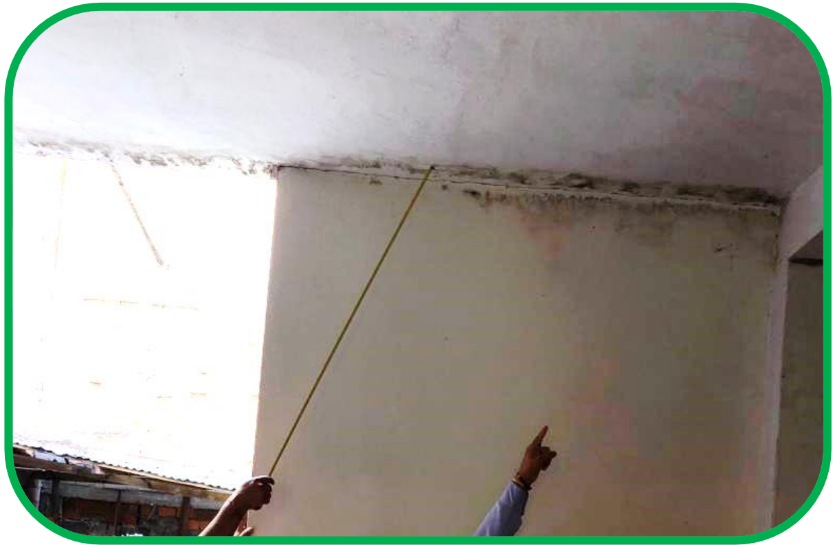
Manchas por causa de la humedad, en techo y muro.
