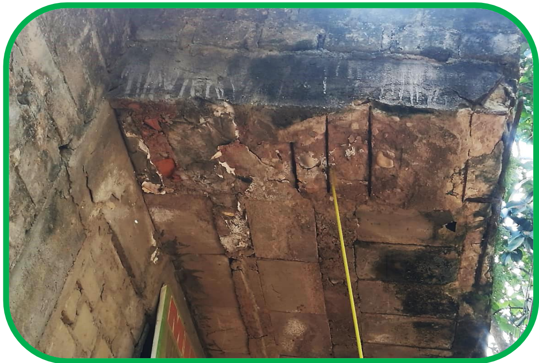
Se observa la corrosión del acero del aligerado y el desprendimiento del concreto.
