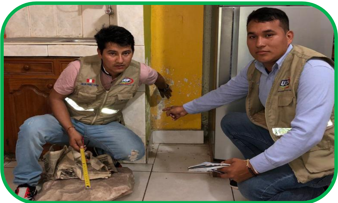
Podemos apreciar desprendimiento de pintura en la pared de la edificación.
