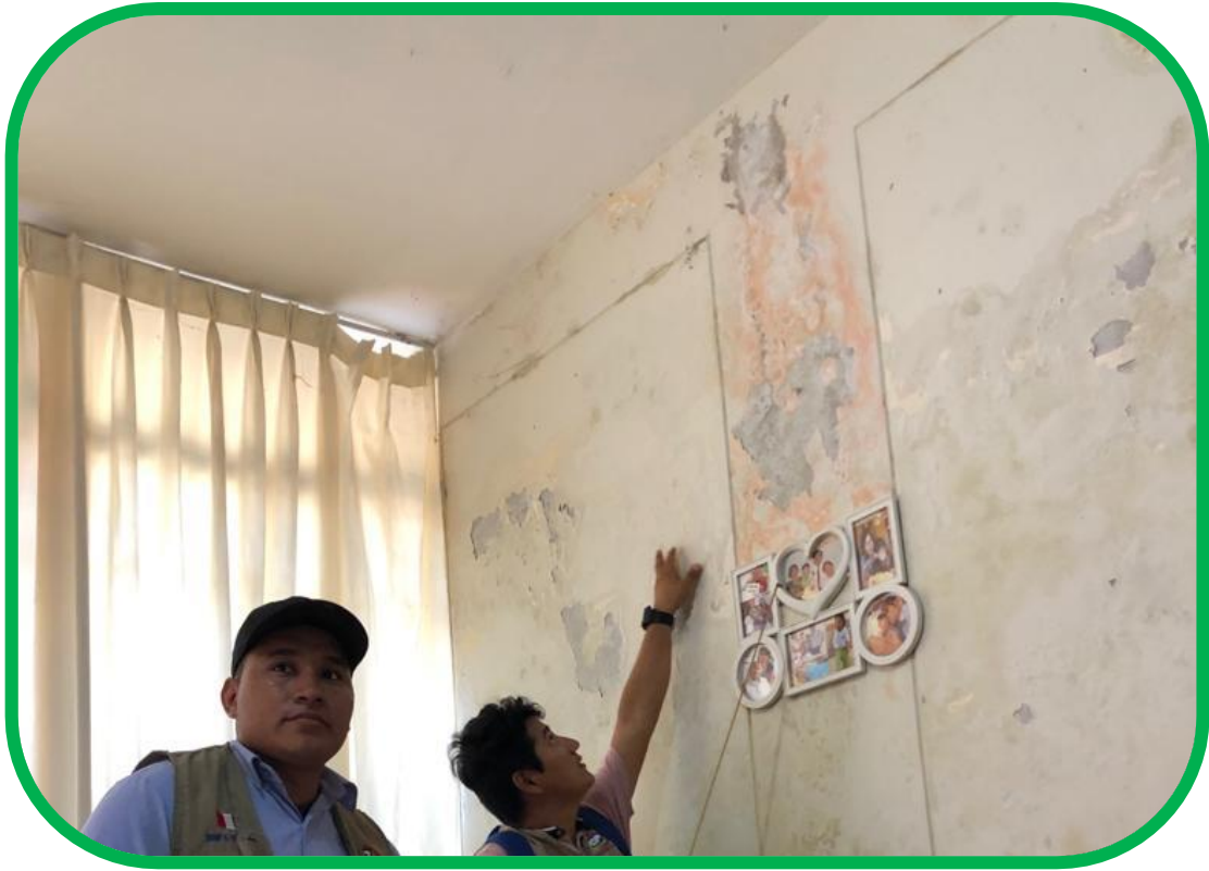
Identificación de manchas en la pared y fisuras.
