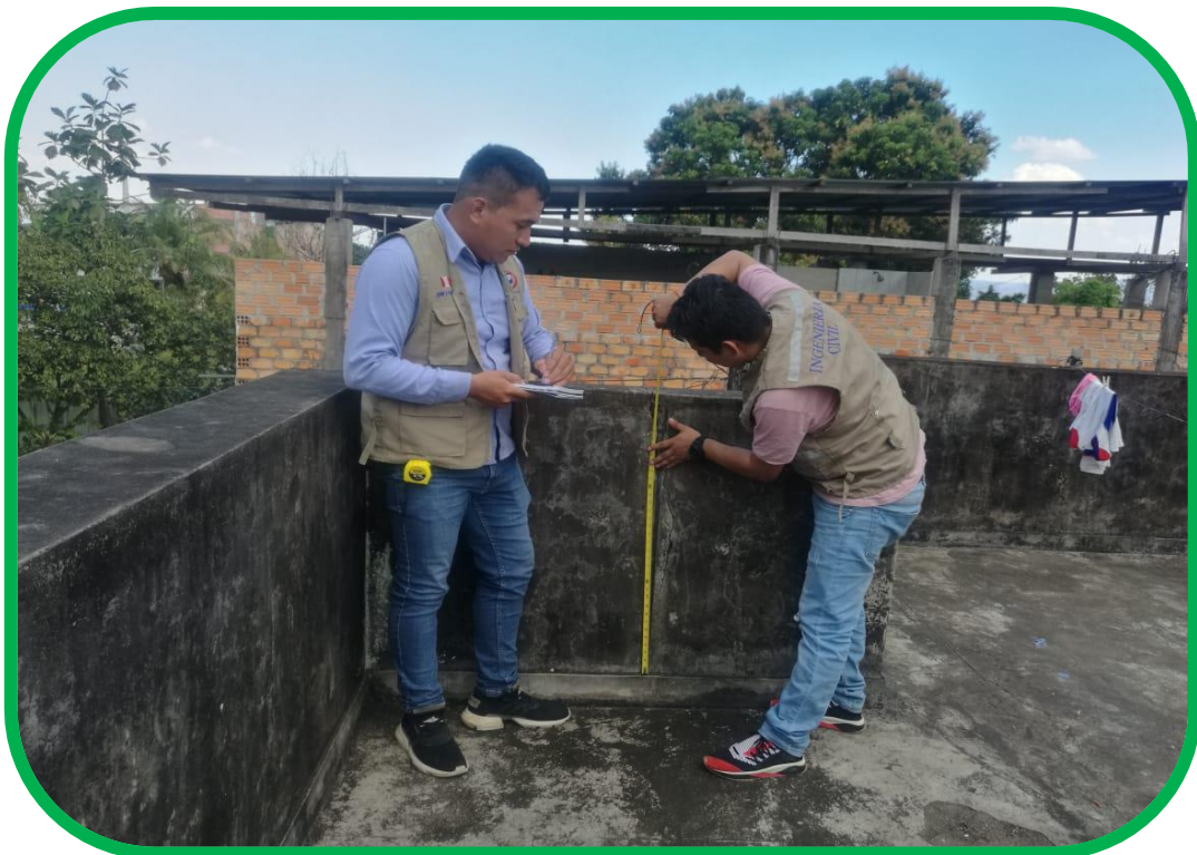
Identificación de grieta en las paredes de la azotea, se puede apreciar que se extiende todo el alto.
