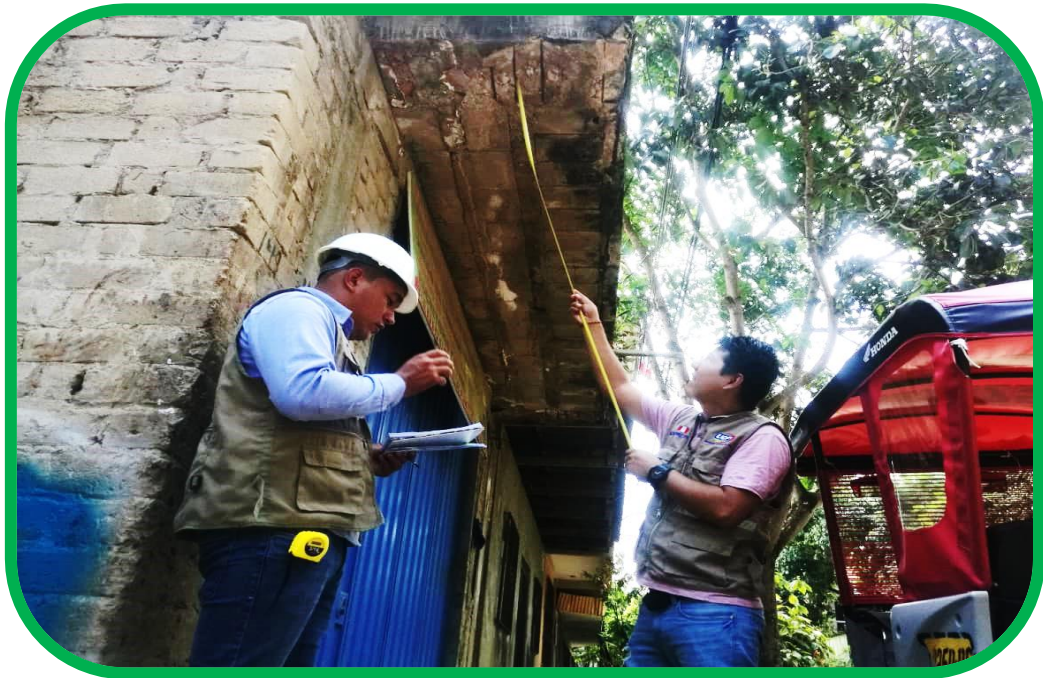
Identificación de acero oxidado, (pérdida del área útil de acero) y se evidencia que los bloques no han sido colocados correctamente.
