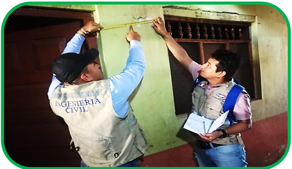
Se visualiza la presencia de grietas en la pared de la vivienda.
