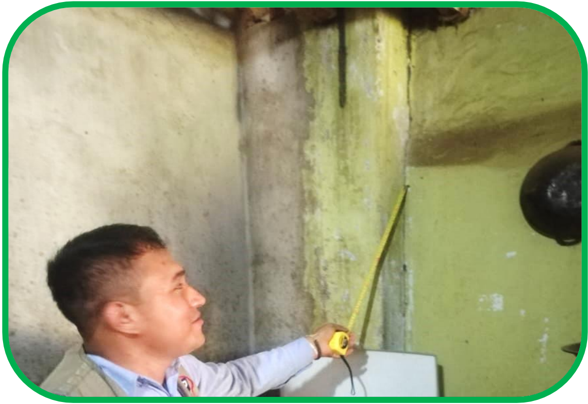
Identificación de manchas de humedad y también la presencia de grietas.
