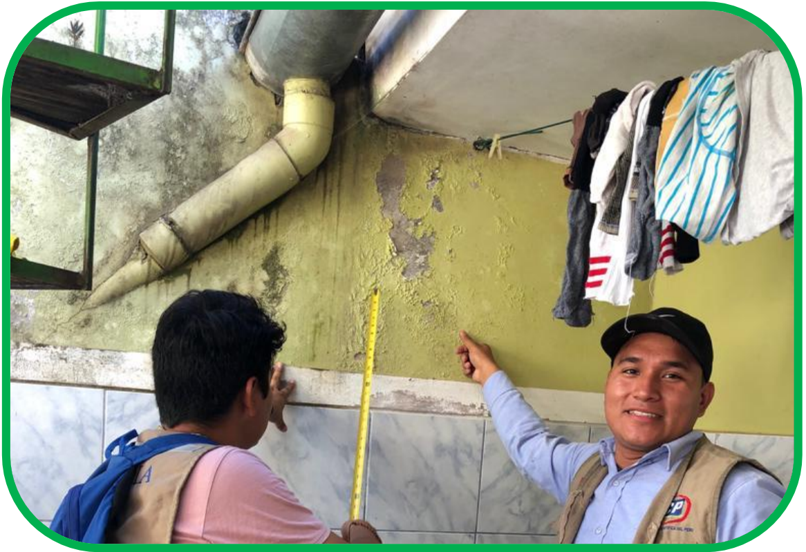
Identificación de desprendimiento de pintura por humedad, se observa también el deficiente proceso constructivo.
