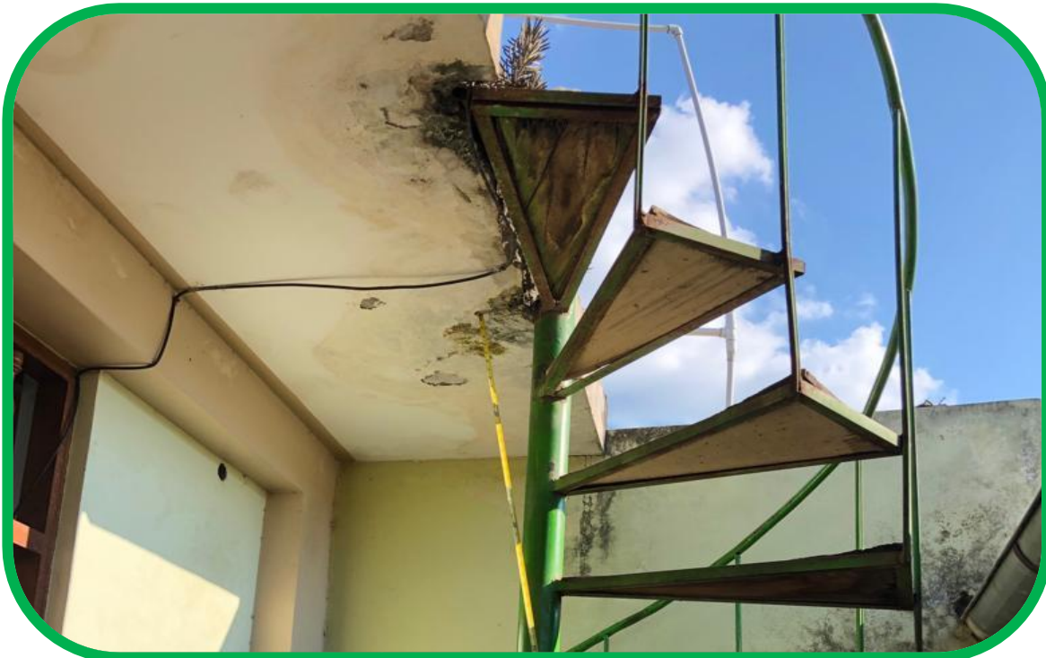
Se observa presencia de humedad y corrosión del acero, causada por el deficiente empalme de la escalera.
