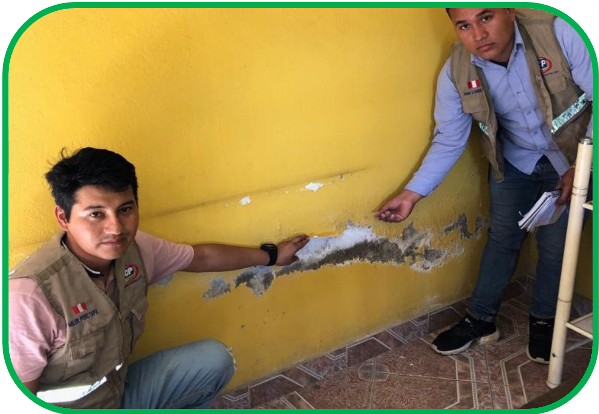
Se ve que la humedad está afectando severamente el concreto.
