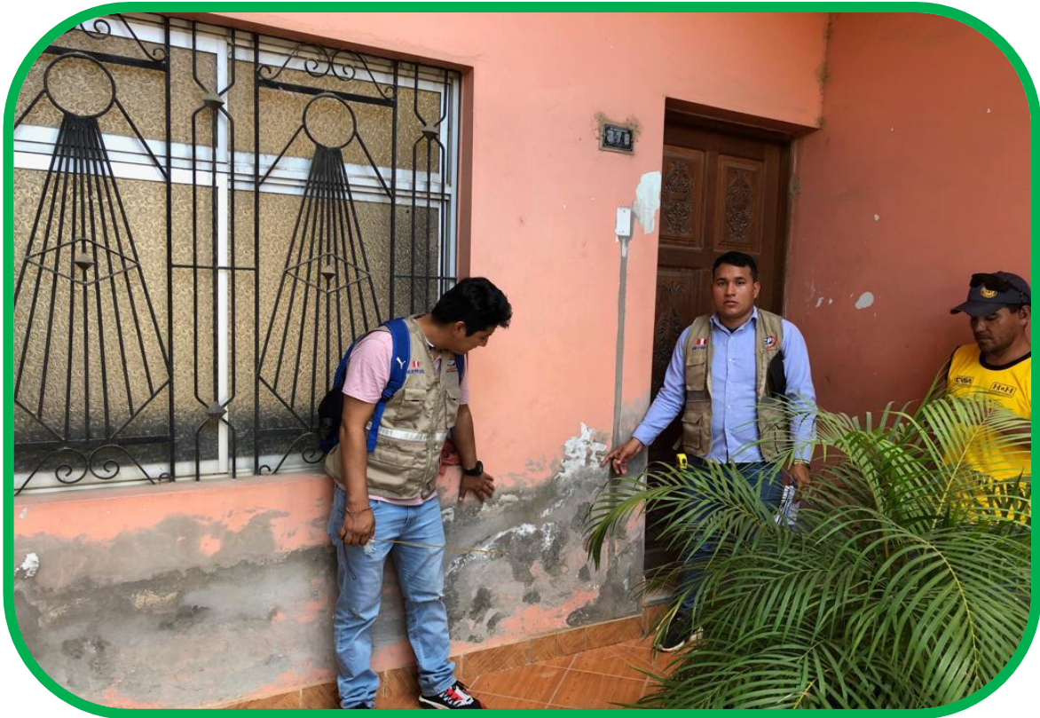
Identificación de manchas en las paredes y desprendimiento de pintura, que es muy común en casi todas las viviendas.
