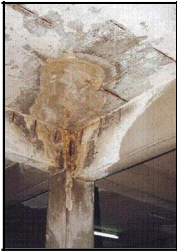
Ilustración 7: Pérdida de sección de acero útil.
