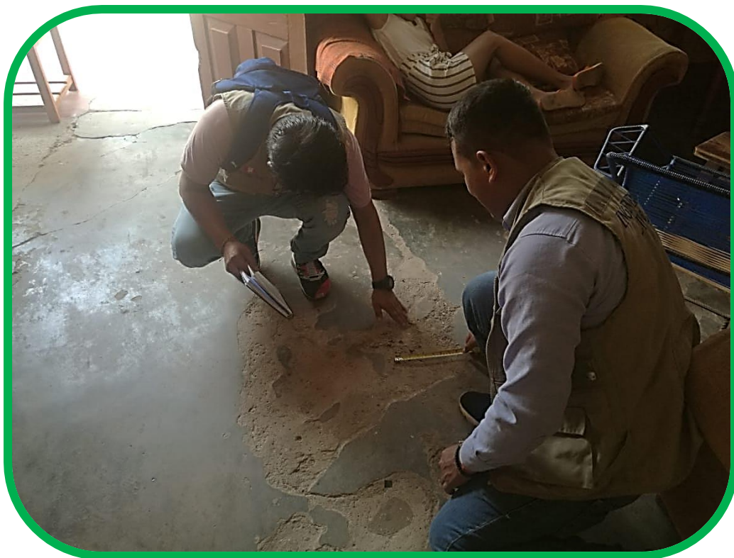
Identificación del piso en mal estado, desprendimiento del piso de cemento pulido.
