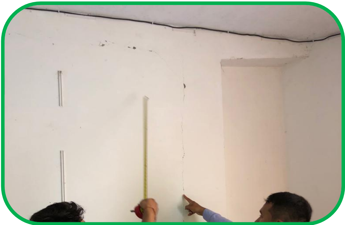
Presencia de grietas en la pared de la edificación, tanto verticales como horizontales.
