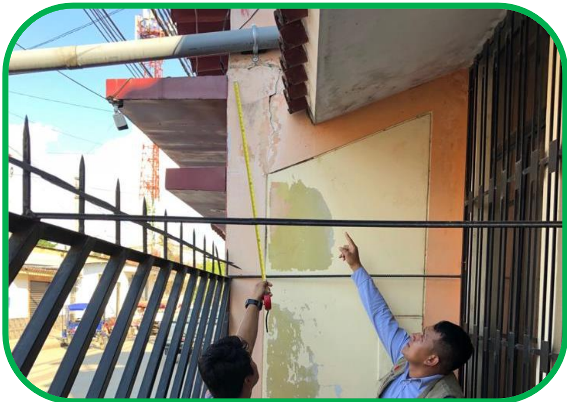
Se observa manchas en la pared y grietas.
