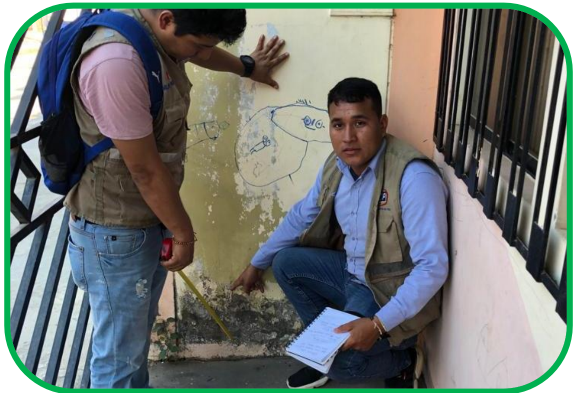
Se observa desprendimiento de pintura en la pared, por presencia de humedad.
