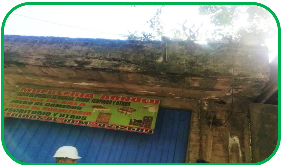
Se visualiza presencia de organismos vegetales, debido a la mala calidad de los agregados utilizados en la edificación.
