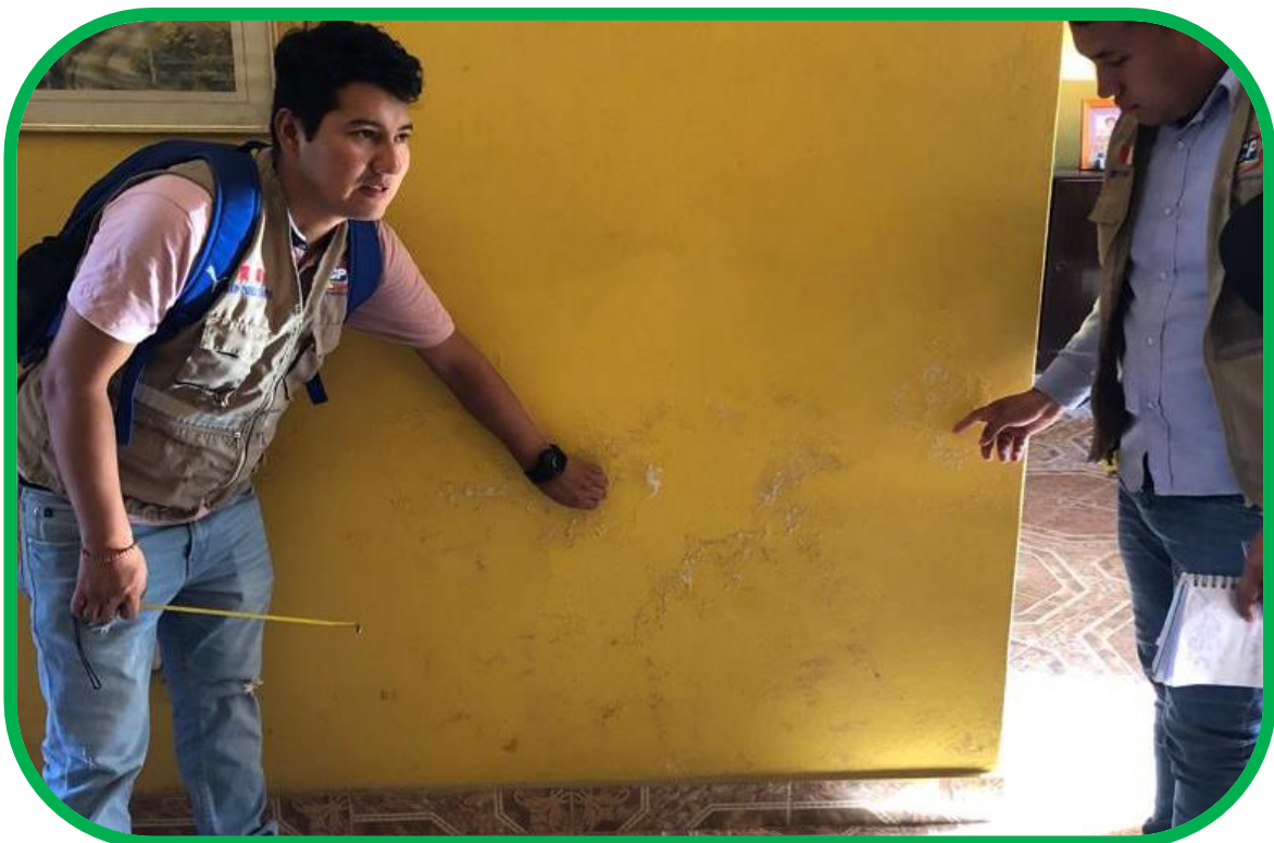
Podemos observar desprendimiento de pintura en las paredes de la vivienda.
