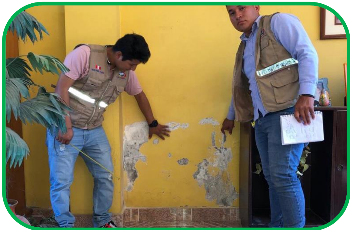
El desprendimiento de pintura es una problemática muy severa en esta edificación.
