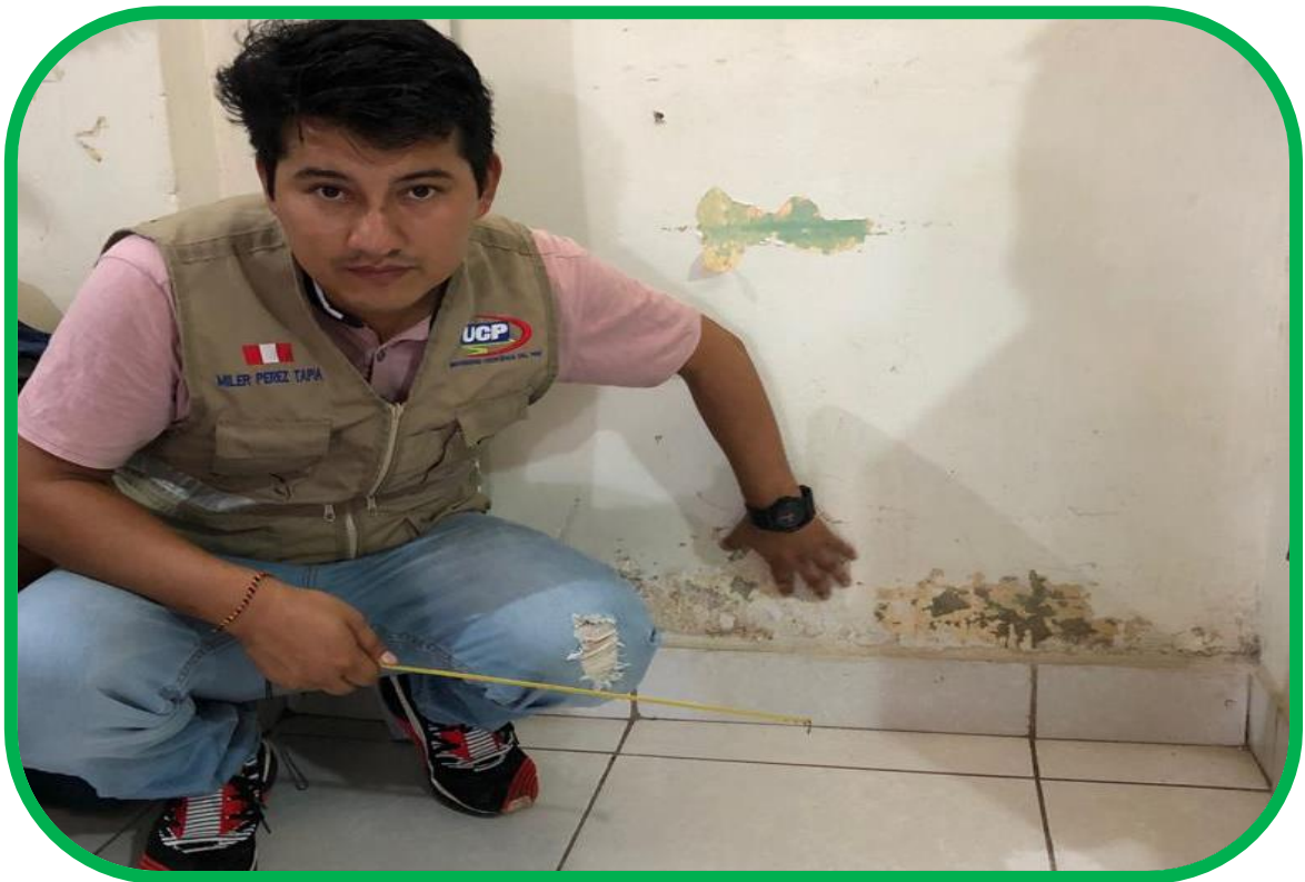
Visualizamos manchas en la pared caudadas por humedad.
