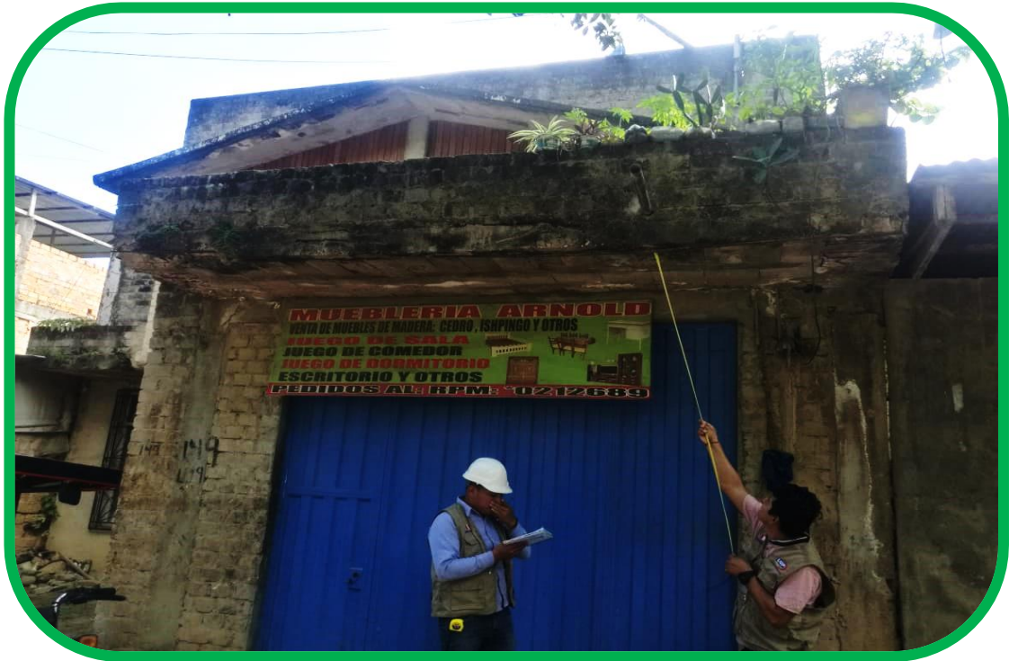
Identificación daño por la aparición de organismos vegetales, lo que provoca la humedad y también presencia de grietas.
