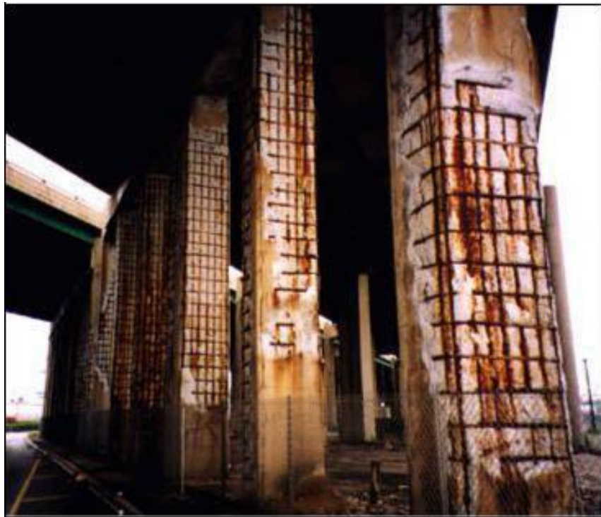
Ilustración 3: Fotografía de un conjunto de columnas que soportan una losa. Se pueden observar grietas producto de la corrosión del acero.
