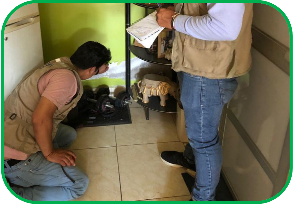
Identificación de eflorescencia en las paredes de la edificación.
