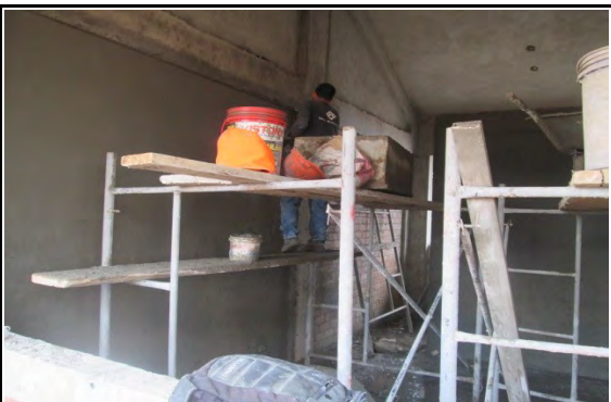
Fotografía N° 21.- Vista de trabajos en partida de tarrajeo en muros, seleccionada para evaluación.
