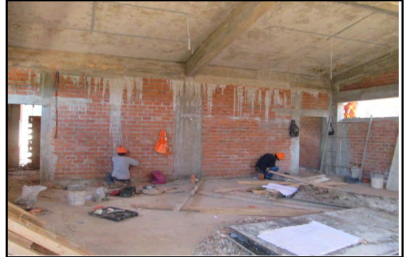
Fotografía N° 20.- Vista de trabajos en partida de asentado de muros, seleccionada para evaluación.
