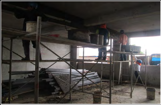
Fotografía N° 19.- Vista de trabajos en partida de tarrajeo en vigas, seleccionada para evaluación.
