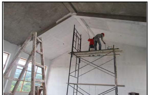
Fotografía N° 24.- Vista de trabajos en partida de pintura en exteriores, seleccionada para evaluación.
