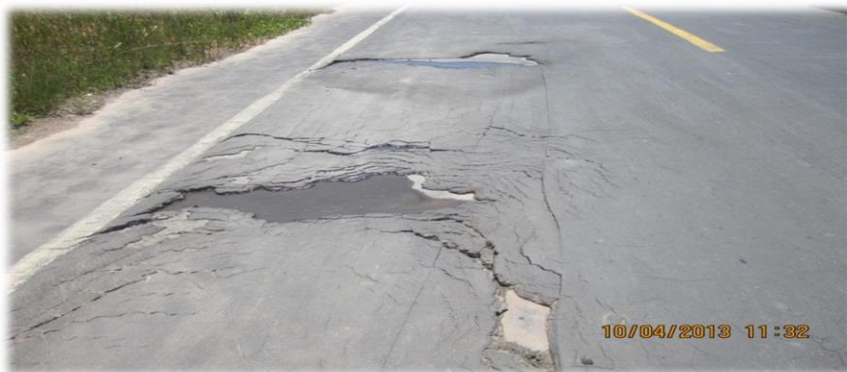
Foto N° 02: Pavimento de la Carretera Iquitos – Nauta.
