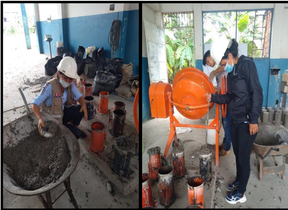
FOTOGRAFÍA N° 25 - VISTA FOTOGRÁFICA DONDE SE MUESTRA EL PROCEDIMIENTO DE LA REALIZACIÓN DE LAS PROBEAS DE CONCRETO
