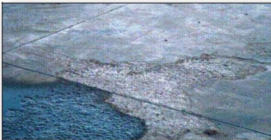
Ilustración 1: Ataque por congelamiento de una losa.
