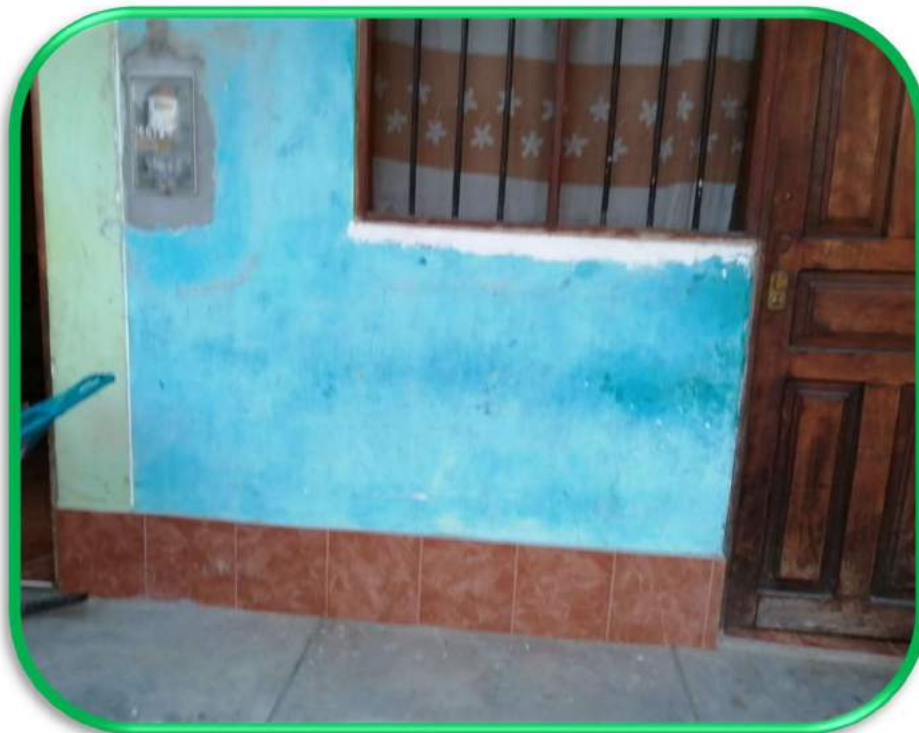
Se visualiza la presencia de eflorescencia en la pared.
