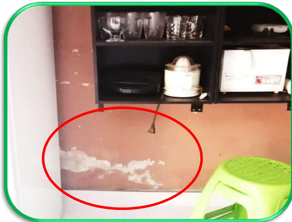
Podemos observar la presencia de eflorescencia en las paredes que son ocasionados debido a la presencia de sales solubles.
