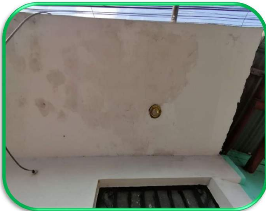
Se visualiza manchas ocasionada por la humedad dando una mala imagen a la fachada.
