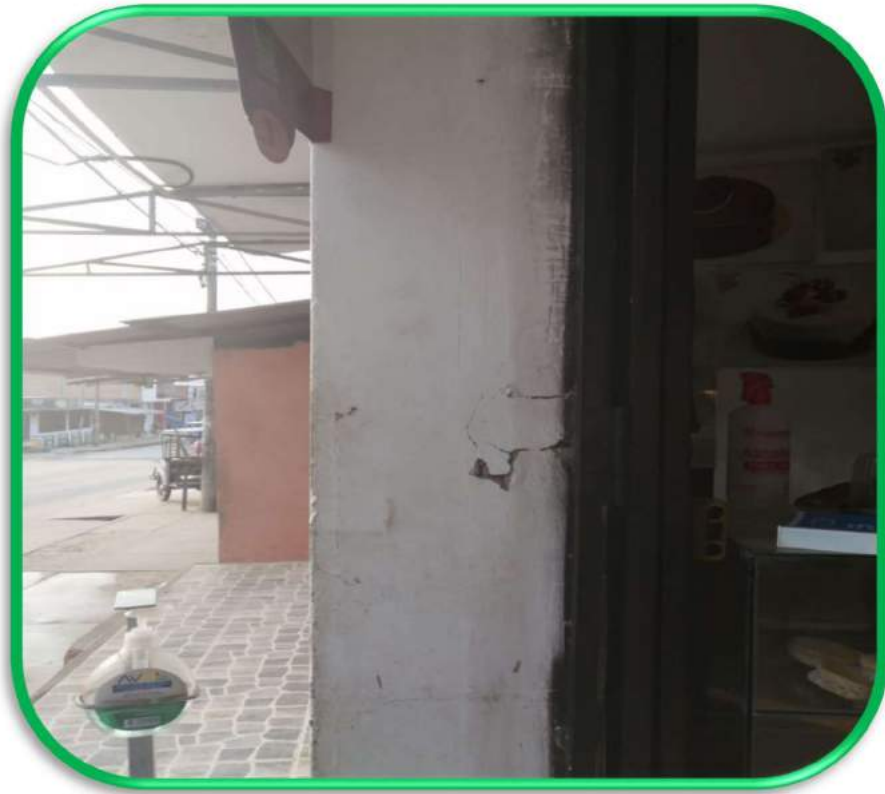
Identificación de grietas.
