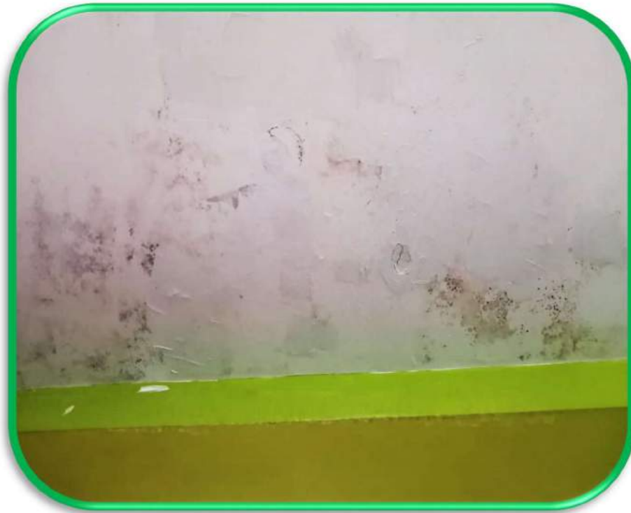
Visualizamos manchas por humedad y desprendimiento de pintura.
