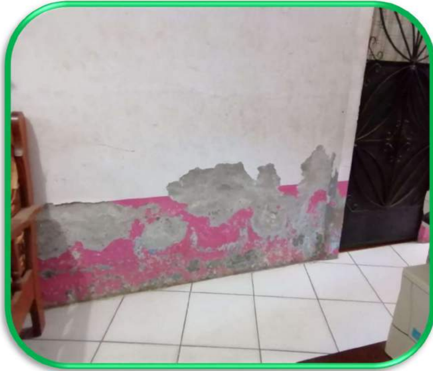
Se observa la presencia de manchas por humedad y desprendimiento de pintura.
