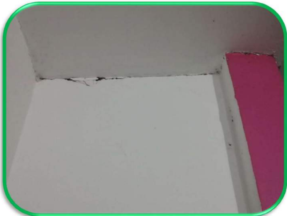
Se observa la presencia de grietas y desprendimiento de concreto.
