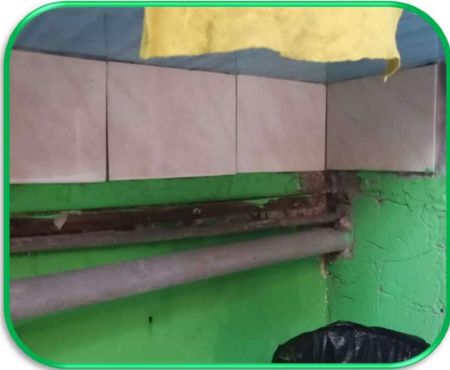
Podemos observar desprendimiento de concreto.
