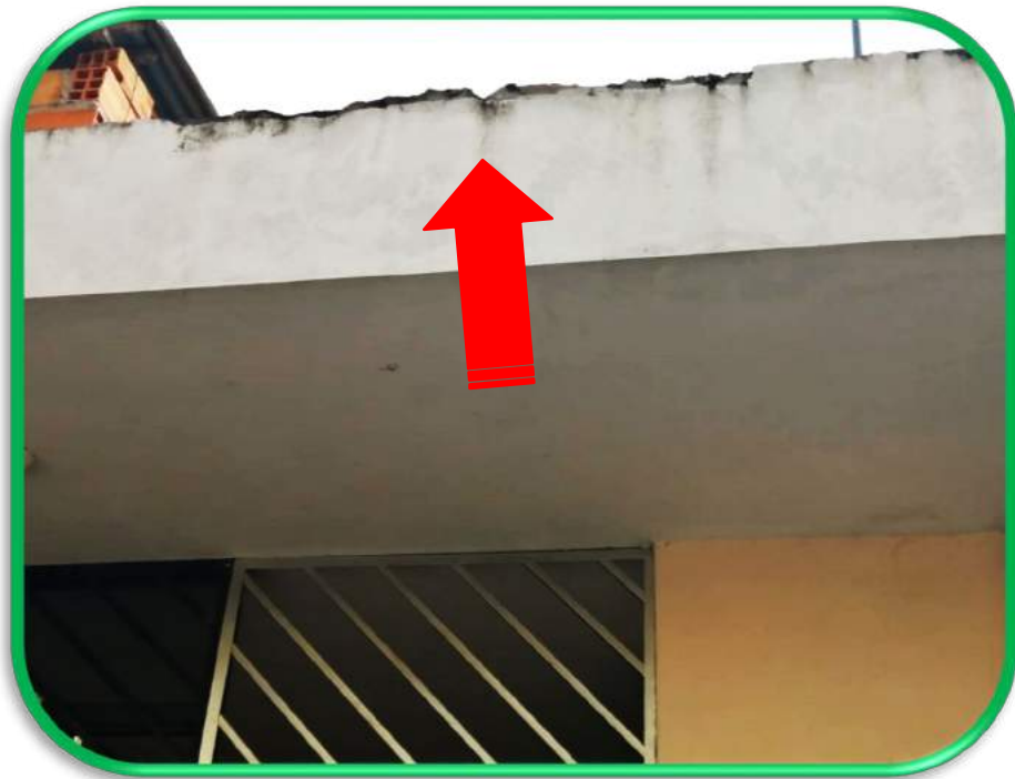
Visualización de manchas ocasionadas por la humedad.
