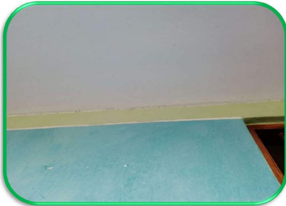
Se visualiza la presencia de grietas.
