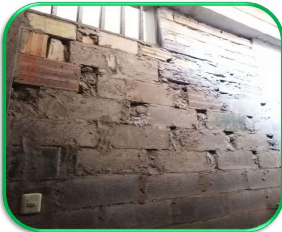
Podemos visualizar desprendimiento del concreto.
