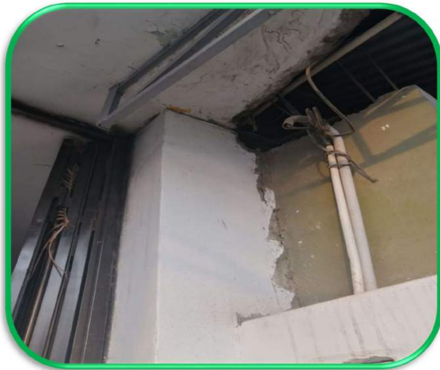
Identificación de manchas por humedad.
