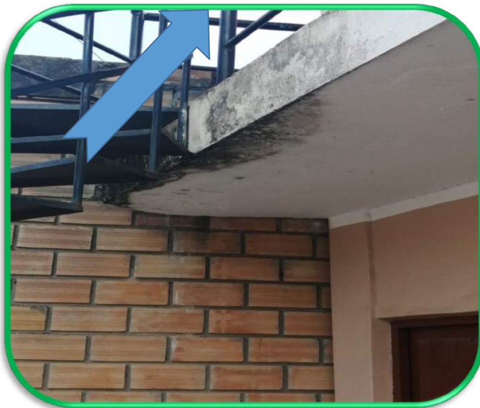
Identificación de manchas por humedad esto ocasiona desprendimiento de pintura.
