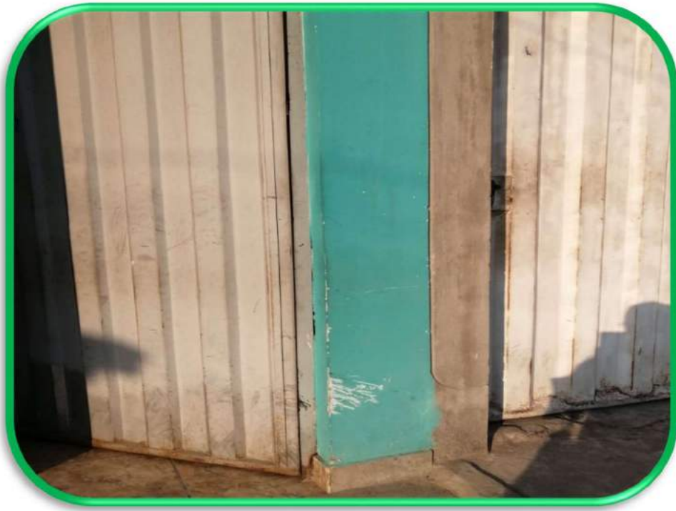
Podemos apreciar fisuras en las columnas.
