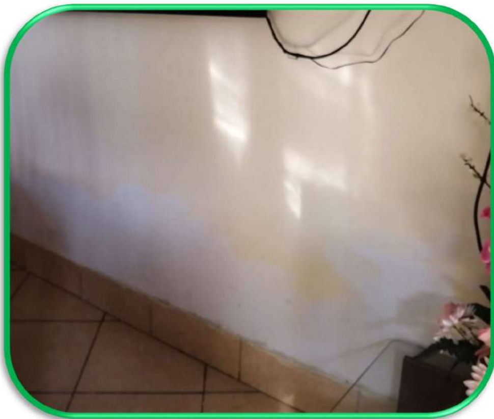
Se puede visualizar eflorescencia en las paredes que es ocasionada por la presencia de humedad.
