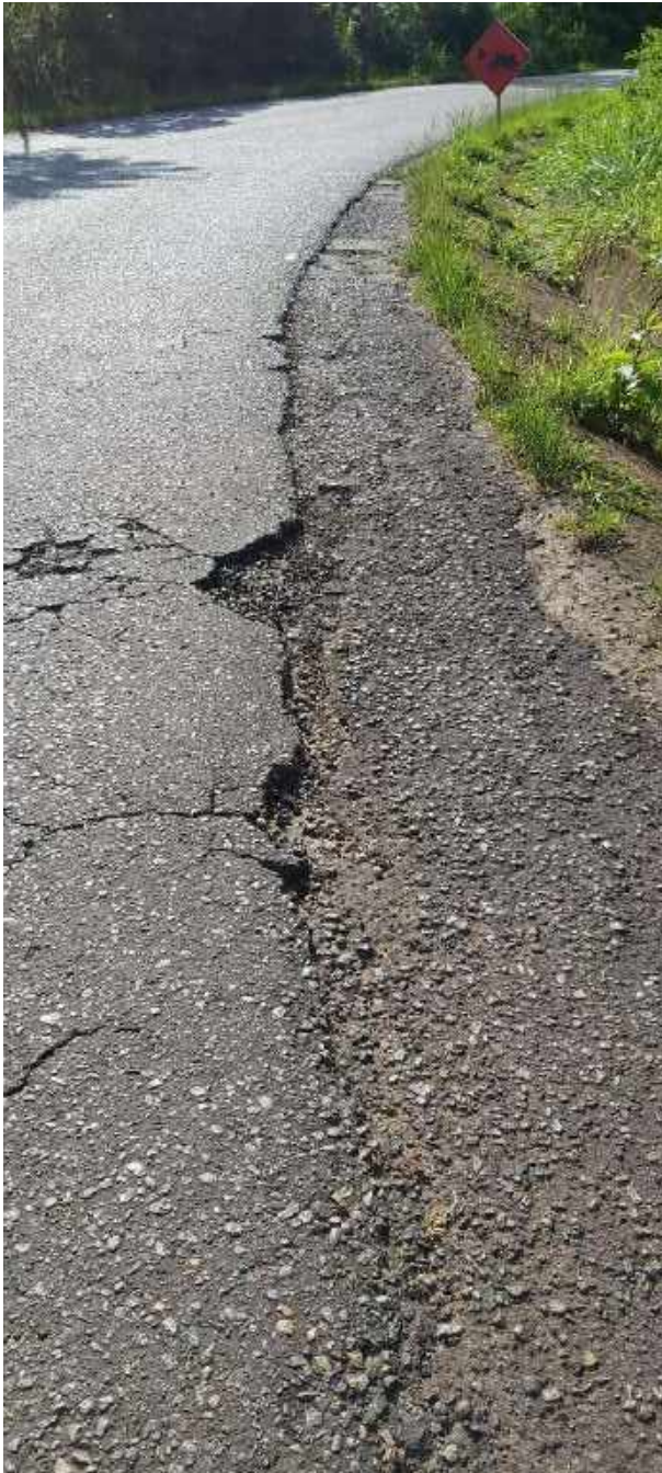
FOTO N°9: fallas de desnivel carril-berma y grietas de borde
