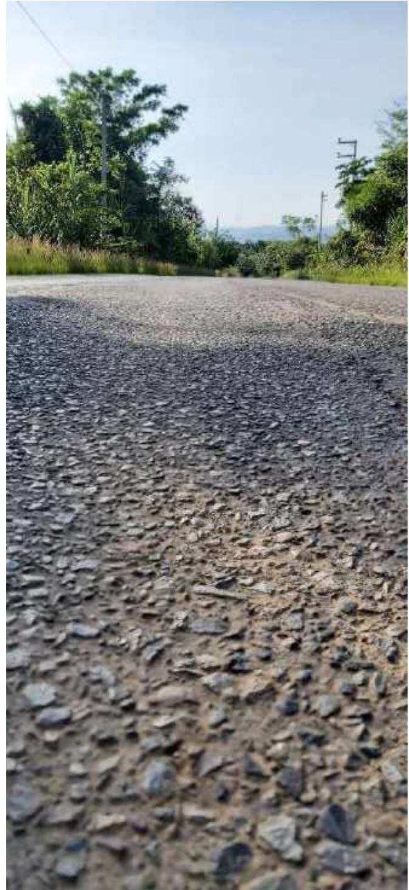
FOTO N°8: falla de desprendimiento de agregados
