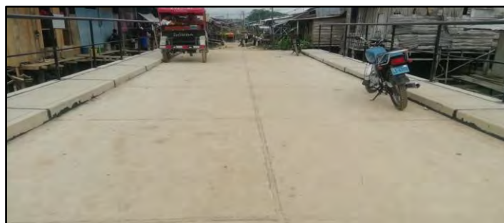
Imagen 93: Juntas Asfálticas En Pavimento Y Vereda Fuente: Propia
