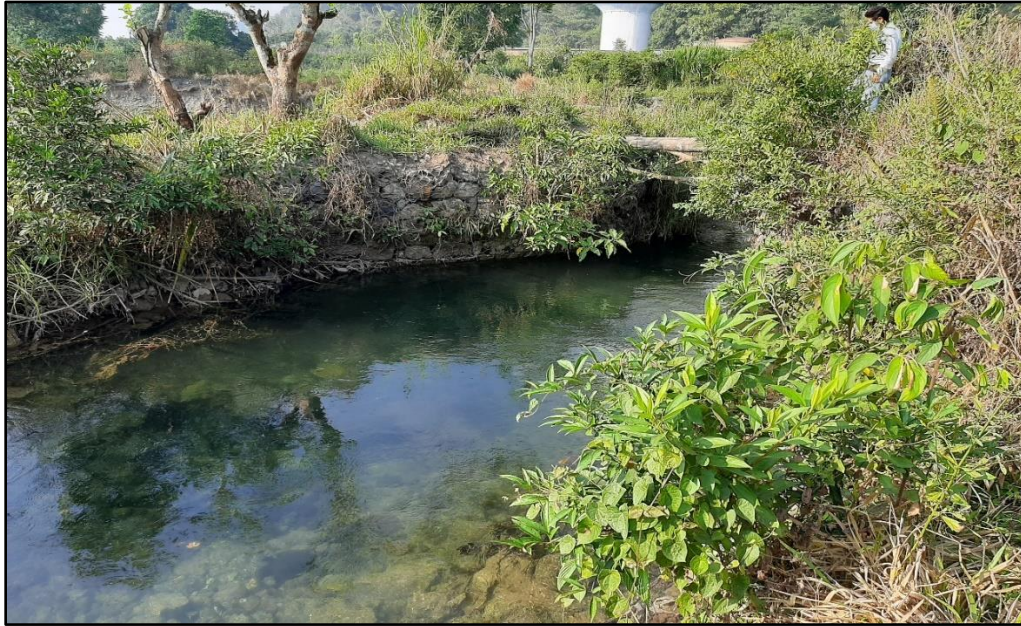
Foto 1: Se aprecia una sección inadecuada en el recorrido del canal Michuco, consecuencia de ello una distribución inadecuada del recurso hídrico.
