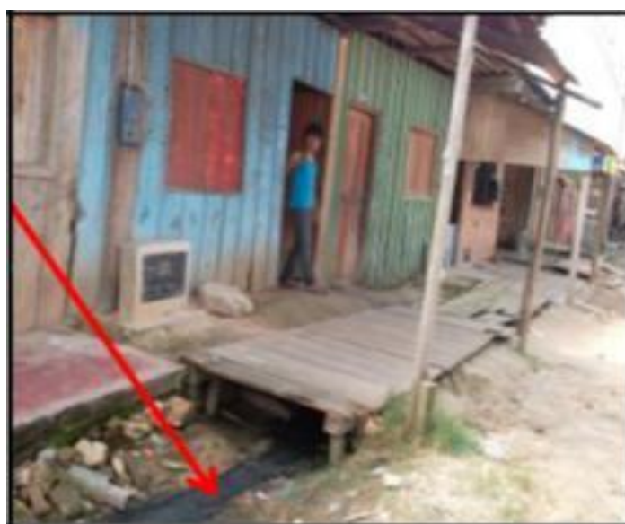
Foto N° 3. Canal Existente Colmatadas con Aguas Servidas Provenientes de los Desagües que generan las Viviendas en el Sector.
