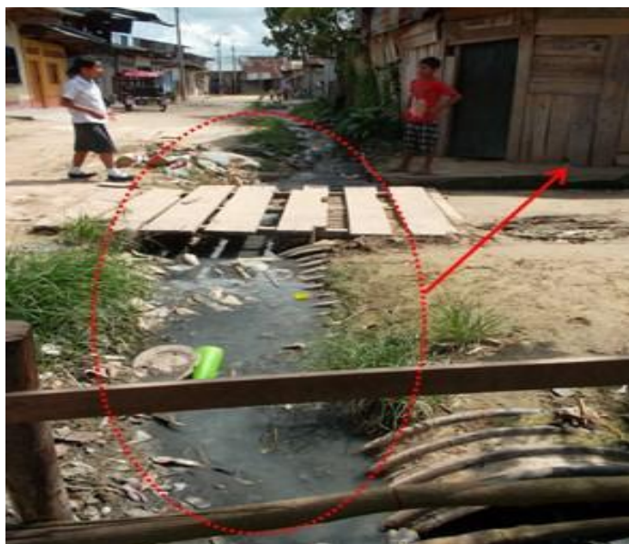
Foto N° 2. Canal Existente Colmatadas con Aguas Servidas Provenientes de los Desagües que generan las Viviendas en el Sector.
