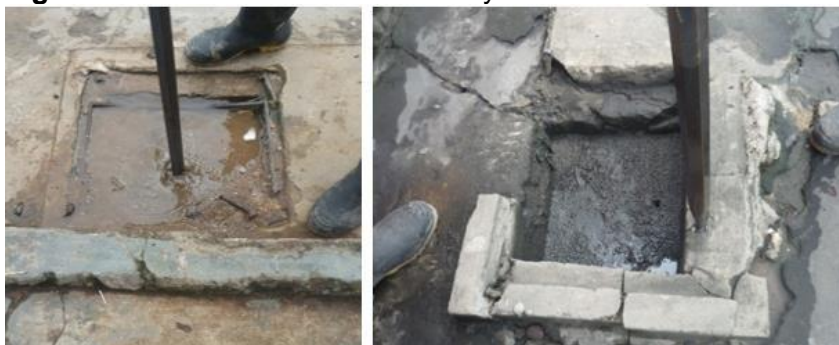
Figura 08: Acumulación de basuras y sedimentos
