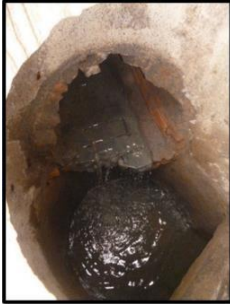
Figura 07: Deterioro de paredes de ladrillo y bases de mortero de las Gambotas
