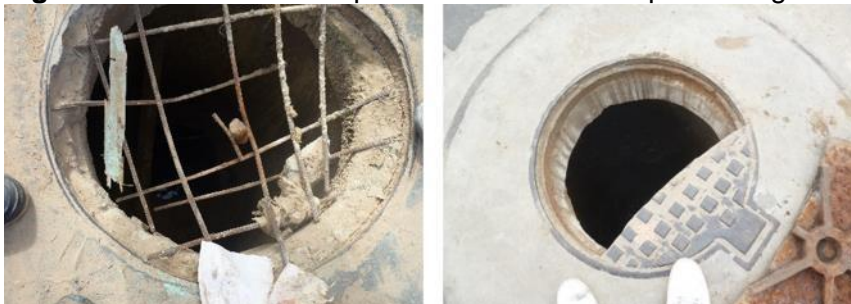
Figura 10: Buzones de inspección carentes de tapas de registro
