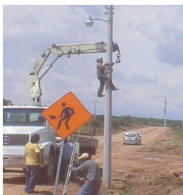
Figura 34: Reubicación de Postes de Concreto
