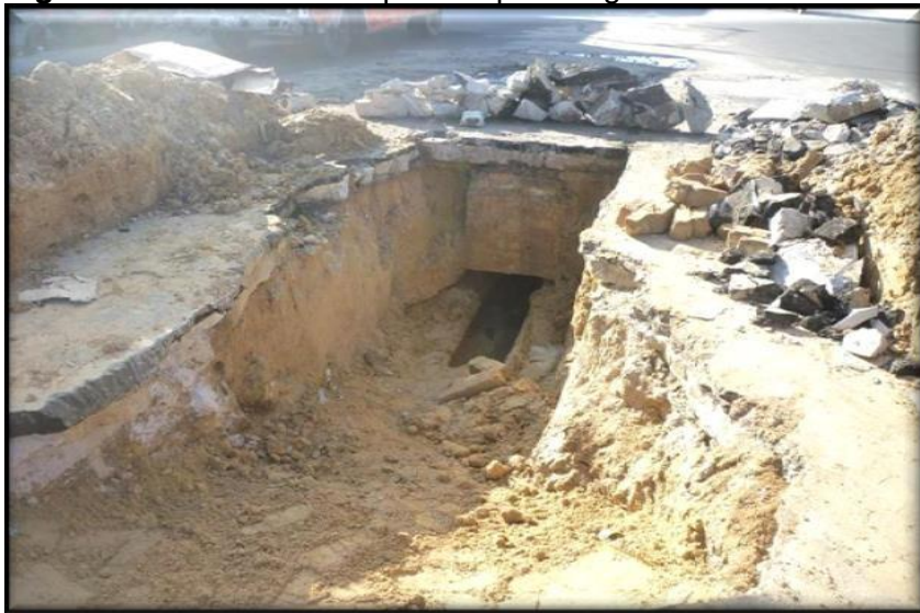
Figura 06: Gambotas colapsadas por antigüedad
