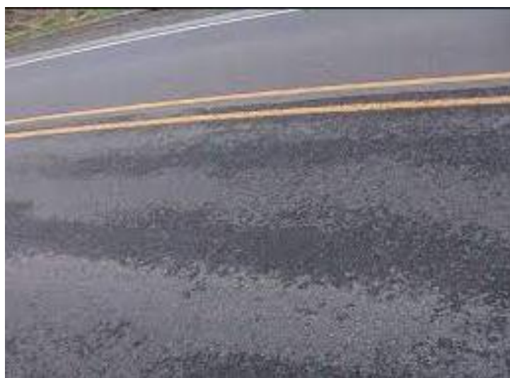
Ilustración 13: Exudación en pavimento rígido
