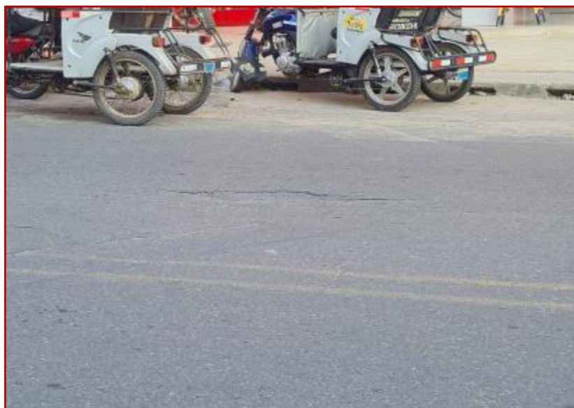
Ilustración 49: Testigo de defectos en el pavimento flexible – Cuadra 5
