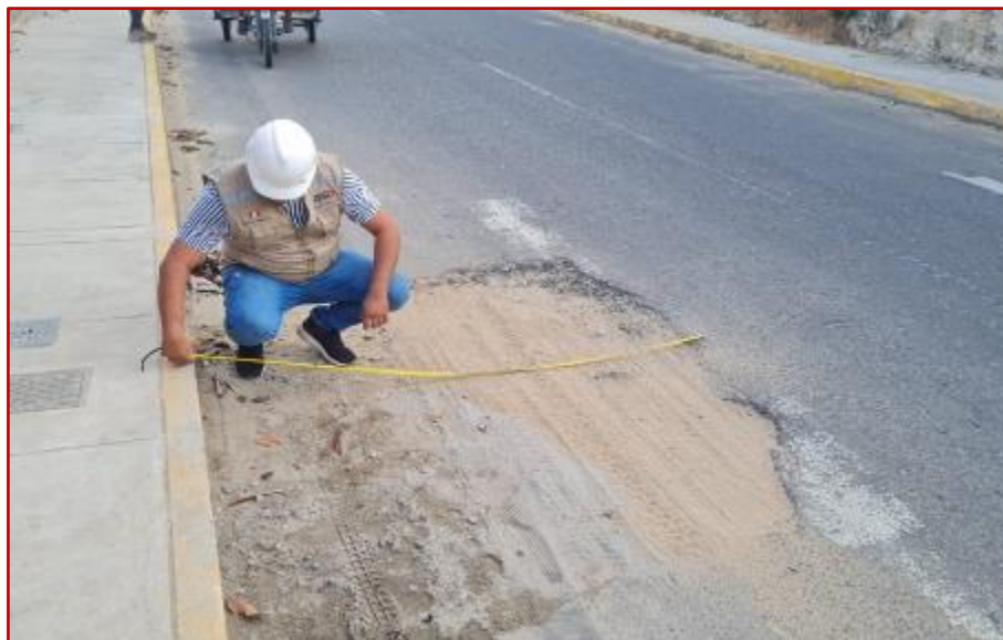
Ilustración 51: Testigo de defectos en el pavimento flexible – Cuadra 6
