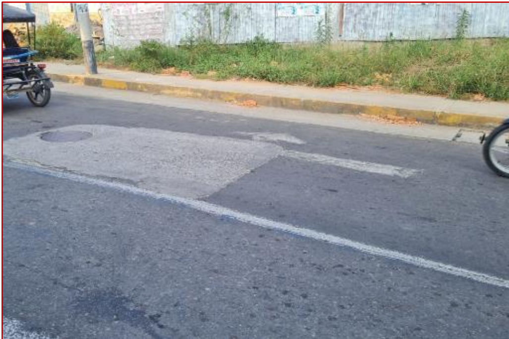
Ilustración 62: Testigo de defectos en el pavimento flexible – Cuadra 11
