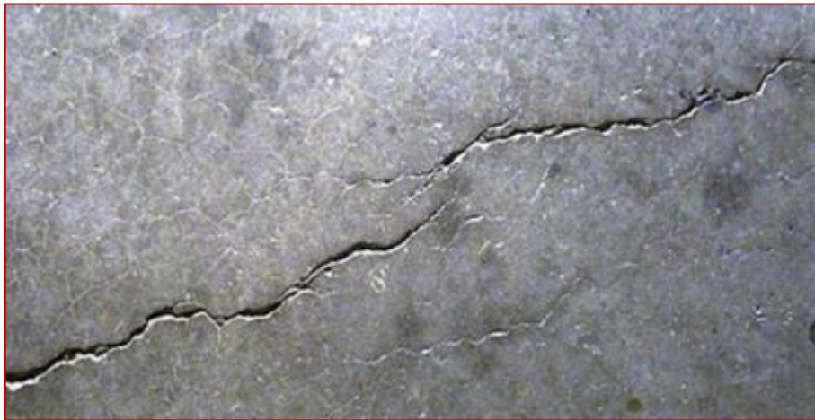
Ilustración 8: Grietas por Contracción
