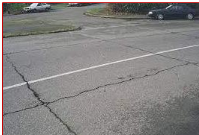
Ilustración 9: Grietas por Reflexión
