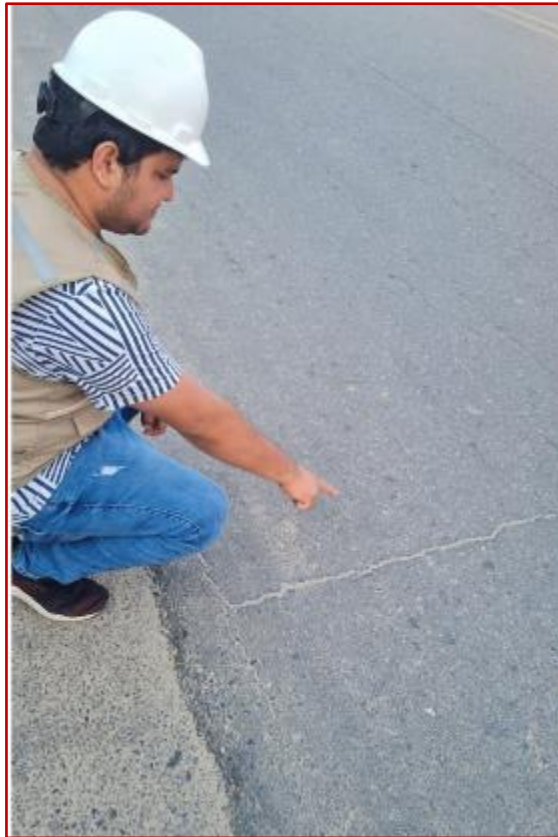
Ilustración 20: Desnivel carril – berma
