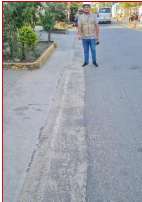
Ilustración 66: Testigo de defectos en el pavimento flexible – Cuadra 13
