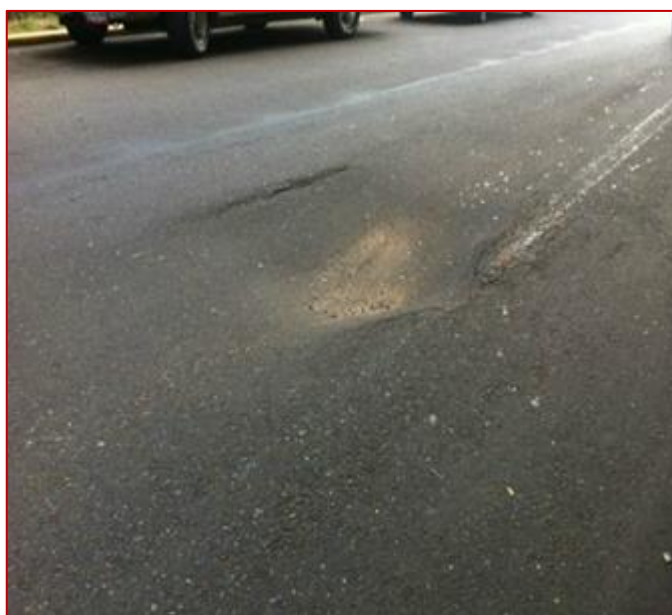
Ilustración 15: Abultamientos y Hundimientos en el pavimento flexible
