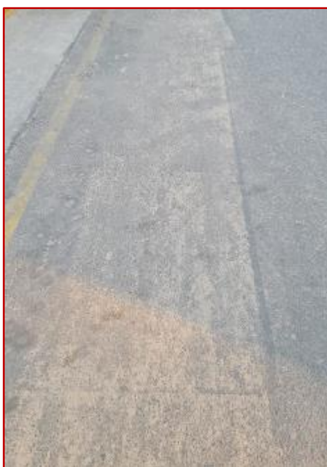
Ilustración 58: Testigo de defectos en el pavimento flexible – Cuadra 9
