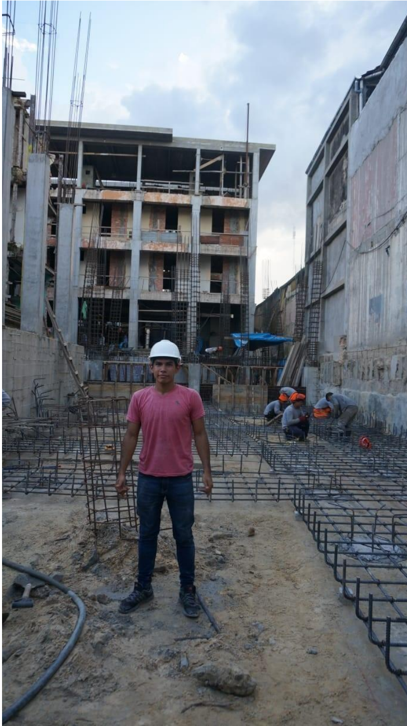
Armado de Zapatas corridas sobre anclaje de pilastras de concreto. Alex Saavedra presente en el proceso.
