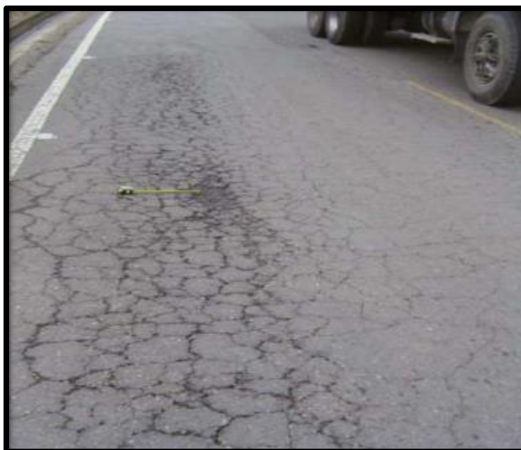
Ilustración 7: Fisura de Piel de Cocodrilo
