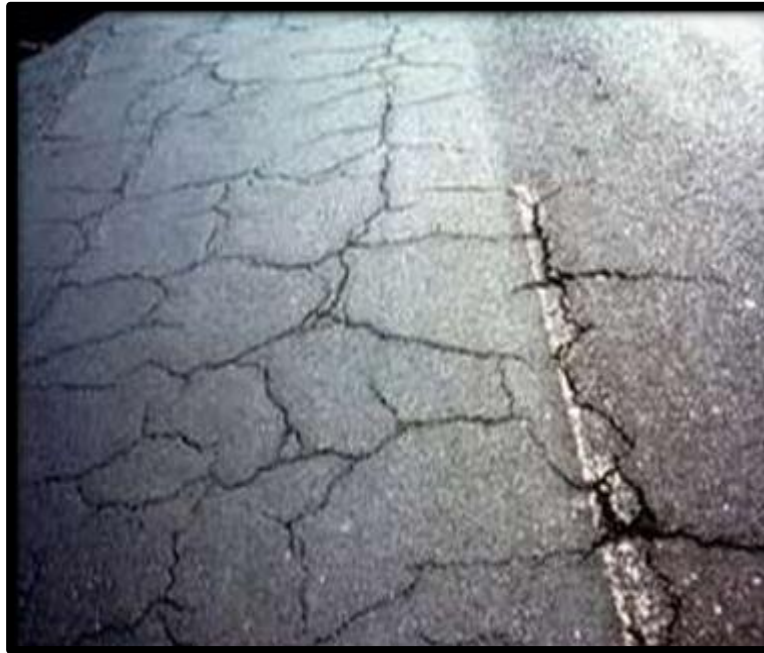
Ilustración 6: Fisura en Bloque
