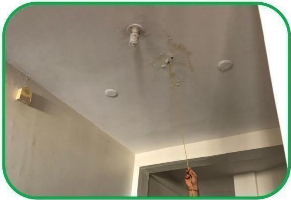
Identificación de manchas en los techos por presencia de humedad.
