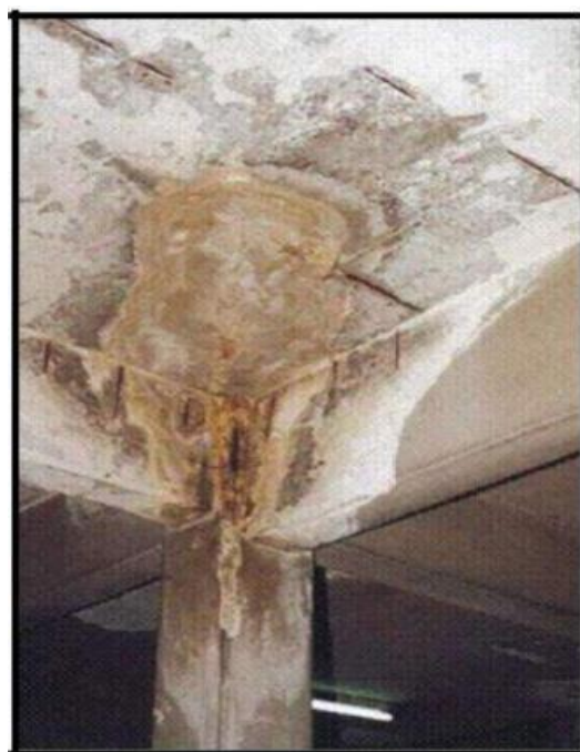
Figura 19: Perdida de sección de acero útil
