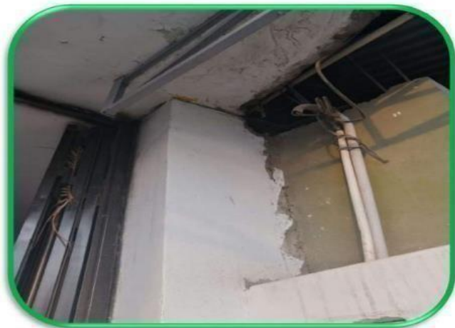
Identificación de manchas por humedad.
