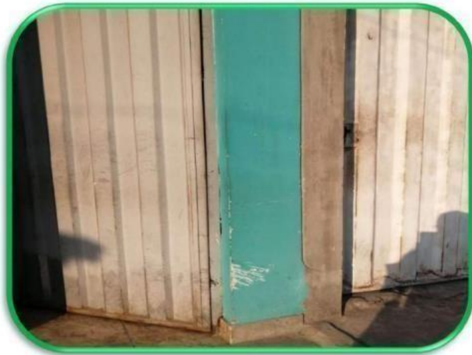
Podemos apreciar fisuras en las columnas.
