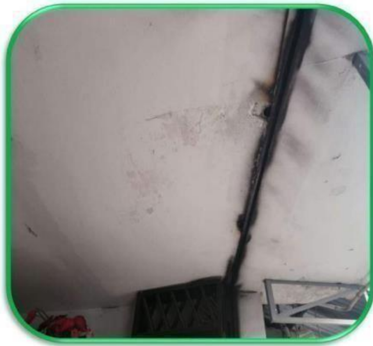
Se puede apreciar el acero oxidado (perdida útil del área del acero)
