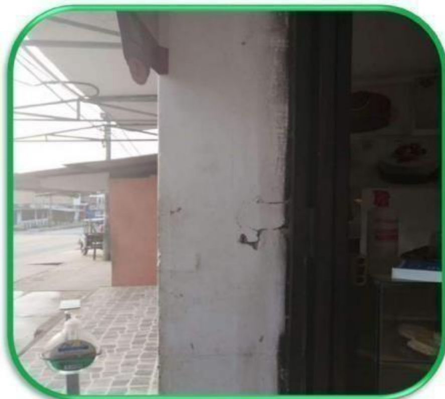
Identificación de grietas.
