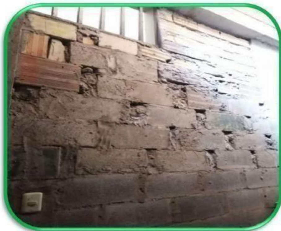
Podemos visualizar desprendimiento del concreto.
