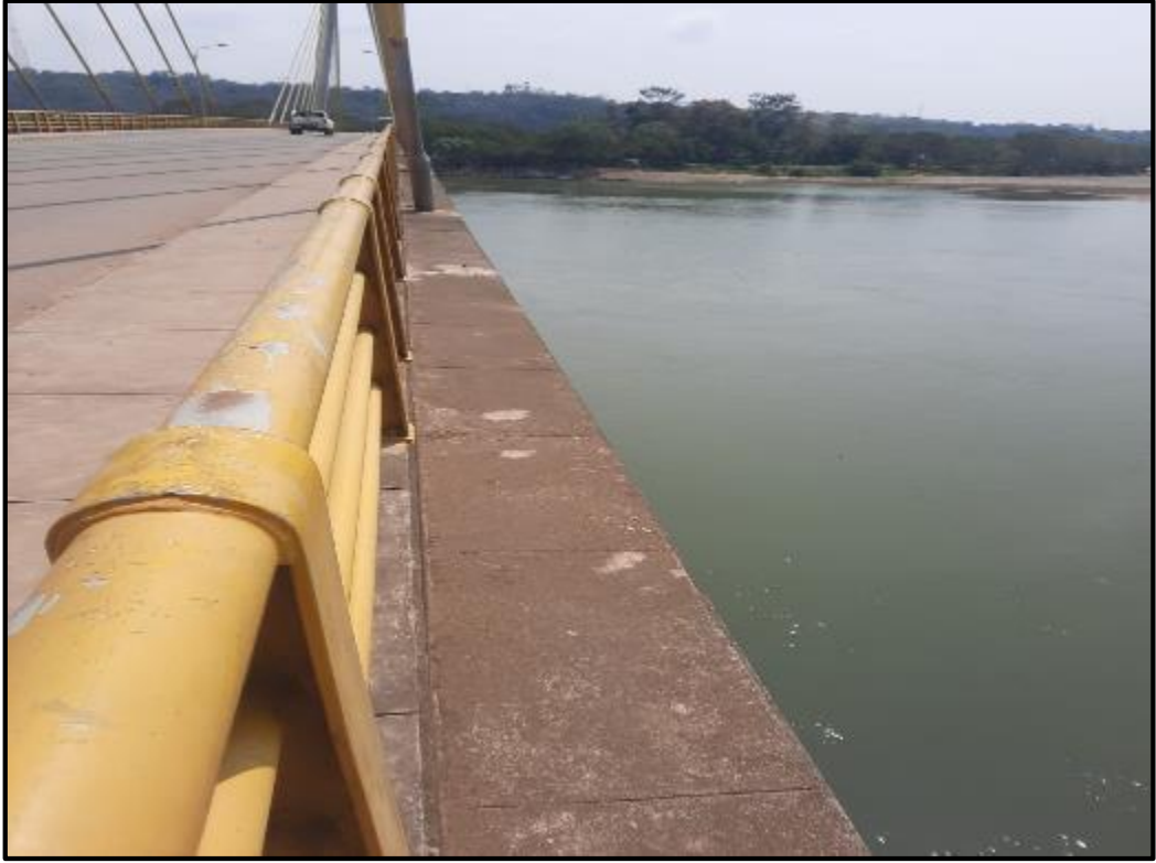
Foto N° 25: Se aprecia desgaste de pintura en barandas del puente margen derecha.
