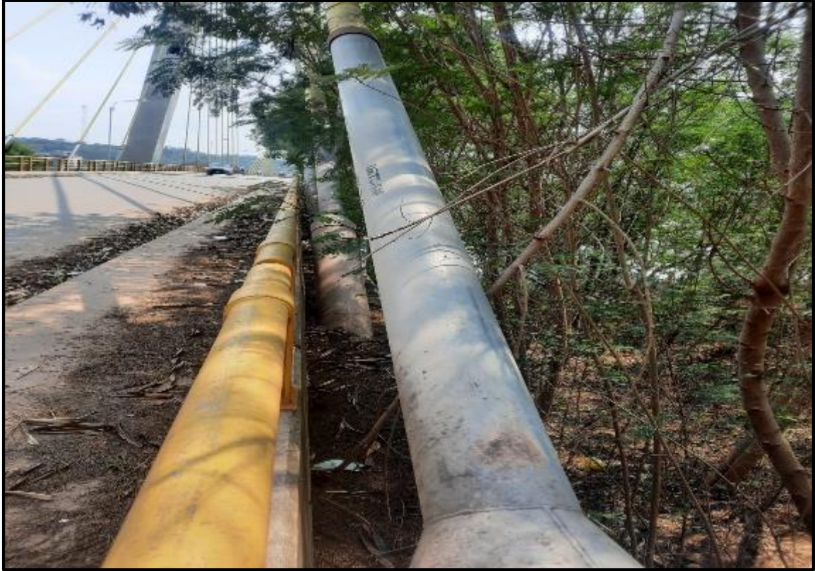
Foto N° 19: Se aprecia desgaste de pintura en las barandas y basura en donde se sostienen los cables de acero, margen derecha.
