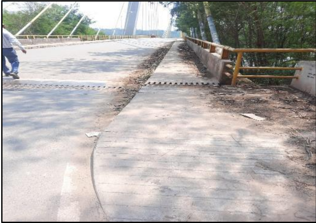
Foto N° 15: Se aprecia las veredas del puente en buen estado, faltaría una limpieza, margen derecha.
