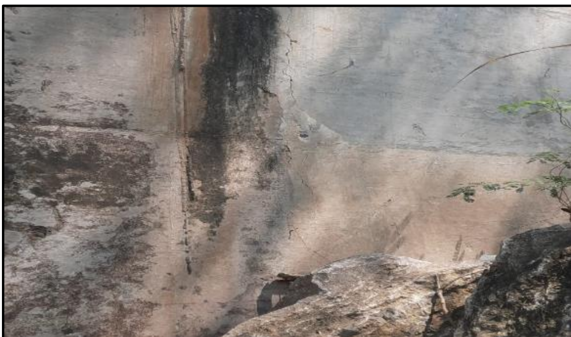
Foto N° 56: Se aprecia fisura en el estribo del puente, margen izquierda.
