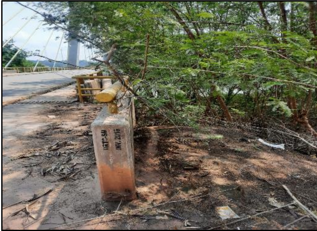
Foto N° 13: Se aprecia vegetación y basura en la margen derecha del puente.
