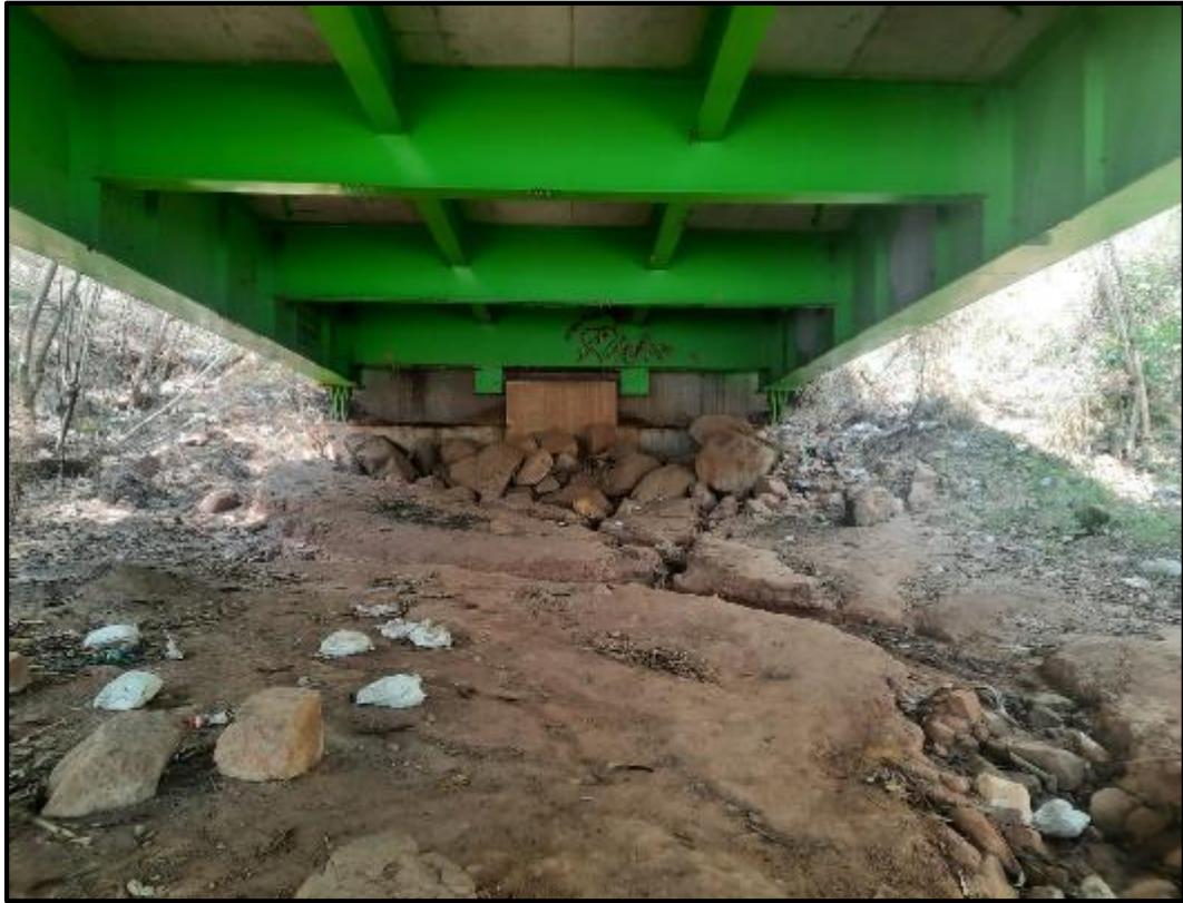
Foto N° 07: Falta limpieza en la cajuela, falta mantenimiento de los dispositivos de apoyo ya que están en contacto con el suelo, margen derecha.
