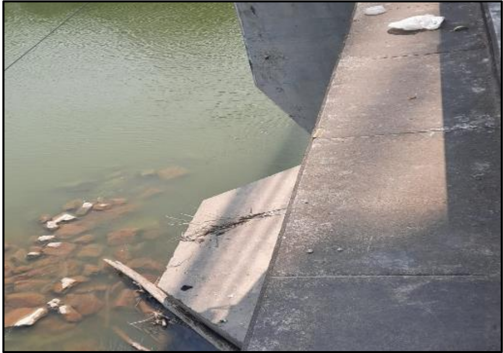
Foto N° 41: Se aprecia basura en el cimiento y también en la parte superior del puente, margen izquierda.
