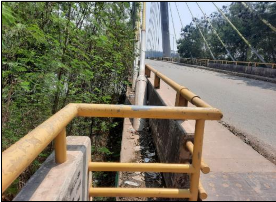
Foto N° 09: Se aprecia basura en la margen izquierda del puente también desgaste de pintura en las barandas del puente.
