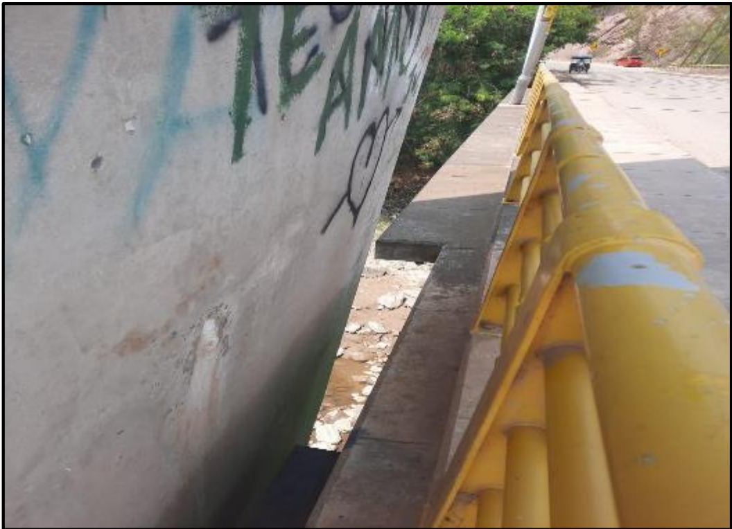
Foto N° 26: Se aprecia basura en conexión entre pilones y tablero margen derecha.
