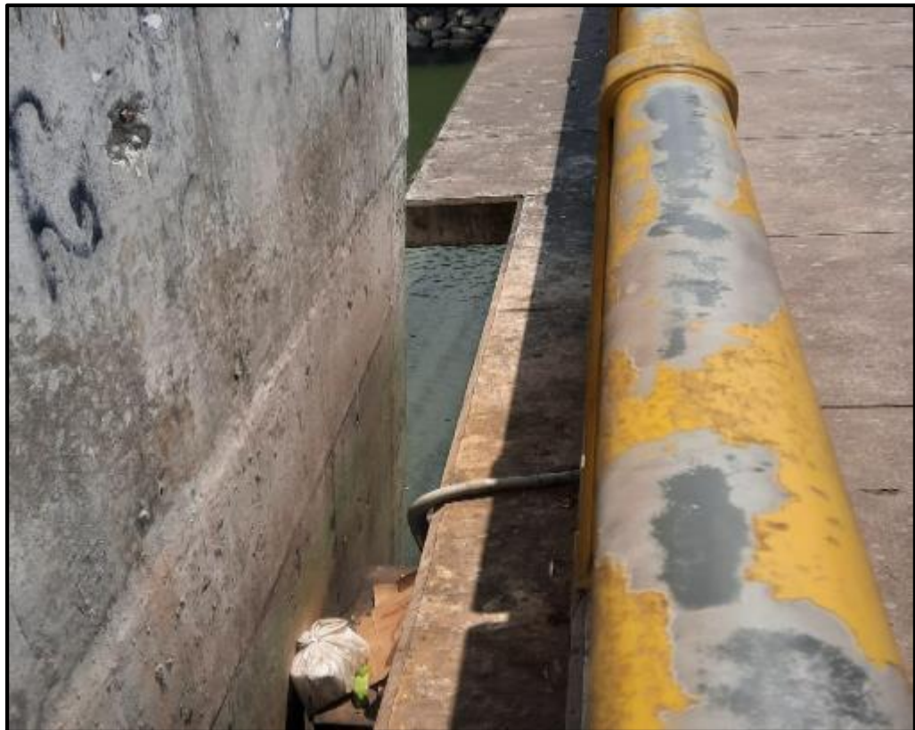
Foto N° 42: Se aprecia basura en la conexión del pilón con el tablero y desgaste de pintura en las barandas del puente, margen derecha.
