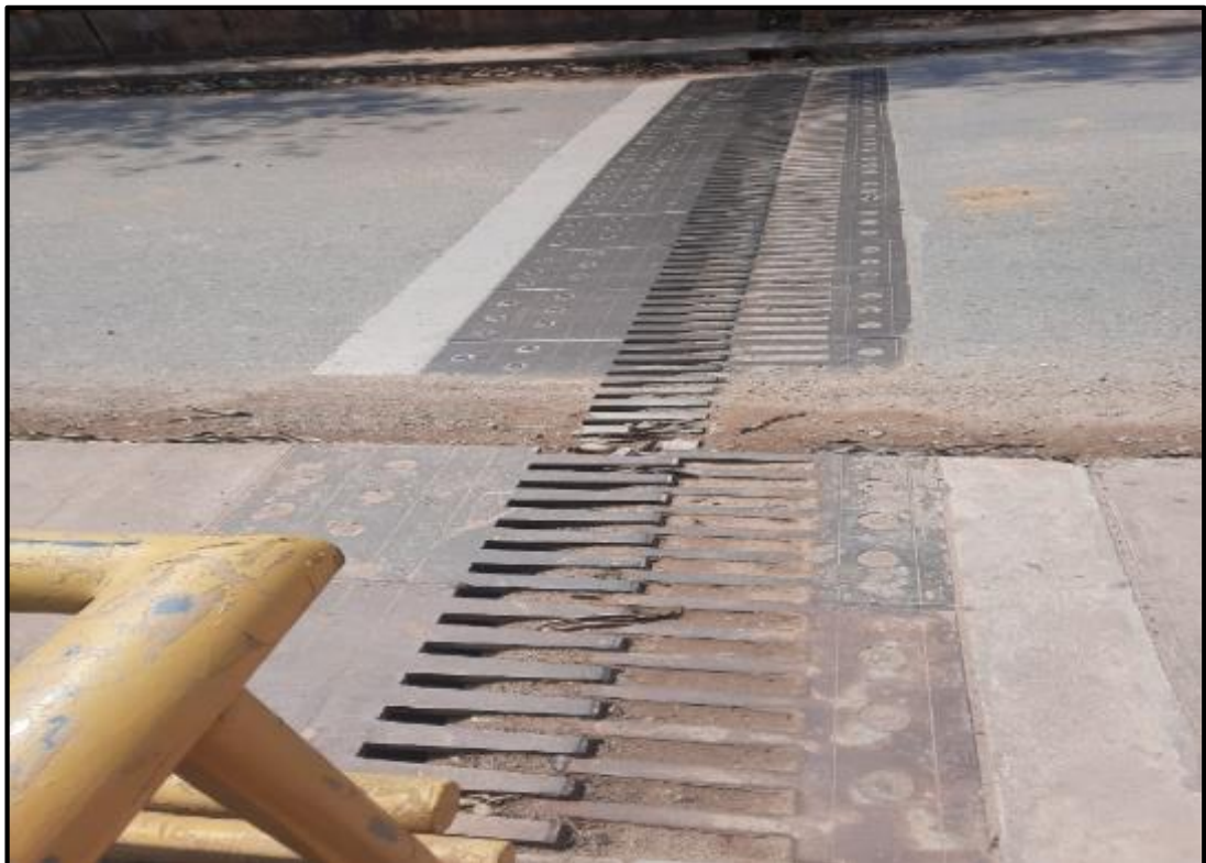
Foto N° 12: Se aprecia las juntas de dilatación del puente, falta mantenimiento en ambas márgenes.
