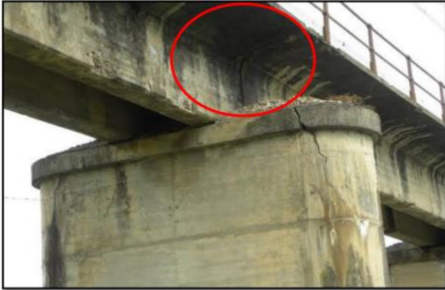
Ilustración 9: Eflorescencia en pilares y plataforma del puente
