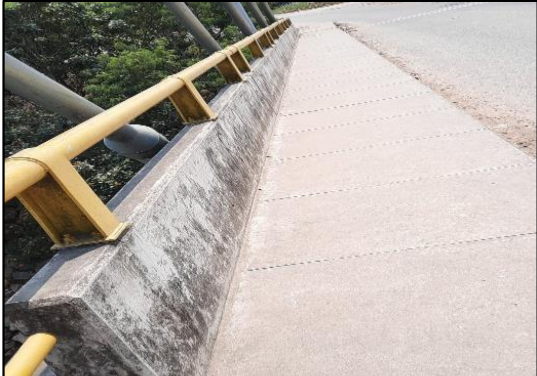
Foto N° 44: Se aprecia el parapeto del puente con desgaste de pintura margen izquierda.
