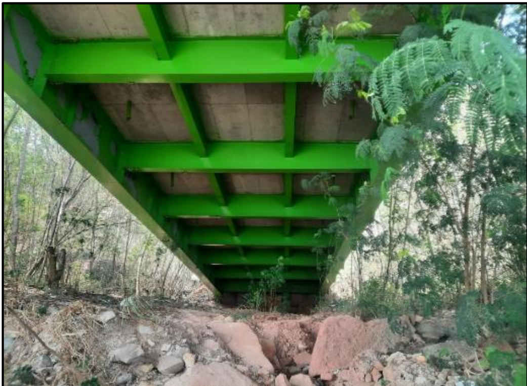
Foto N° 06: Se aprecia en la parte inferior vegetación y el sistema de drenaje en buen estado. Solo se empieza a deteriorar la pintura en las vigas longitudinales y diafragmas, margen derecha.
