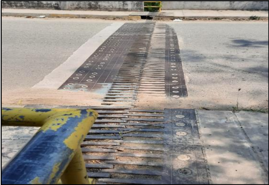
Foto N° 47: Se aprecia la junta de dilatación del puente, falta mantenimiento, margen izquierda.
