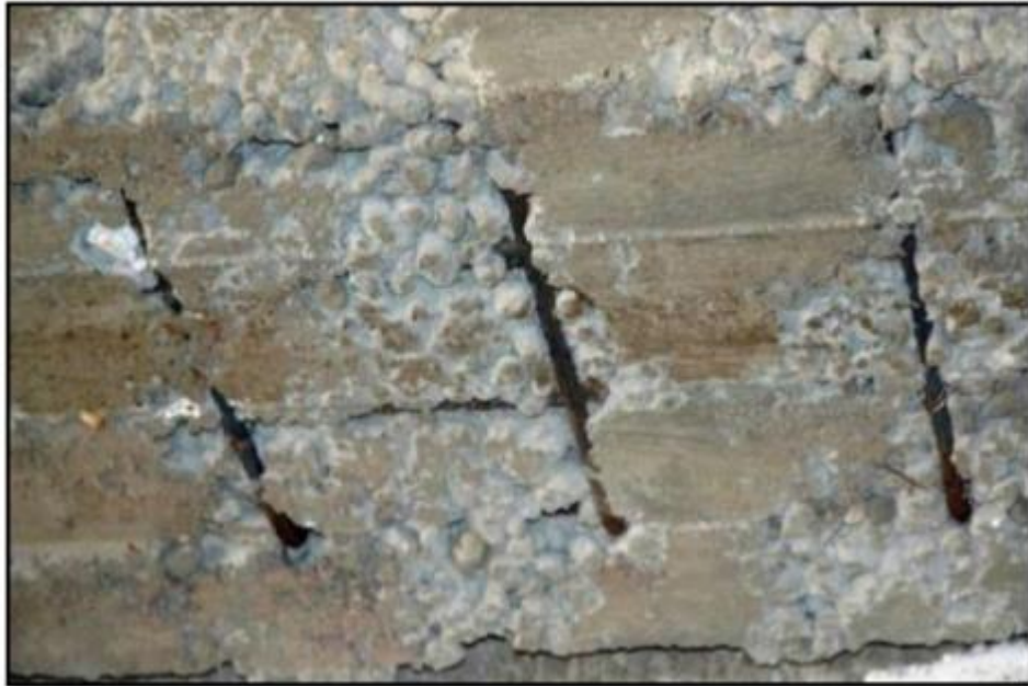
Ilustración 11: Segregación en losa armada
