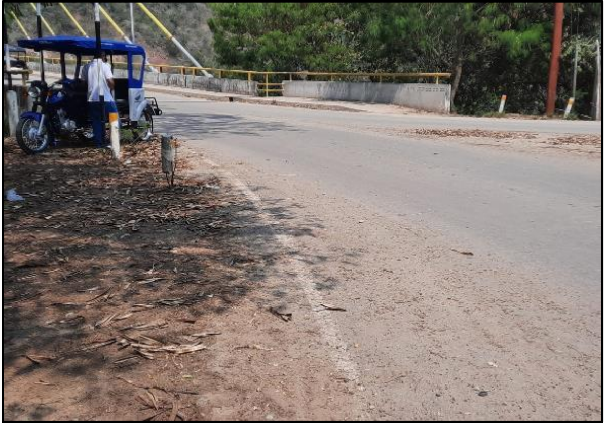
Foto N° 57: Se aprecia los delimitadores de vía en mal estado, margen izquierda.
