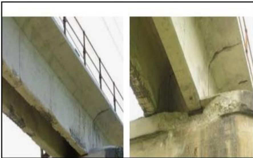
Ilustración 10: Cambio de Color del concreto en pilares y plataforma
