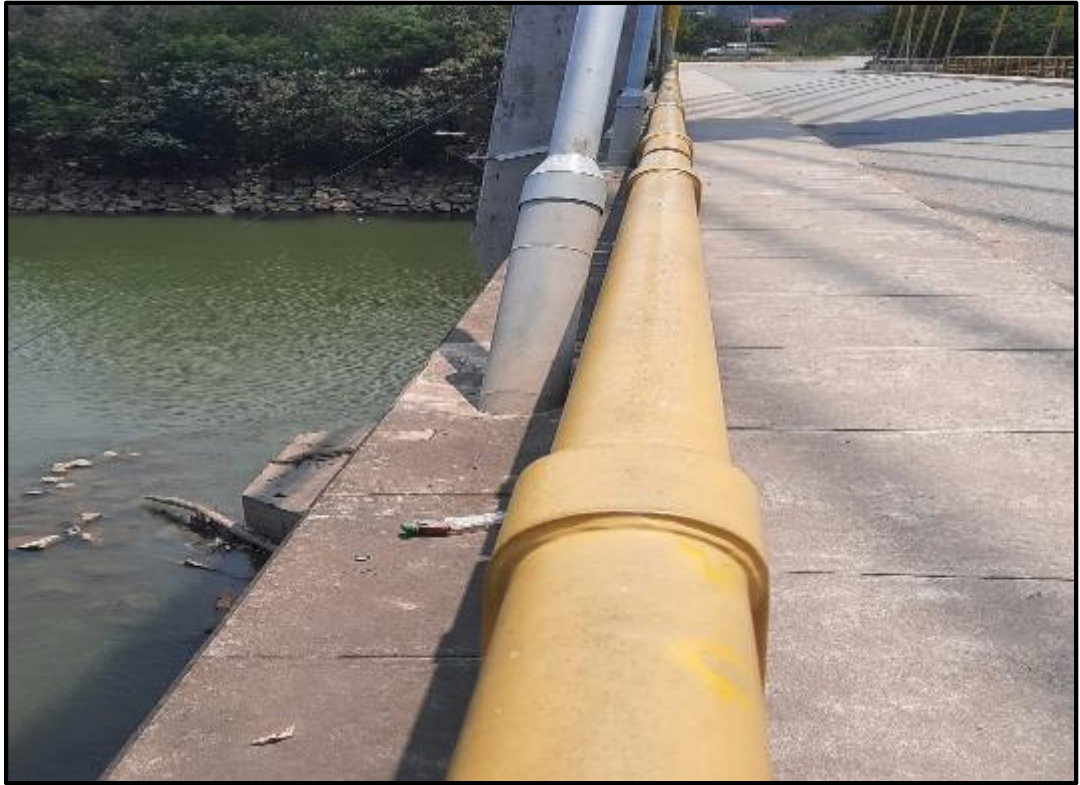
Foto N° 39: Se aprecia basura en la parte donde inicia la conexión de cables de acero.
