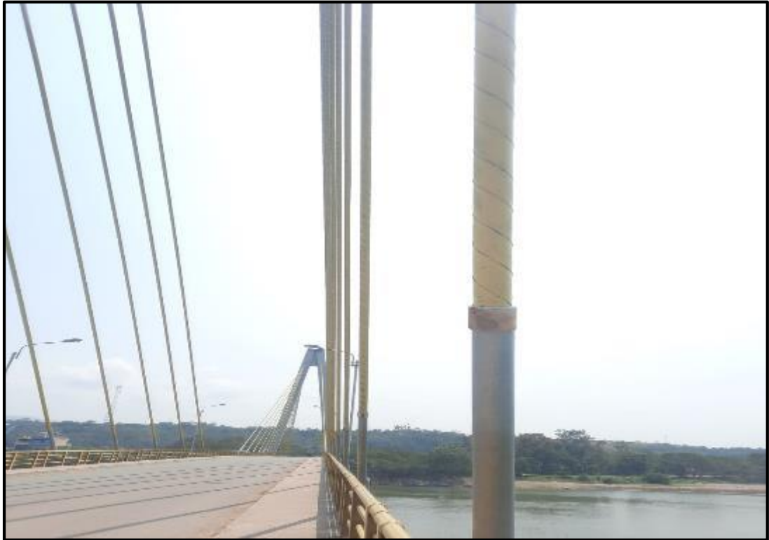
Foto N° 27: Se aprecia los protectores de cables de acero oxidados lado derecho.
