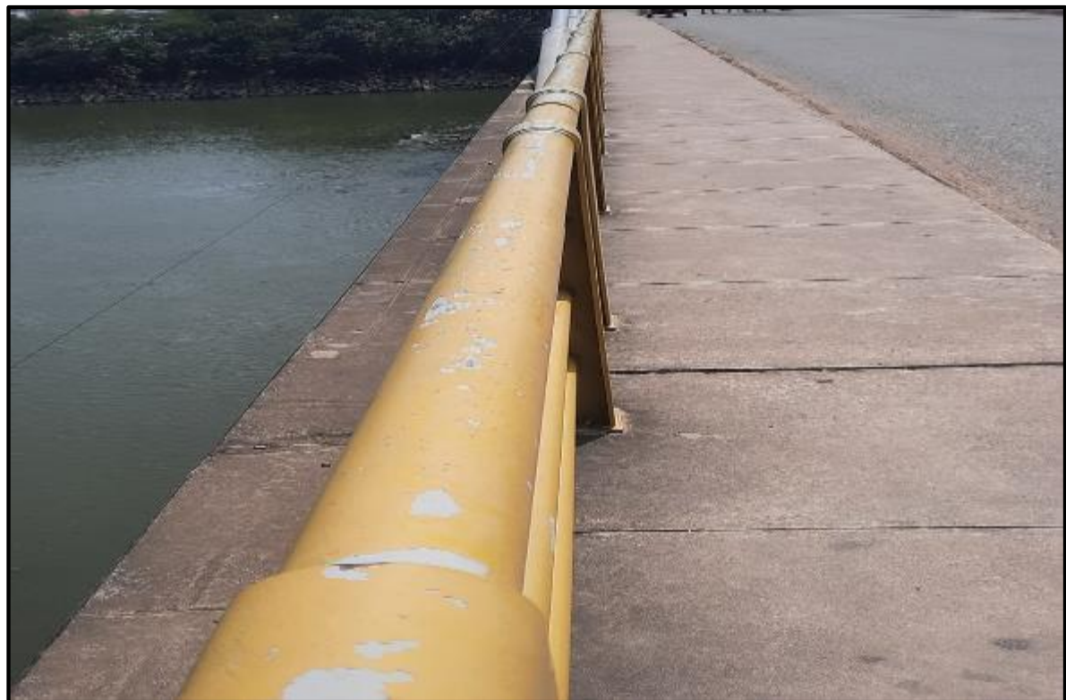
Foto N° 36: Se aprecia desgaste de pintura en las barandas del puente.
