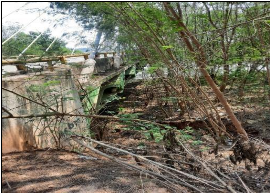
Foto N° 14: Se aprecia vegetación en la parte inferior del puente y basura en la parte del anclaje de los cables de acero, margen derecha.
