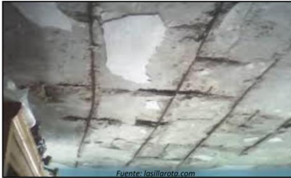
Ilustración 7: Desconchamientos losa de acercamiento
