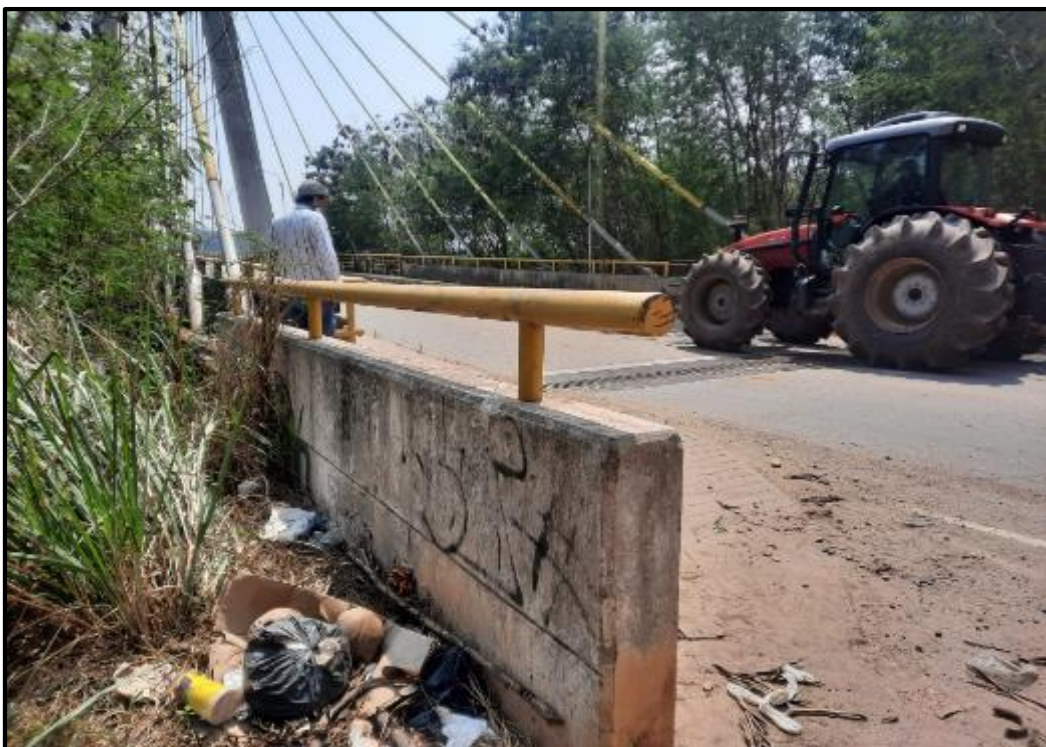
Foto N° 10: Se aprecia vegetación y basura a la margen izquierda del puente.
