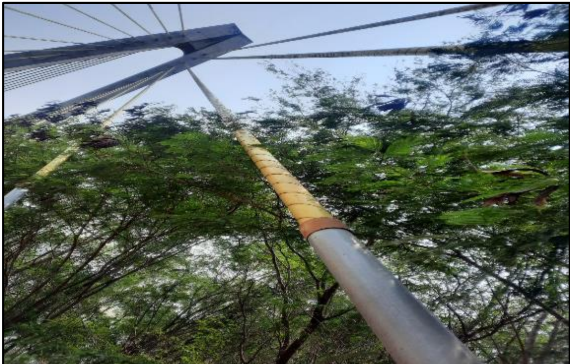
Foto N° 20: Se aprecia los protectores de cables de acero oxidados margen derecha.
