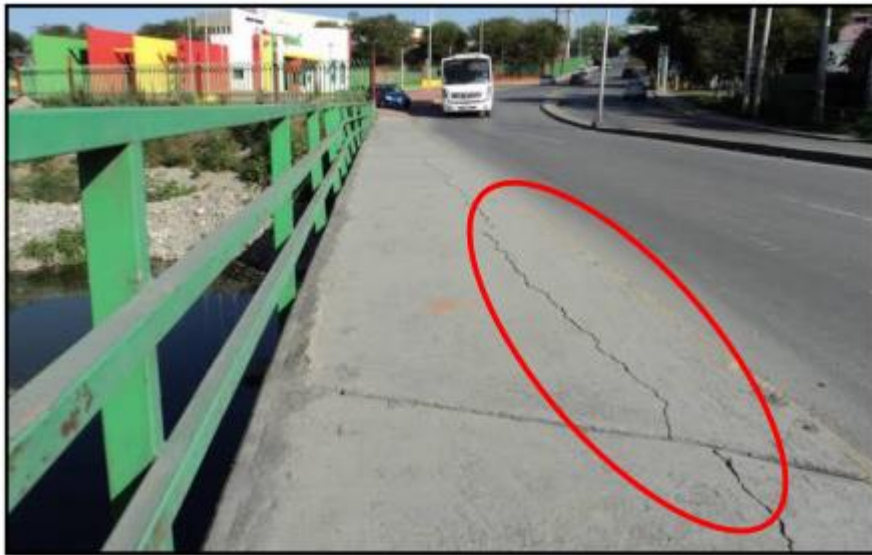
Ilustración 5: Fractura en losa de pavimento
