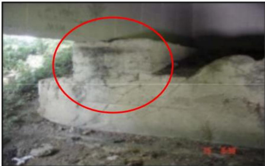
Ilustración 6: Aplastamiento en pilares
