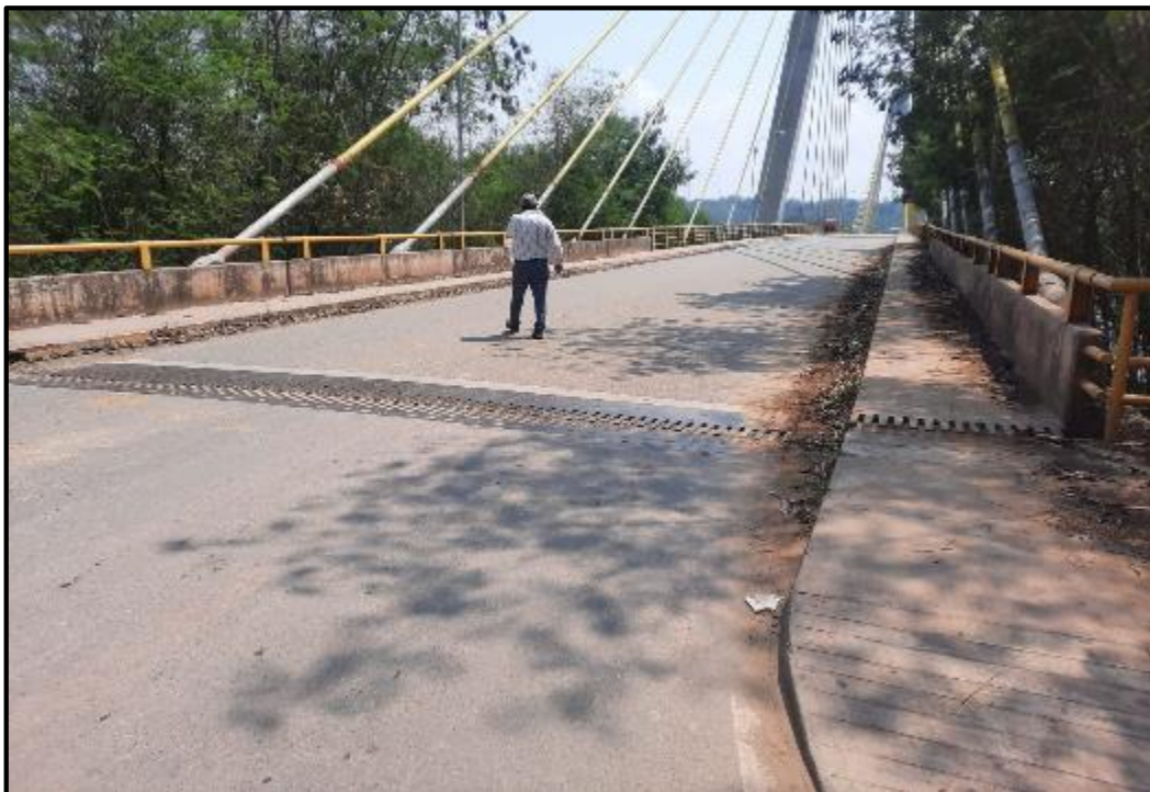
Foto N° 16: Se aprecia desgaste de pintura en las barandas de los parapetos del puente, veredas ambos lados en buen estado.
