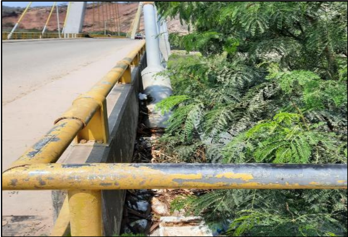
Foto N°49: Se aprecia desgaste de pintura en barandas, basura y vegetación margen derecha.
