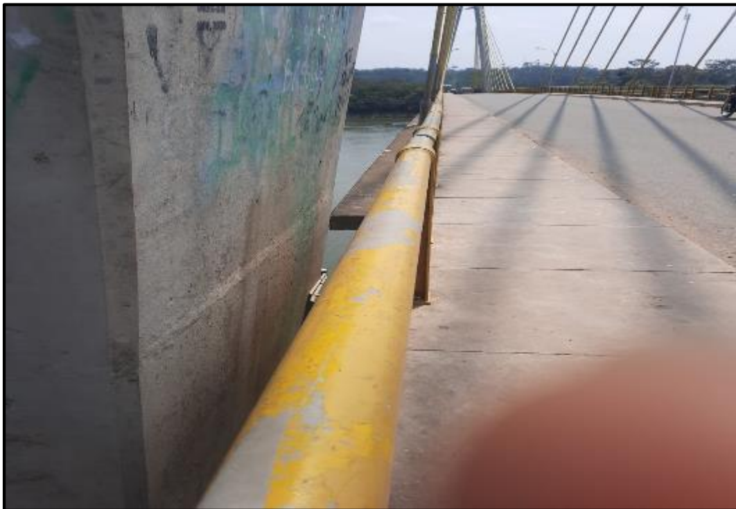
Foto N° 30: Se aprecia desgaste de pintura en las barandas del puente margen izquierda.
