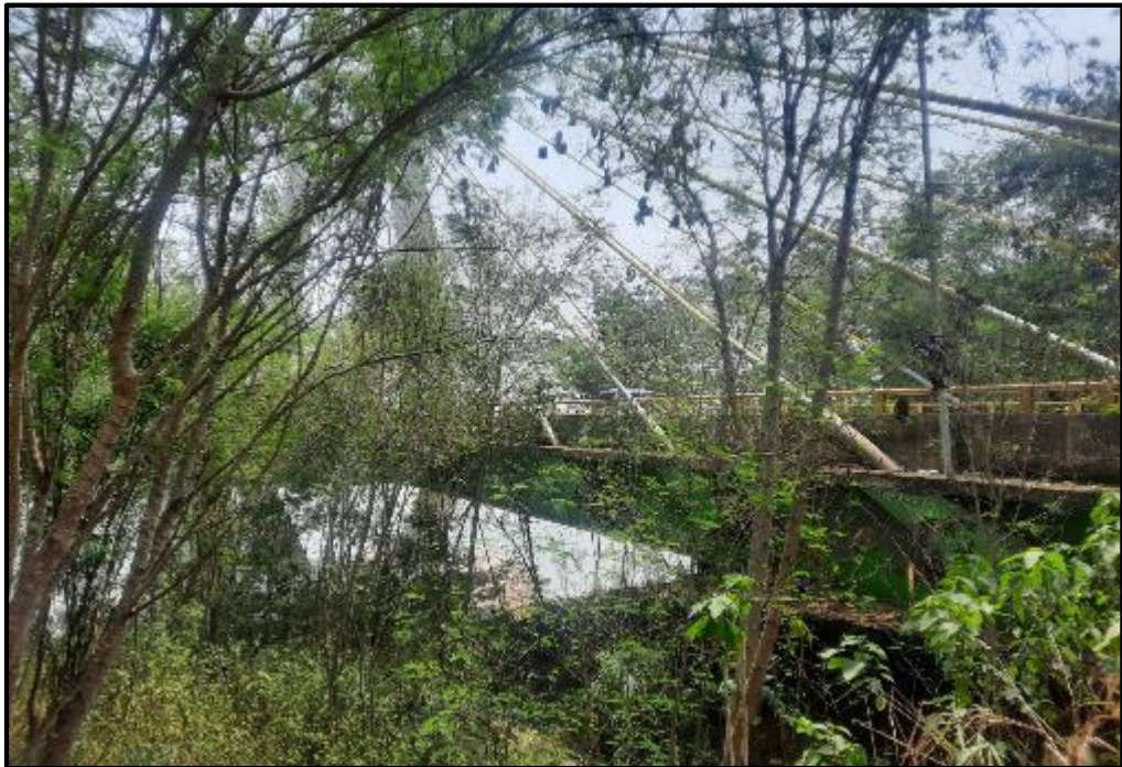
Foto N° 02: Se aprecia que el puente está cubierto por vegetación – margen derecha.
