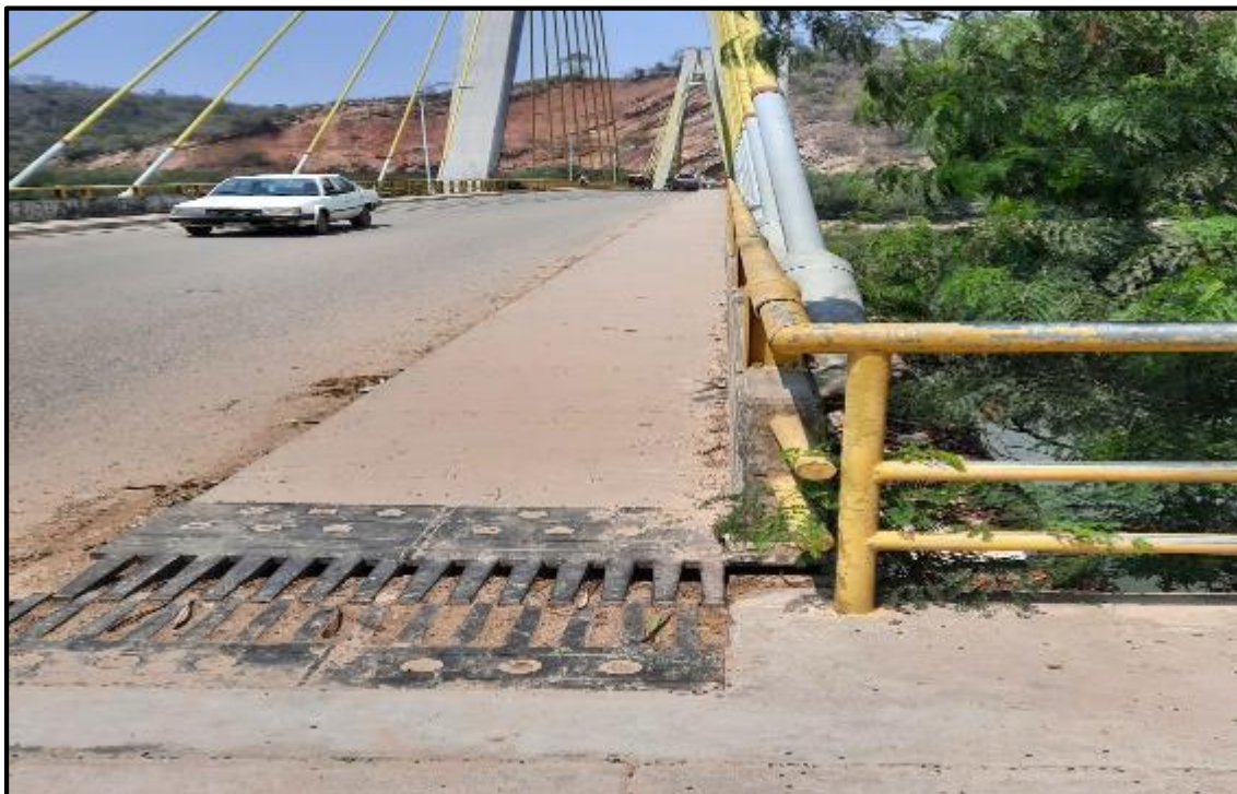
Foto N° 48: Se aprecia desgaste de pintura en las barandas del puente margen izquierda.
