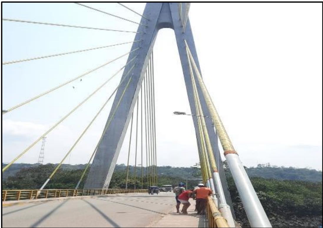
Foto N° 38: Se aprecia los protectores de cables de acero oxidados, pilotes en buen estado.
