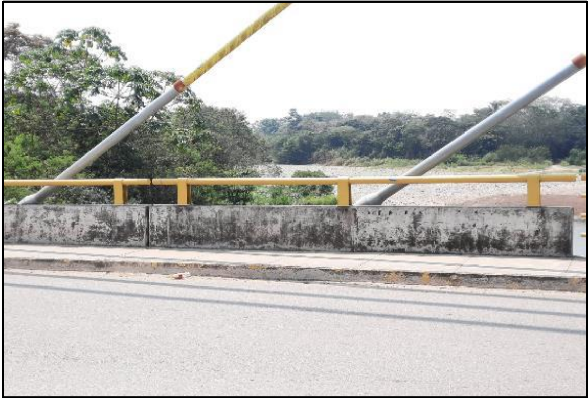
Foto N° 45: Se aprecia el parapeto del puente con desgaste de pintura.
