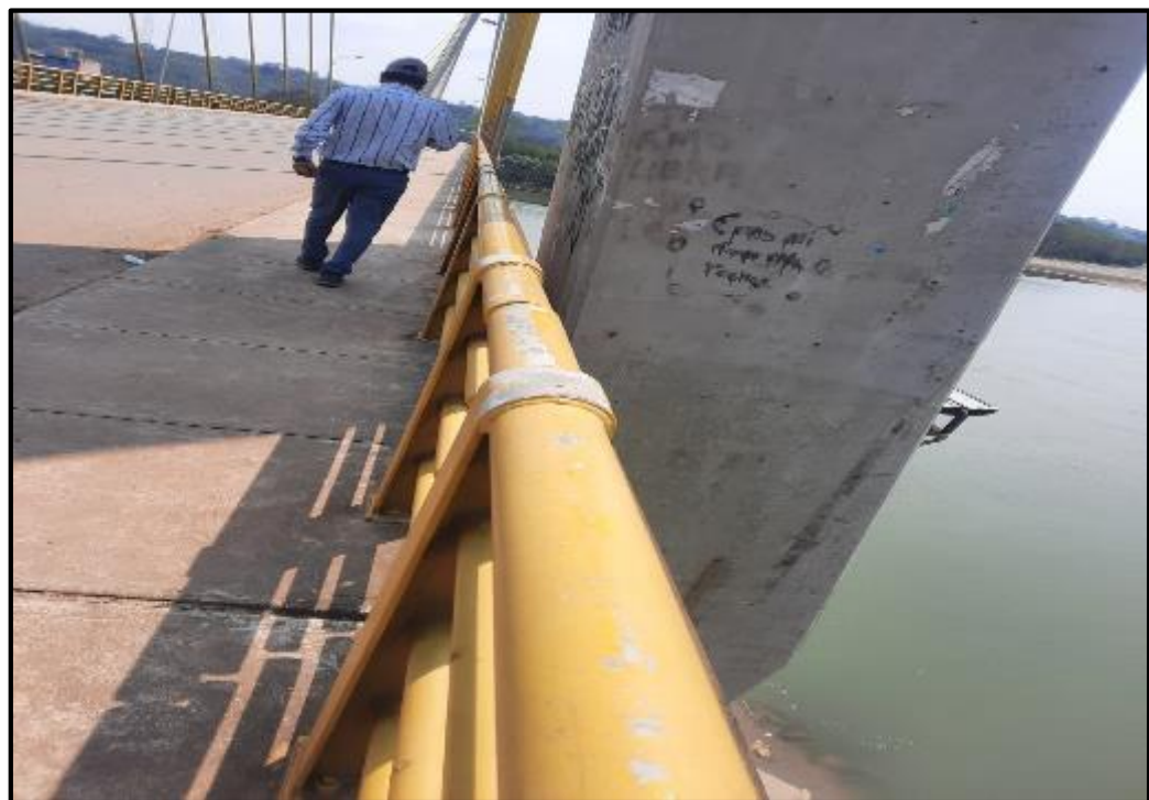
Foto N° 24: Se aprecia desgaste de pintura en barandas del puente margen derecha.
