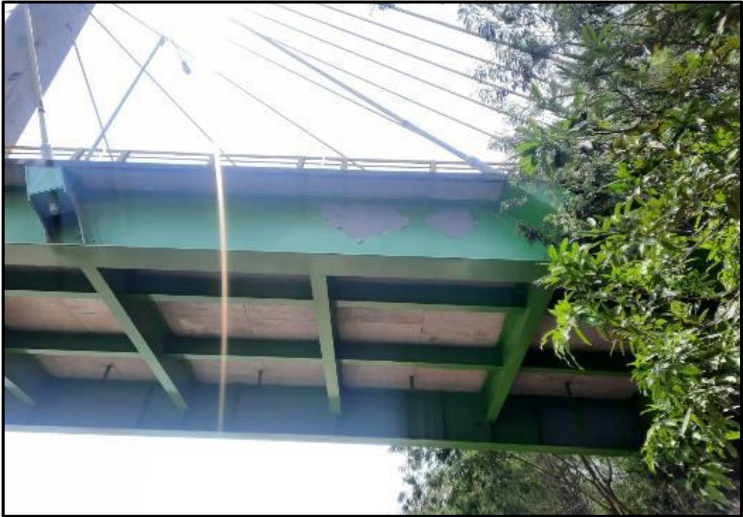
Foto N° 05: Se aprecia deterioro de la pintura en las vigas metálicas – margen derecha.
