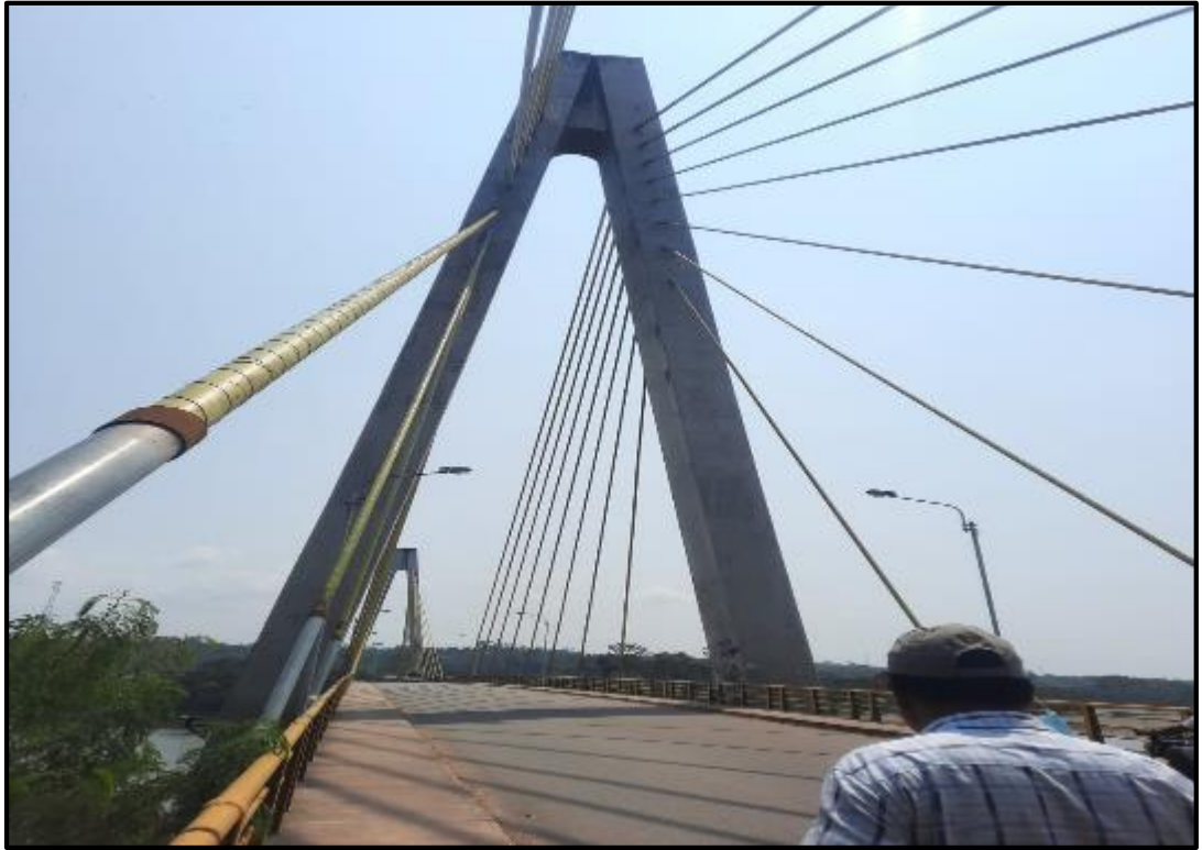
Foto N° 21: Se aprecia los protectores de cables de acero oxidados margen izquierda.
