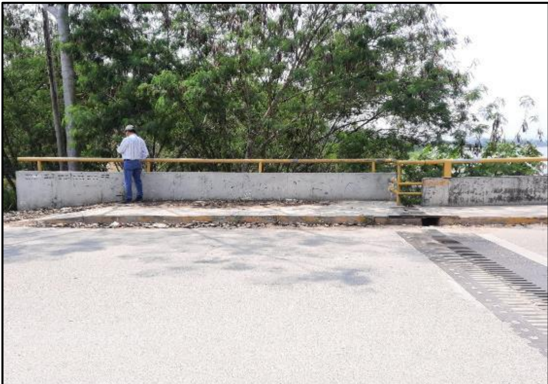
Foto N° 50: Se aprecia basura en la vereda del puente, desgaste de pintura en las barandas y parapeto margen izquierda.
