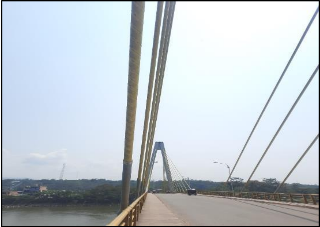
Foto N° 31: Se aprecia los protectores de cables de acero oxidados lado izquierdo.
