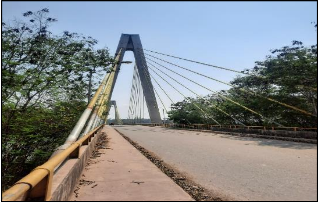
Foto N° 11: Se aprecia que los protectores metálicos de los cables de acero se están oxidando, margen izquierda.
