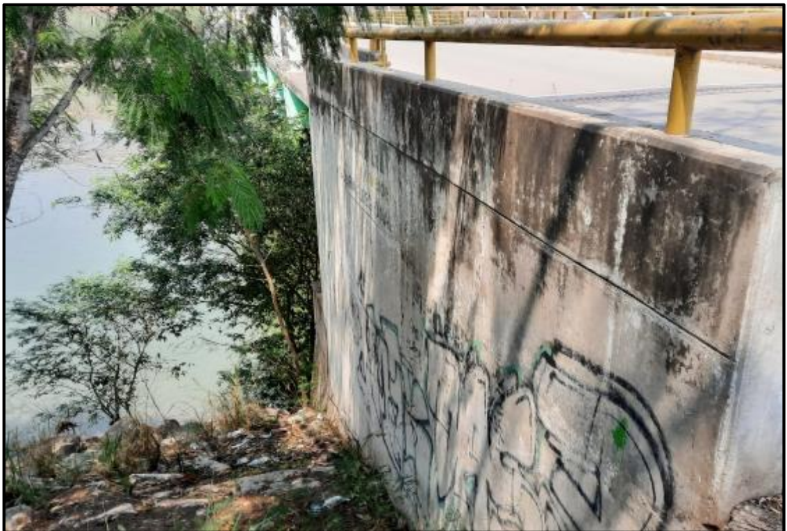
Foto N° 52: Se aprecia basura y vegetación en margen izquierda.
