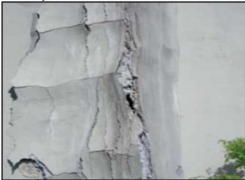
Ilustración 12: Cambio de color del concreto en pilares y plataforma
