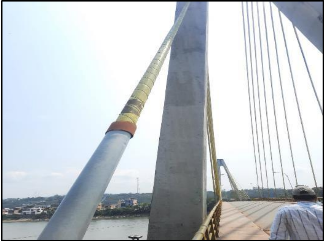
Foto N° 23: Se aprecia los protectores de cables de acero oxidados y desgaste de pintura margen derecha.
