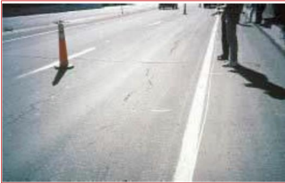
Figura 10: Piel de cocodrilo con nivel de severidad
