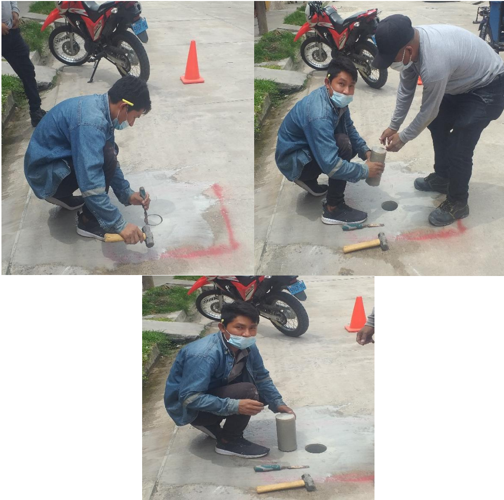
Imagen 15: Extracción del espécimen de concreto del E-22, realizado en la Cuadra 10 del Jr. Dos de Mayo.
