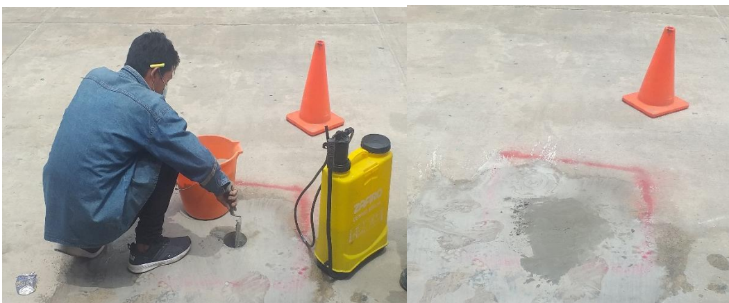
Imagen 16: Resanado de orificios con mortero del E-22, realizado en la Cuadra 10 del Jr. Dos de Mayo.
