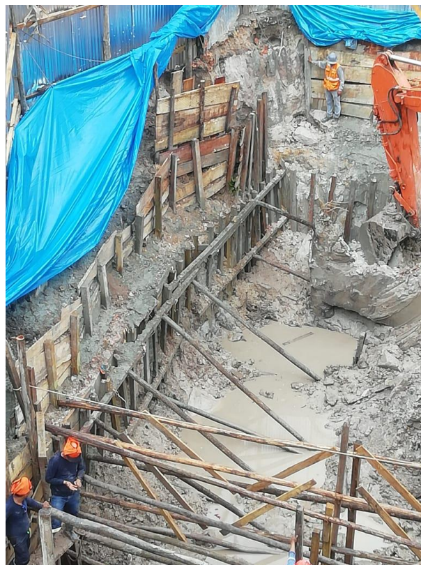
Foto 03 - Excavación profunda donde se aprecia el suelo con sus propiedades alteradas a causa de precipitaciones pluviales y o presencia de agua subterránea.
