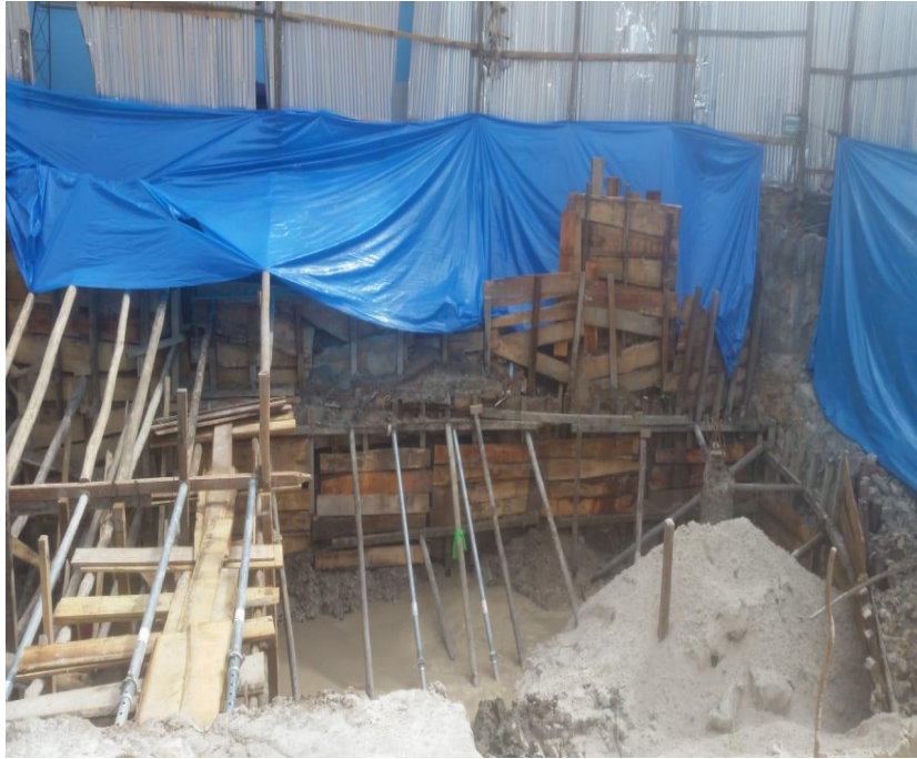
Foto 04 - Entibado que dificultaría trabajos posteriores durante la construcción de la cámara de bombeo pluvial
