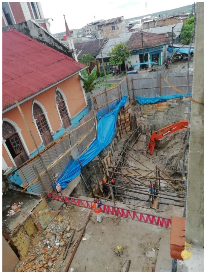
Foto 05 - Edificación adyacente que puede ser afectada con la falla del talud.
