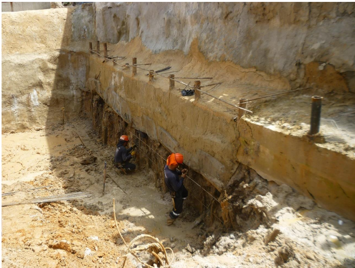
Foto 10 Plano de falla 2 estabilizado con el modelo propuesto.
