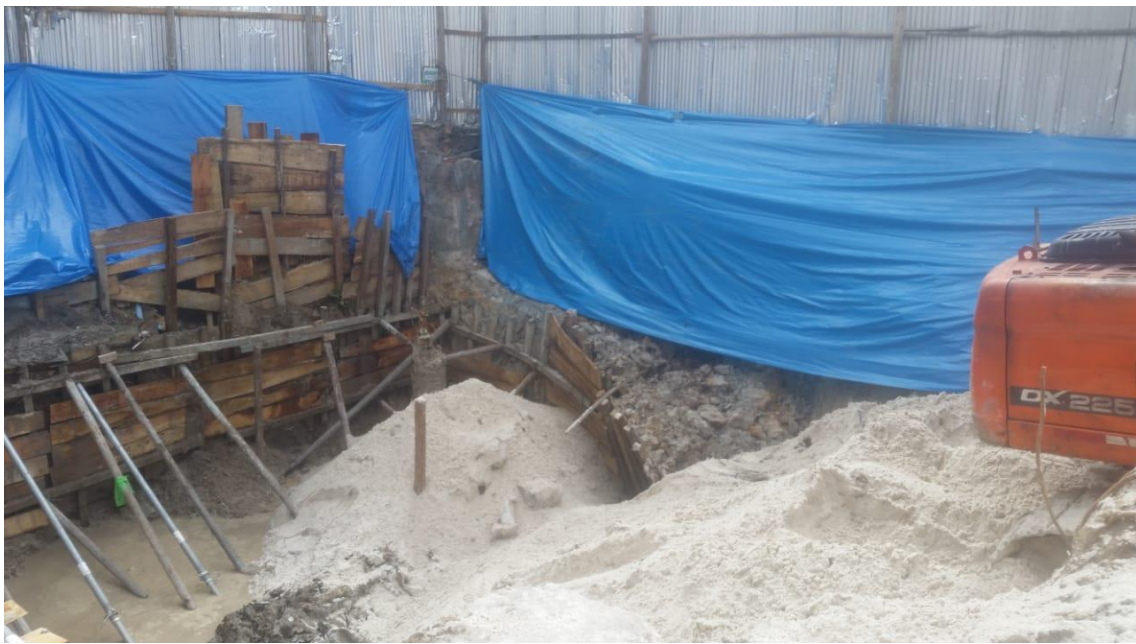
Foto 11 Estado inicial del Plano de falla 3.
