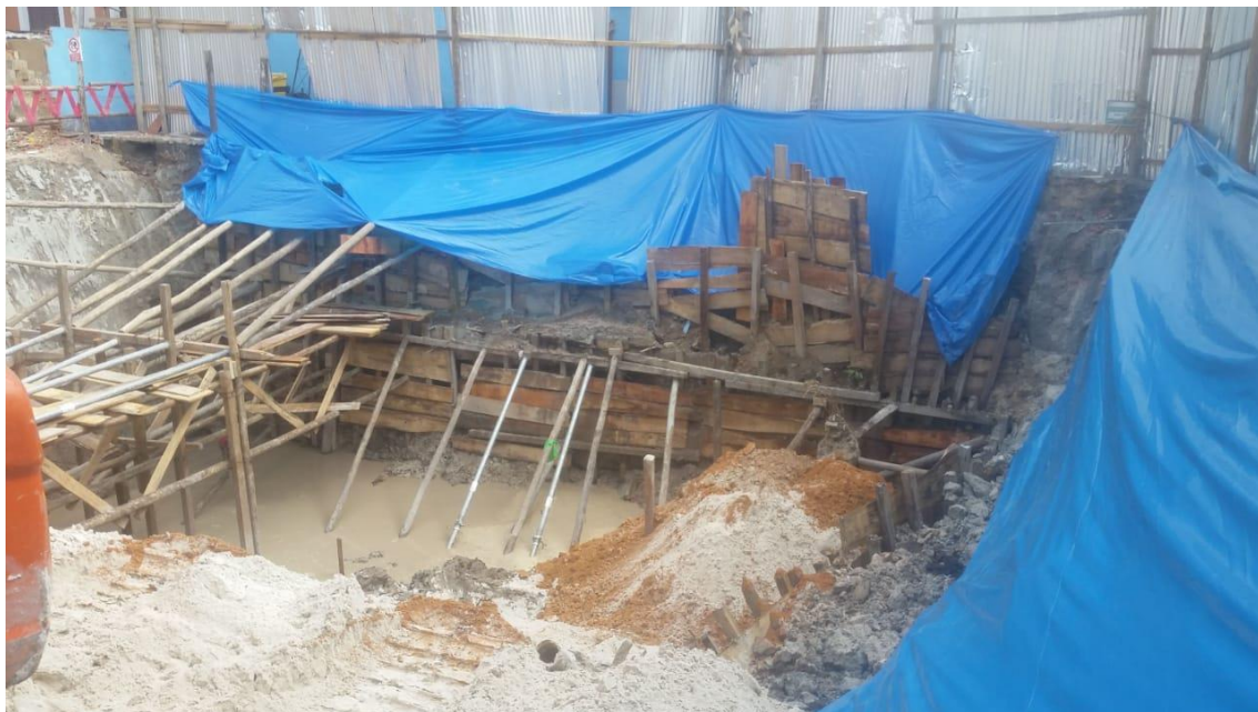
Foto 09 Estado inicial del Plano de falla 2.
