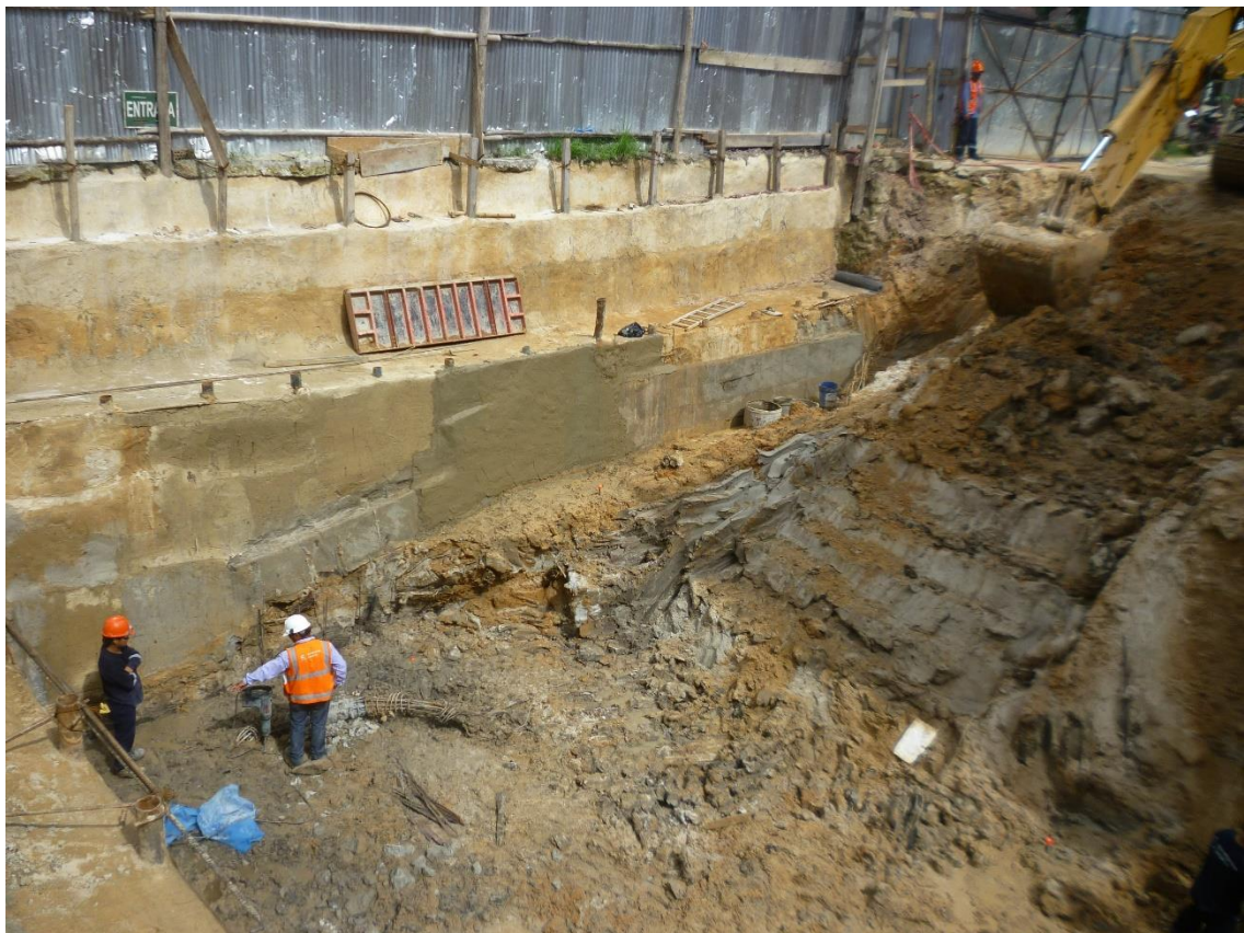
Foto 14 Plano de falla 4 estabilizado con el modelo propuesto.
