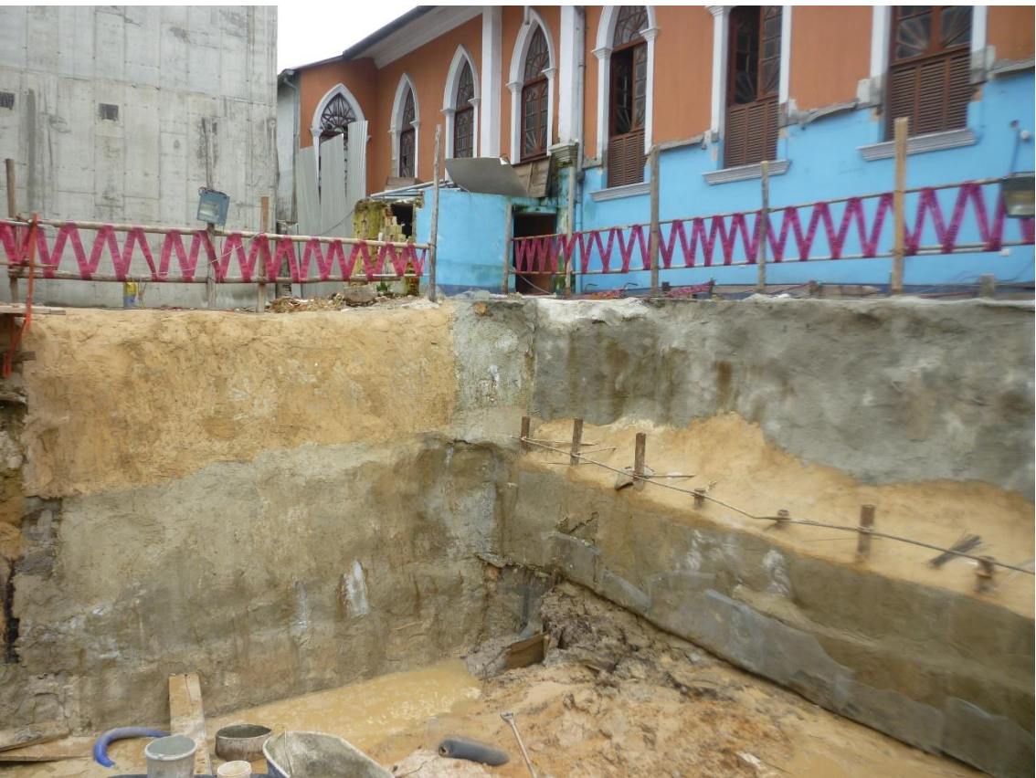
Foto 08 Plano de falla 1 estabilizado con el modelo propuesto.
