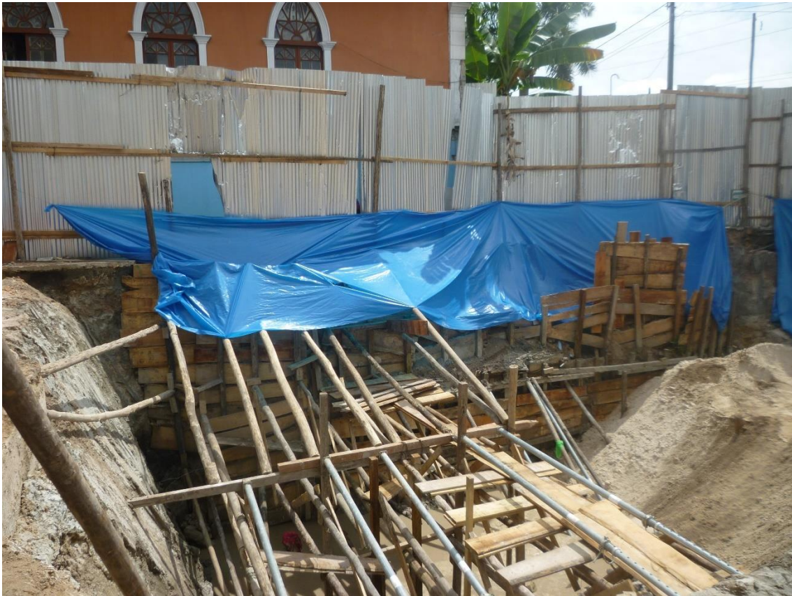
Foto 13 Estado inicial del Plano de falla 4.
