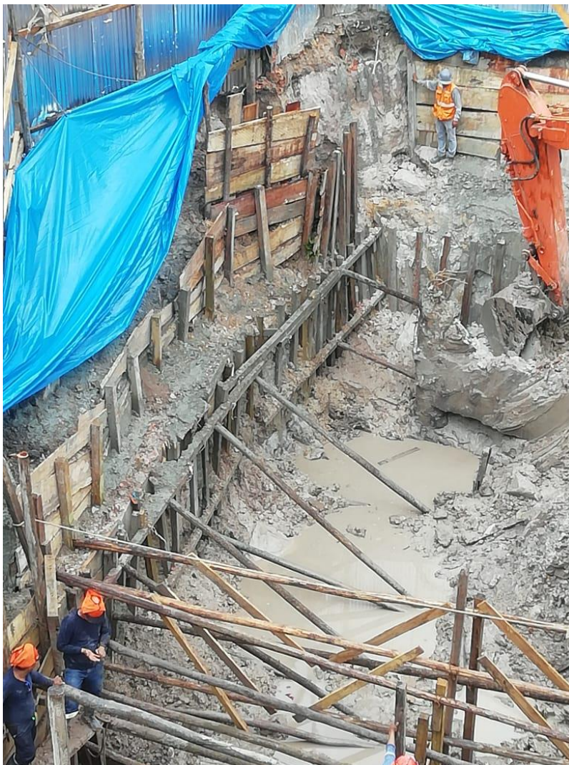
Foto 07 Estado inicial del Plano de falla 1
