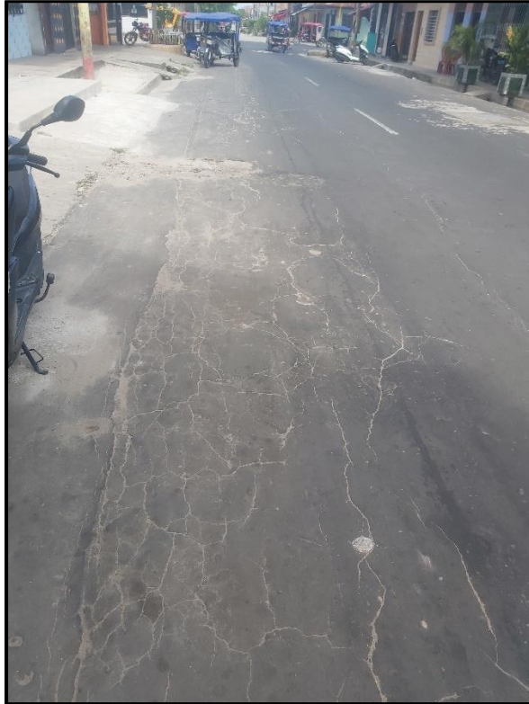
FOTO 07: VISTA DE FALLAS DEL PAVIMENTO DE LA CALLE PABLO ROSSELL CUADRA 6, CARRIL 02 LADO IZQUIERDO
