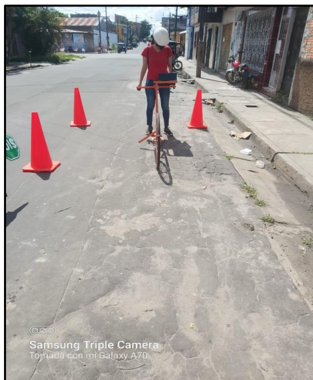
FOTO 04: VISTA PANORAMICAY VISTA DE FALLAS DE LA CALLE PABLO ROSSELL CUADRA 6, CARRIL 02 LADO IZQUIERDO
