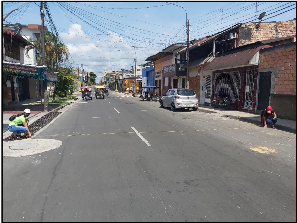
FOTO 09: VISTA PANORAMICA DEL ANCHO DE CALZADA DE LA CALLE PABLO ROSSELL CUADRA 7
