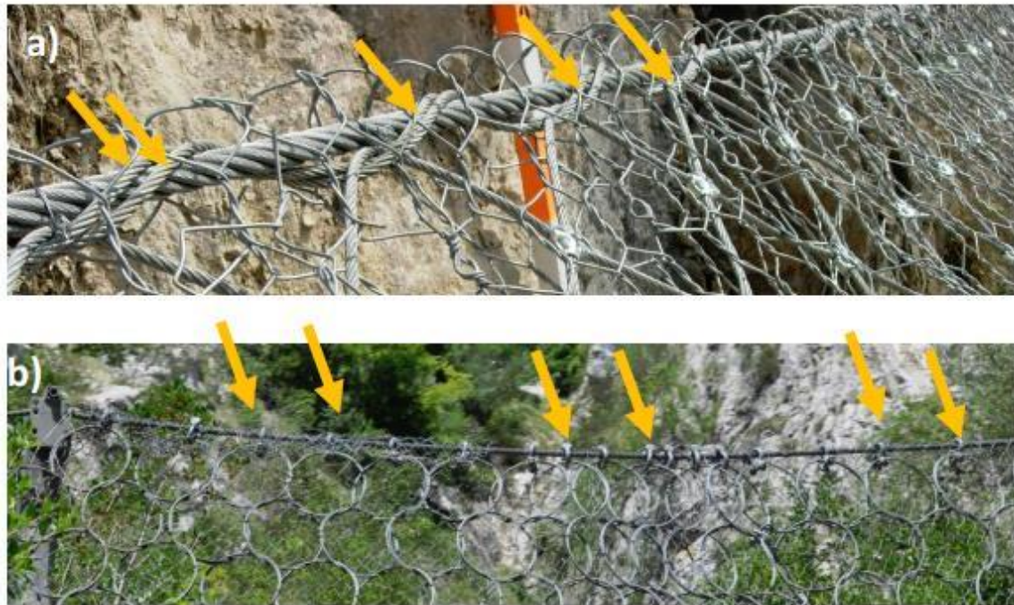
Figura 9: Conexión de la red de interceptión a los cables perimetrales mediante a) cables de cosido, y b) grilletes.
