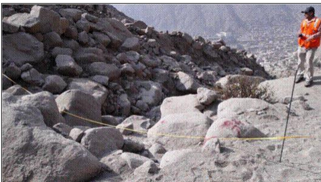
Figura 22: Inicio de replanteo de ubicación de la barraras dinámicas con wincha y estacas
