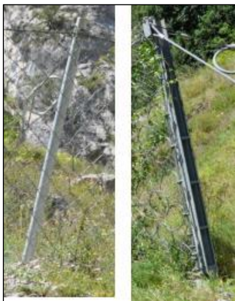
Figura 7: Postes actuando como estructura de soporte de la red de cables.
