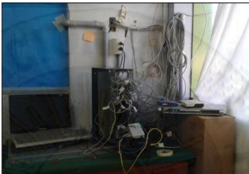
Figura 03: Estado del Servidor central
