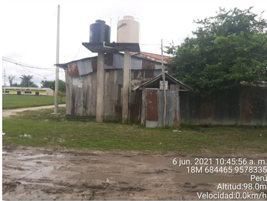
FIGURA N° 7: Foto Geo referenciada de ubicación de los Tanques elevados – Pozo N° 01
