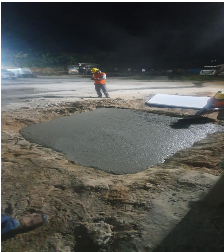
Imagen muestra la colocación del concreto simulando la estructura de un pavimento rígido
