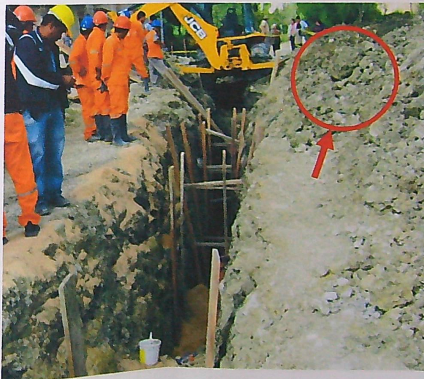
FOTO N° 02: Material excedente proveniente de las excavaciones mal acopiadas.
