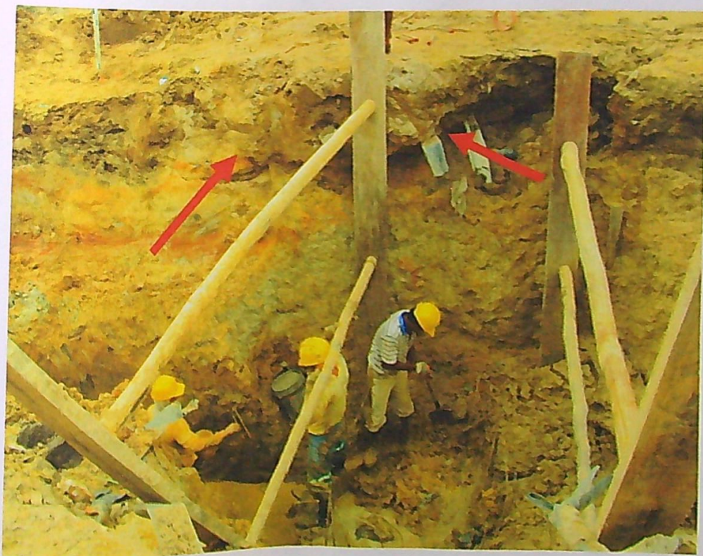
FOTO N° 04: La mala seguridad en trabajos de excavación, no cuenta con entibado.
