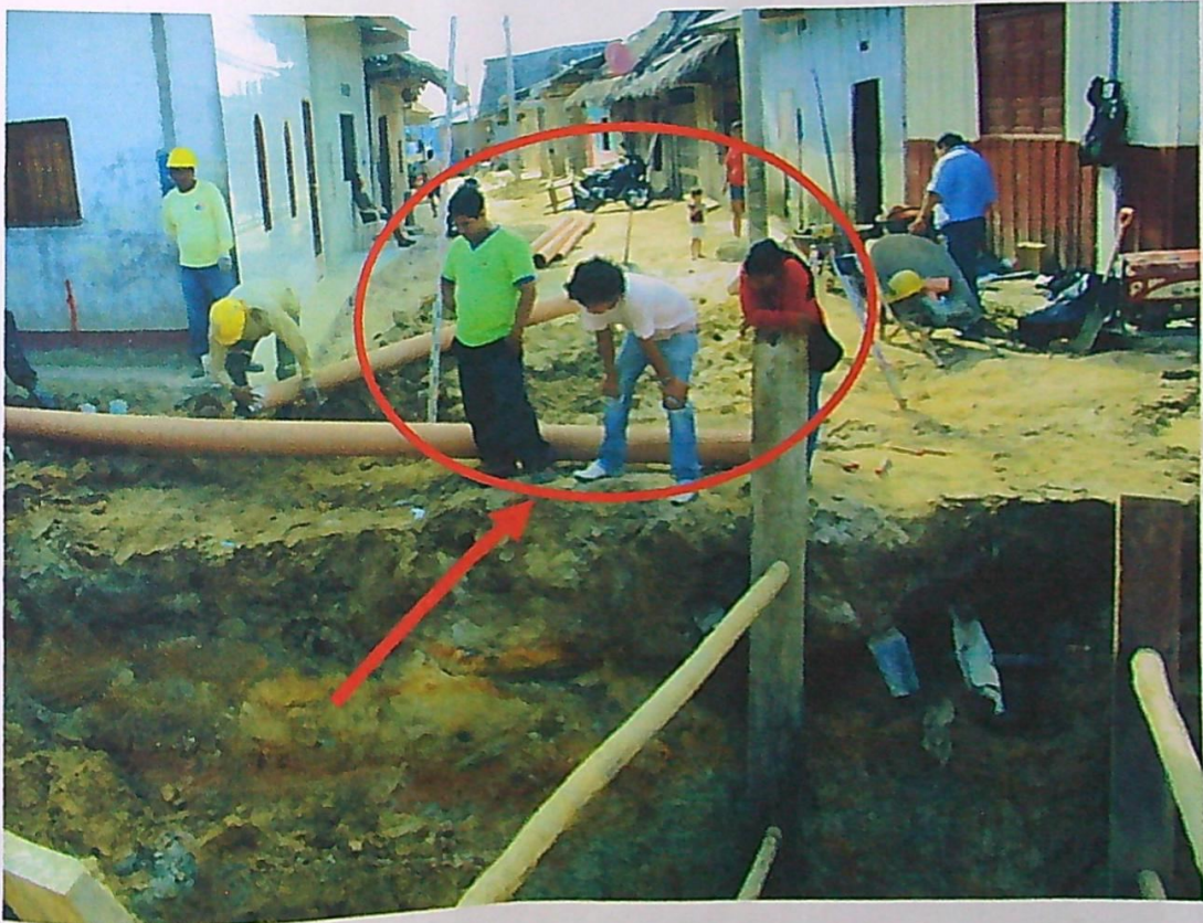
FOTO N° 08: El área de ejecución no cuenta con señalización (cintas y mallas de seguridad, carteles y/o tranqueras) se observa personal no laboral al borde de la zanja.
