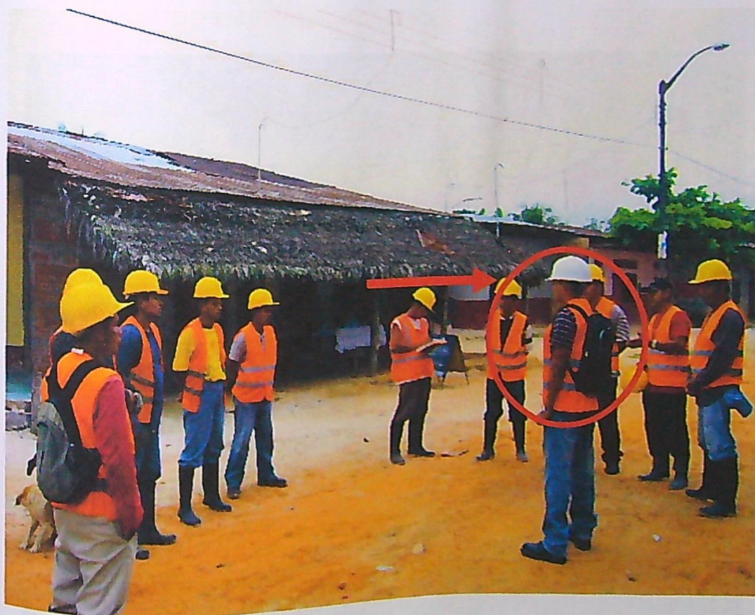
FOTO N° 10: La correcta forma de realizar una charla de 5 minutos por el responsable de Seguridad y Salud de la obra.
