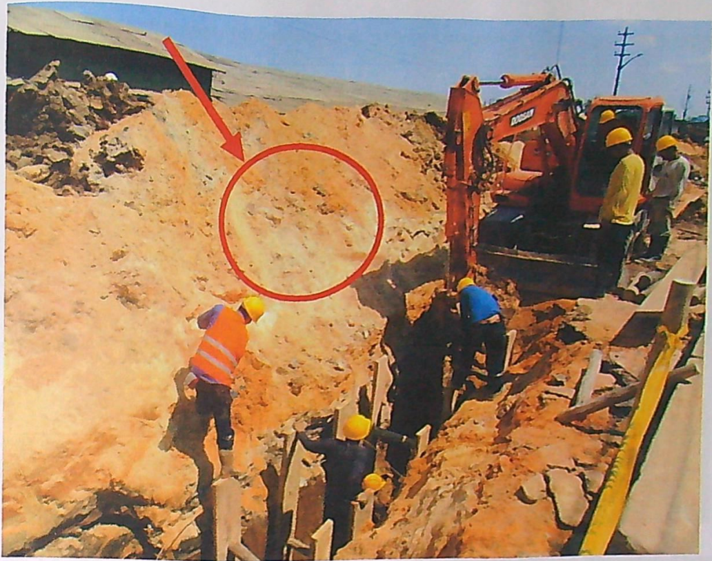
FOTO N° 07: No debe de acopiarse el material proveniente de las excavaciones al borde de la zanja, peligro de desprendimiento.
