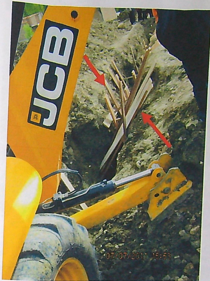
FOTO N° 03: Mal apuntalamiento y/o entibado no protege la excavación.
