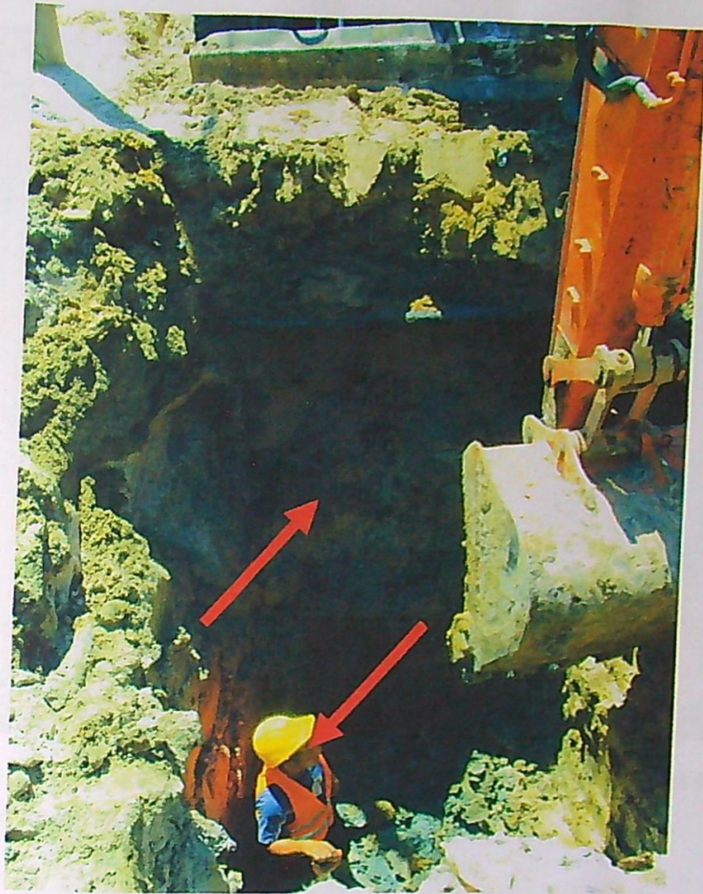
FOTO N° 05: No debe de contar ningún personal dentro de la zanja en el momento de excavación con maquinarias, no cuenta con entibado, mala seguridad.
