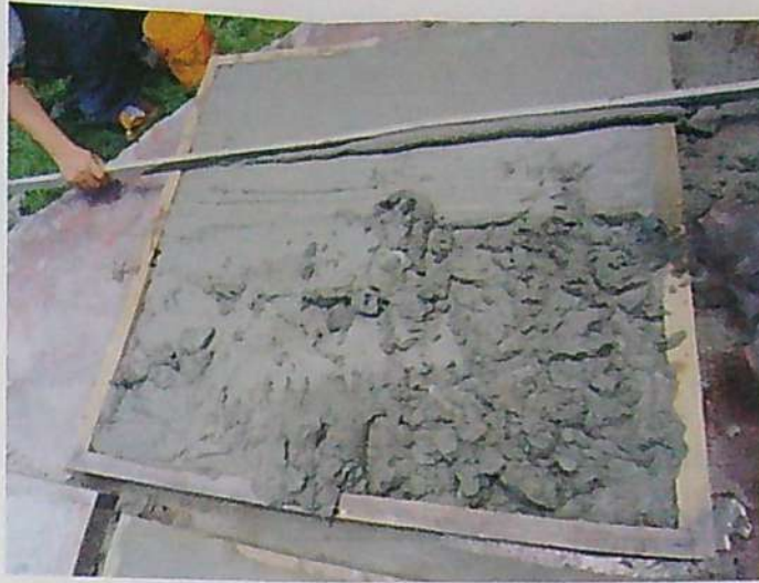
FOTOGRAFÍA N° 51: Llenado de los moldes de encofrado con la mezcla de concreto cemento-arena.
