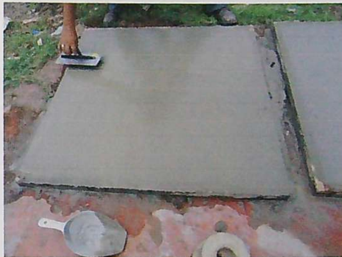
FOTOGRAFÍA N° 52: Acabado de la superficie de las losas. Se les dio un acabado semipulido.
