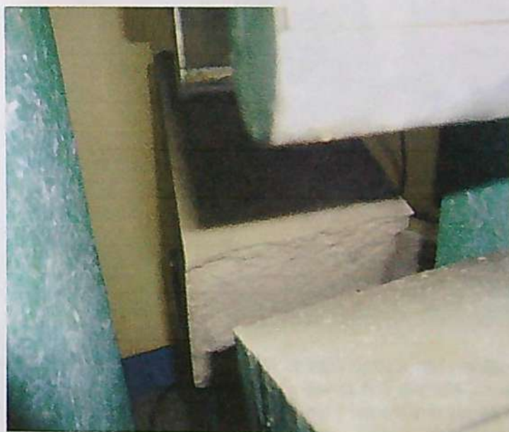
FOTOGRAFÍA N° 35: Nótese la cara de la sección fallada, vertical y uniforme, lo cual denota una subida brusca del eje neutro hasta llegar rápida y violentamente a la zona en compresión. Viga sin reforzamiento de fibras.
