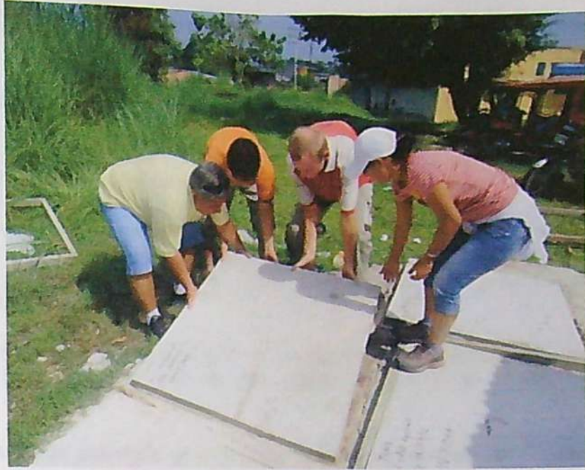
FOTOGRAFÍA N° 57: Las losas fueron levantadas al final del ensayo para determinar el grado de fisuramiento en la base de las mismas.
