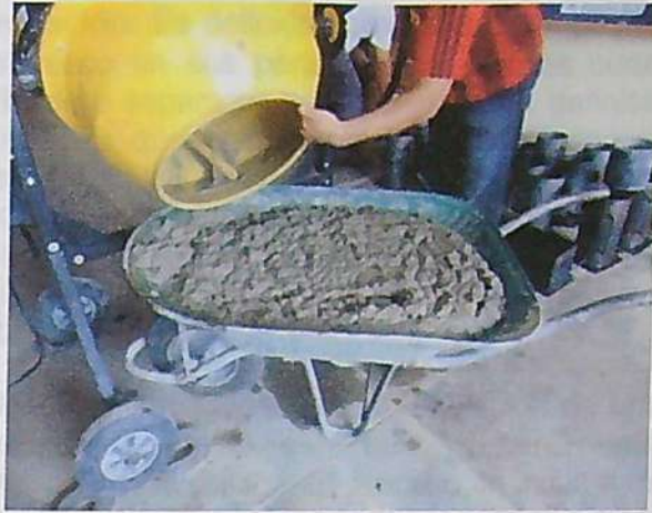
FOTOGRAFÍA N° 13: Vaciado de mezcla en carretilla, para ser llevada a los moldes. Las condiciones de trabajabilidad son las que afectan su colocación en obra.
