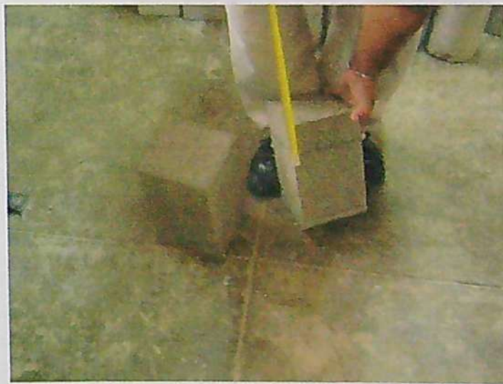
FOTOGRAFÍA N° 39: En la vista se aprecia la ubicación de la falla en el tercio central de la viga. Se trata de una viga sin refuerzo de fibras.
