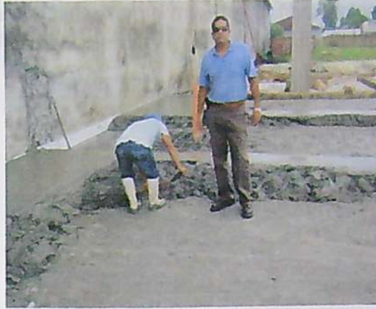
FOTOGRAFÍA N° 09: Uso de fibras de acero Wirand FF1 en losa de 20 centímetros de espesor en la ciudad de Iquitos, distrito de Punchana, obra correspondiente al patio de maniobras de la empresa cervecera DICOPOSAC. Las juntas de dilatación conformaban paños rectangulares de 12x15 metros. Al interior de cada paño, las juntas de contracción (aserradas) conformaban paños rectangulares de 5x6 metros.
