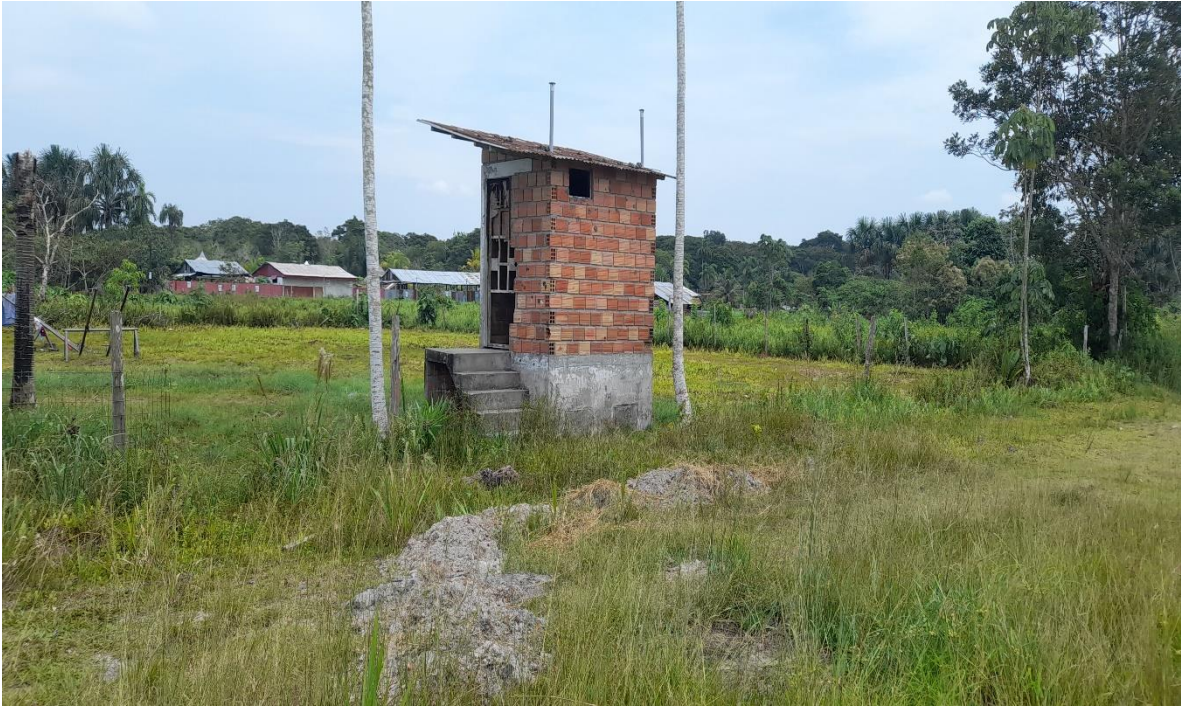
FOTO N°05: VISTA PANORÁMICA DEL BAÑO UBS EXISTENTE DEL COLEGIO INICIAL DE LA COMUNIDAD
