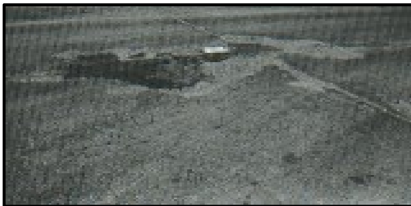
Figura 46. Desconchamiento / mapa de grietas / craquelado de alta severidad. Fuente: Pavement Condition Index (PCI).
