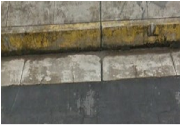
GRIETA DE REFLEXION DE JUNTA
