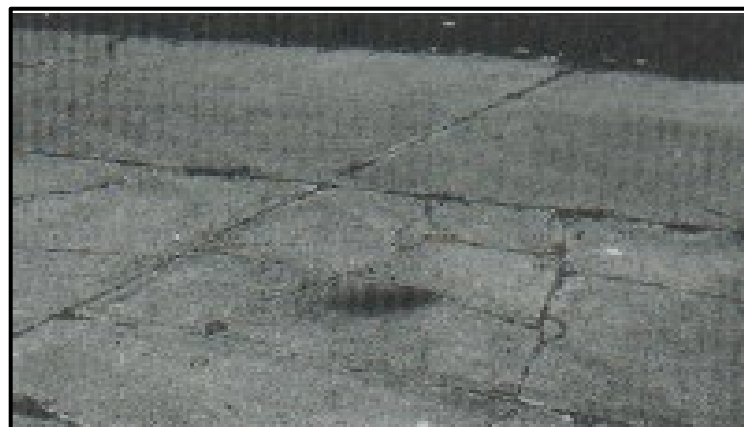
Figura 11. Losa Dividida de severidad media. Fuente: Pavement Condition Index (PCI).
