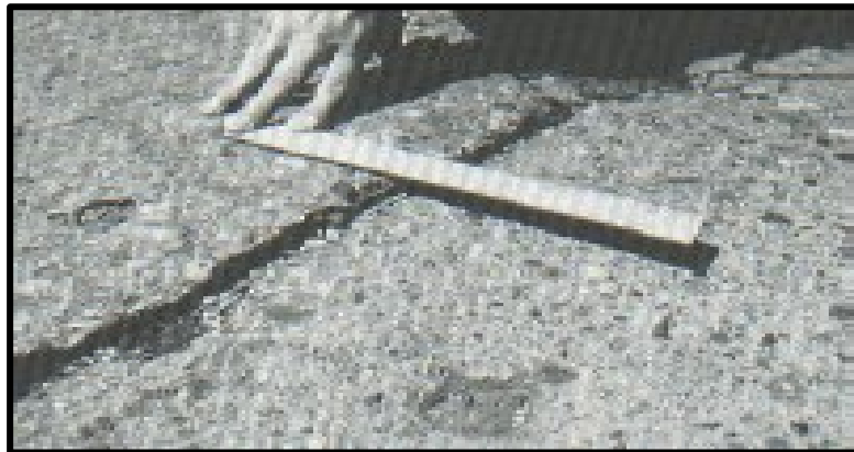
Figura 17. Escala de severidad media. Fuente: Pavement Condition Index (PCI).
