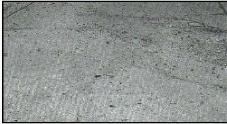
Figura 15. Grieta de Durabilidad “D” de alta severidad. Fuente: Pavement Condition Index (PCI).
