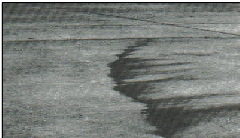
Figura 37. Bombeo en una grieta. Fuente: Pavement Condition Index (PCI).
