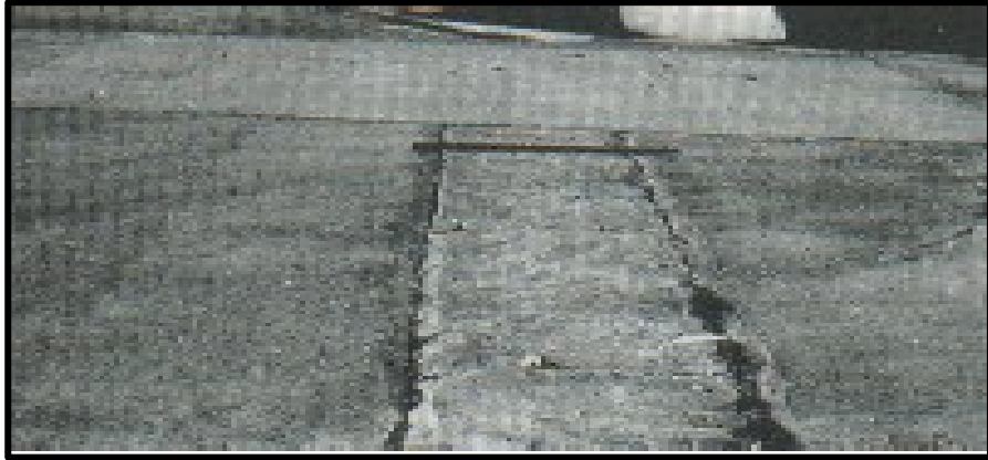
Figura 29. Parche grande y acometidas de servicios públicos de severidad media.
