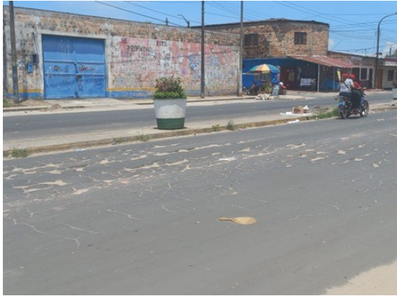
HUNDIMIENTO, CORRUGACION Y HUECO
