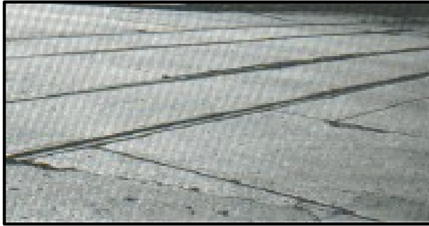
Figura 41. Cruces de vía férrea de baja severidad. Fuente: Pavement Condition Index (PCI).
