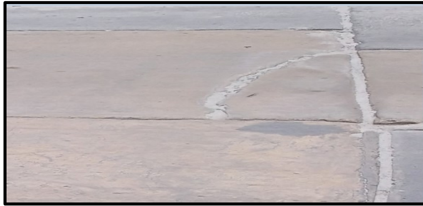
Figura 9. Grieta de Esquina de alta severidad. Fuente: Pavement Condition Index (PCI).
