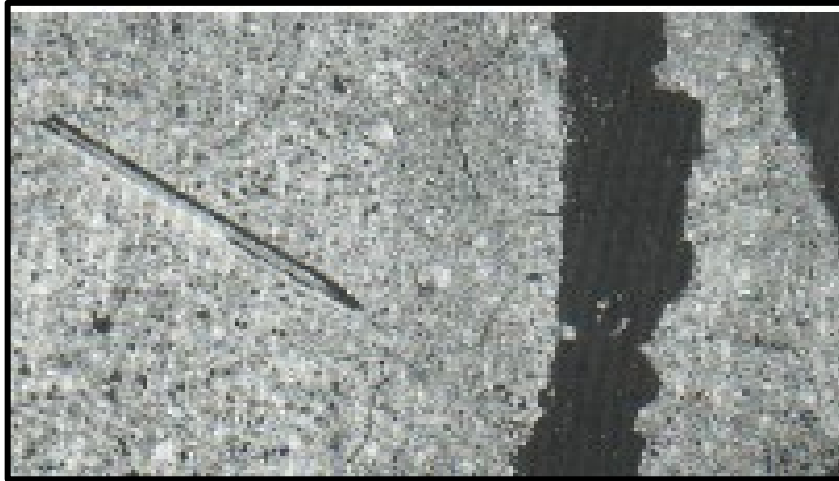
Figura 13. Grieta de Durabilidad “D” de baja severidad. Fuente: Pavement Condition Index (PCI).
