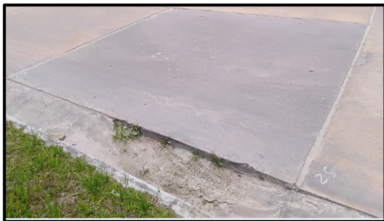
Figura 5. Blowup – Buckling (Rotura por Pandeo) de media severidad.- Fuente: Pavement Condition Index (PCI).
