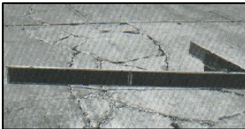
Figura 40. Punzonamiento de alta severidad. Fuente: Pavement Condition Index (PCI).
