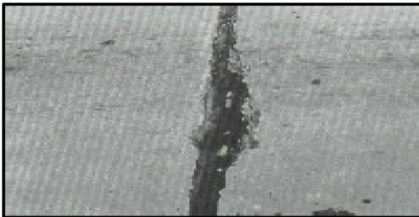
Figura 20. Daño del sello de juntas de severidad media. Fuente: Pavement Condition Index (PCI).
