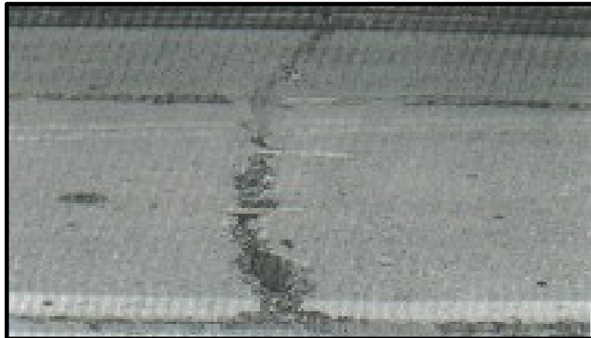
Figura 27. Grietas lineales de alta severidad en una losa de concreto simple.
