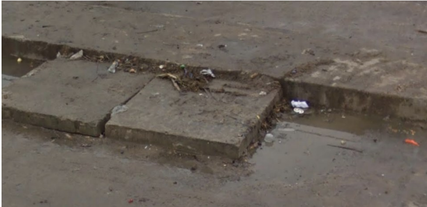
GRIETA DE REFLEXION DE JUNTA
