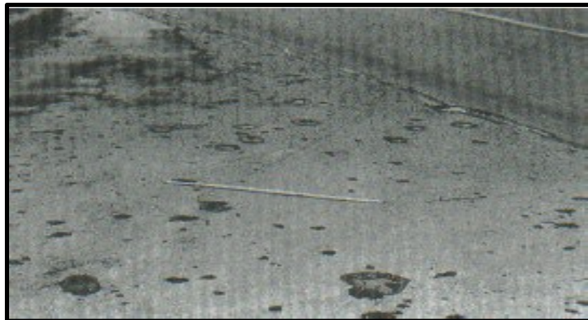
Figura 35. Popout en una losa. Fuente: Pavement Condition Index (PCI).
