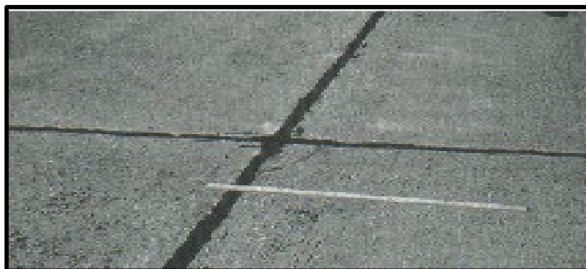
Figura 48. Descascaramiento de esquina de baja severidad. Fuente: Pavement Condition Index (PCI).
