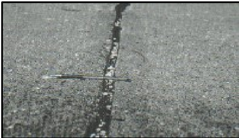
Figura 21. Daño del sello de juntas de alta severidad. Fuente: Pavement Condition Index (PCI).
