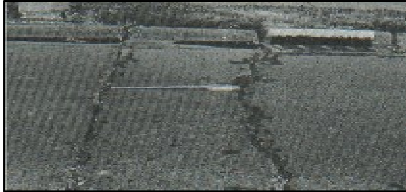
Figura 38. Punzonamiento de baja severidad. Fuente: Pavement Condition Index (PCI).
