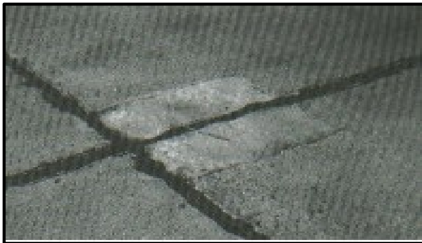
Figura 31. Parche pequeño de baja severidad. Fuente: Pavement Condition Index (PCI).
