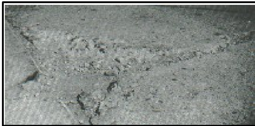
Figura 50. Descascaramiento de esquina de alta severidad. Fuente: Pavement Condition Index (PCI).
