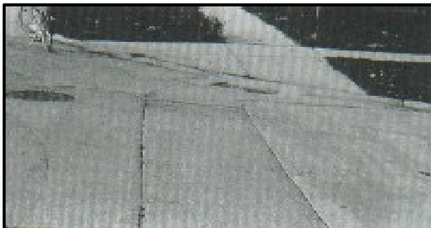
Figura 28. Parche grande y acometidas de servicios públicos de baja severidad.
