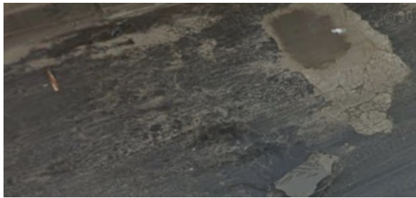
ABULTAMIENTO Y HUNDIMIENTO
