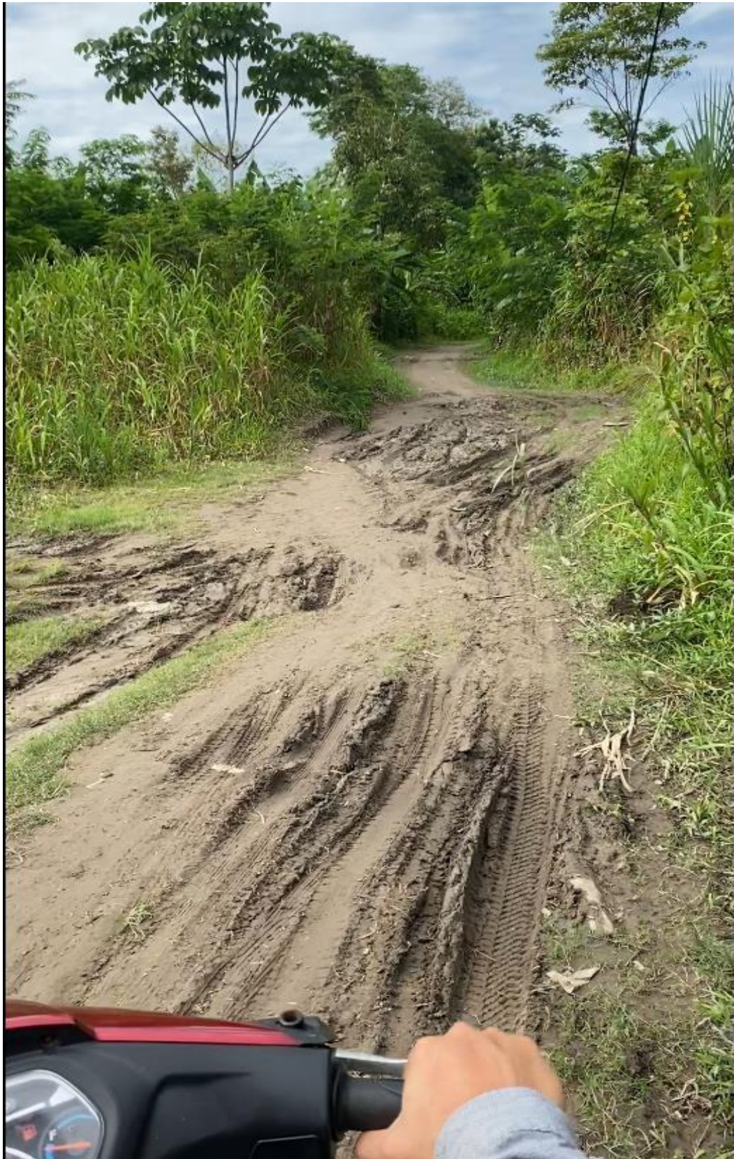
FOTO 06: VIAS DE ACCESO A LA COMUNIDAD DE CANTA GALLO EN MAL ESTADO
