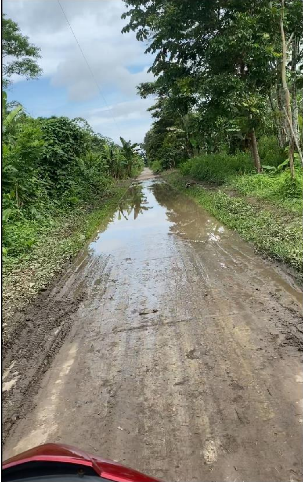
FOTO 04: SE CONSTATO LA FALTA DE DRENAJE PLUVIAL
