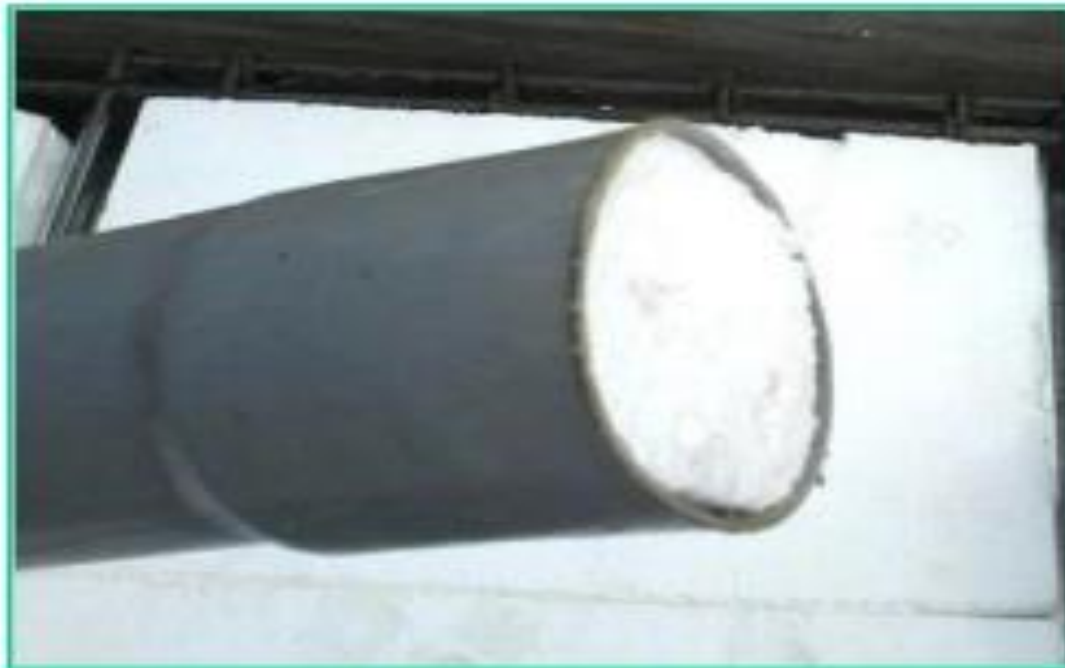
FIGURA N° 15 TAPONES PARA LAS INSTALACIONES SANITARIAS
