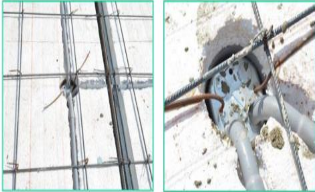
FIGURA N° 10 CONEXIONES PARA LAS LUMINARIAS
