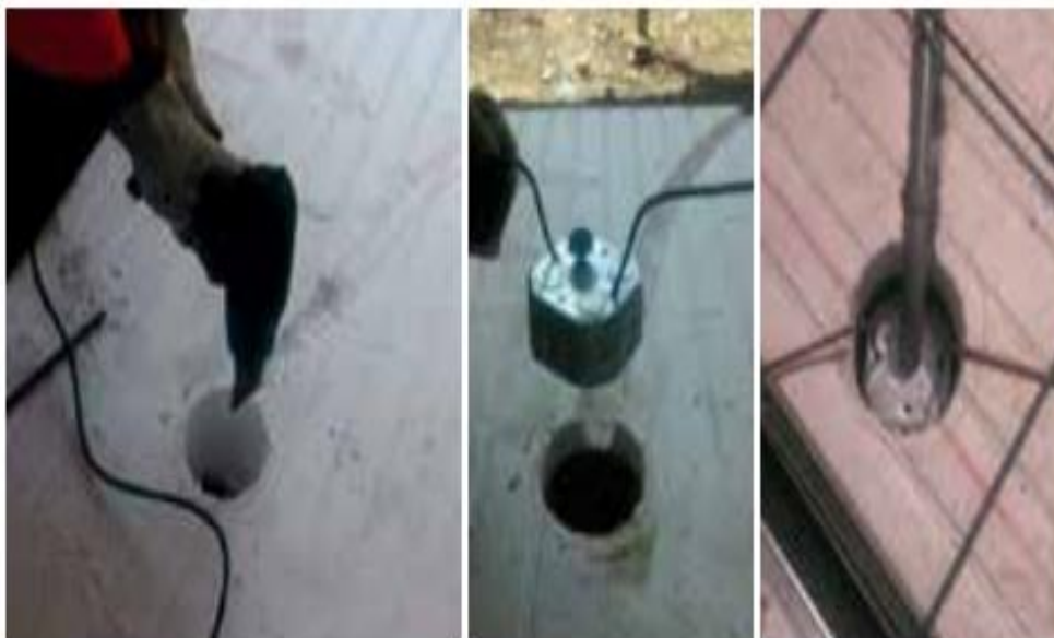
FIGURA N° 11 CANALES ELÉCTRICOS EN LOS CASETONES
