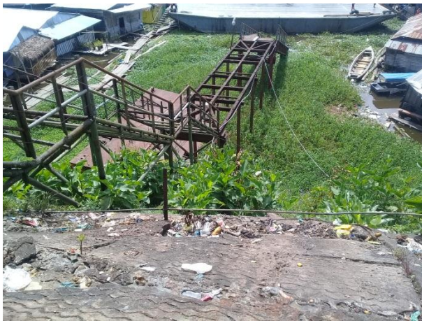
FOTO 04: RESTOS DE RESIDUOS SOLIDOS (PUENTE MERCADO DE PRODUCTORES)
