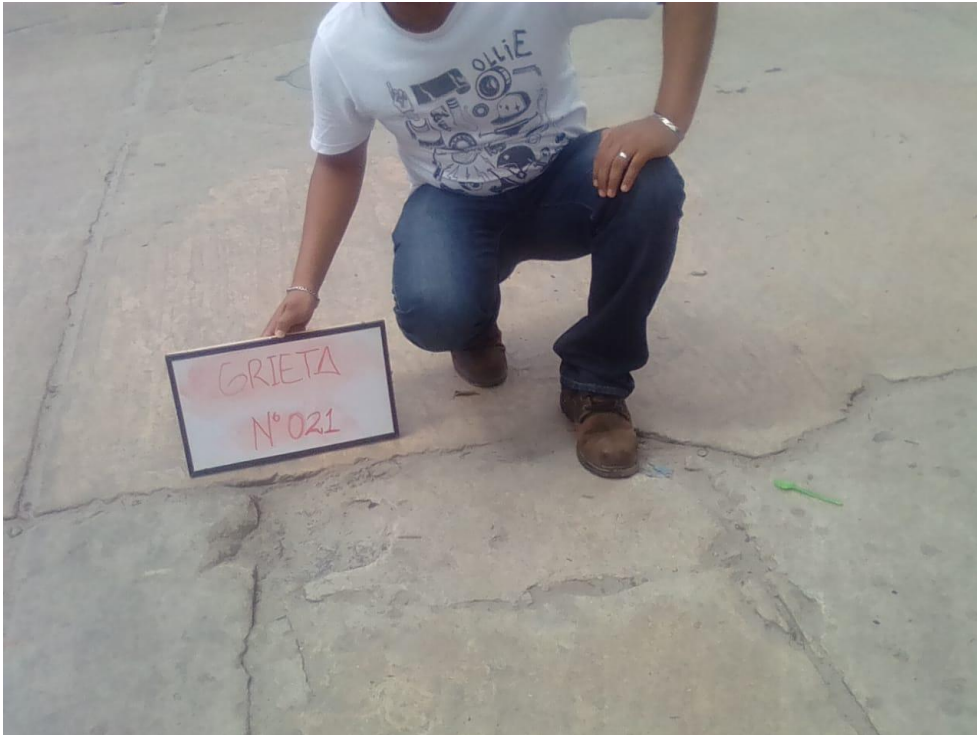
Foto 21 Grieta N° 21 con el tipo de deterioro: Desintegración
