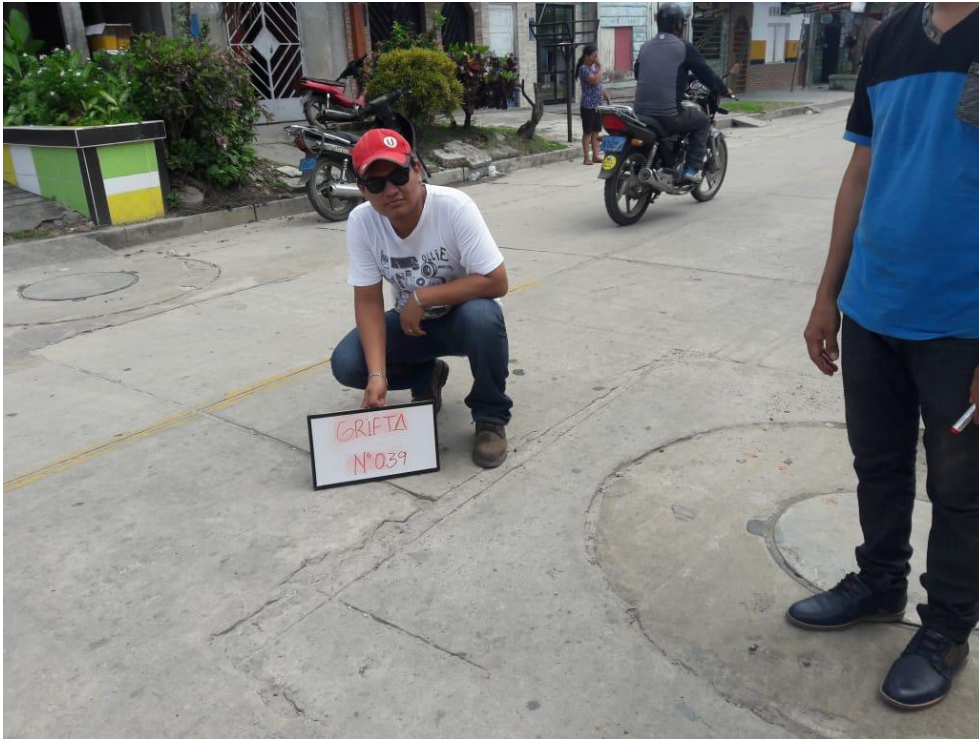
Foto 39 Grieta N° 39 con el tipo de deterioro: Separación de la junta longitudinal
