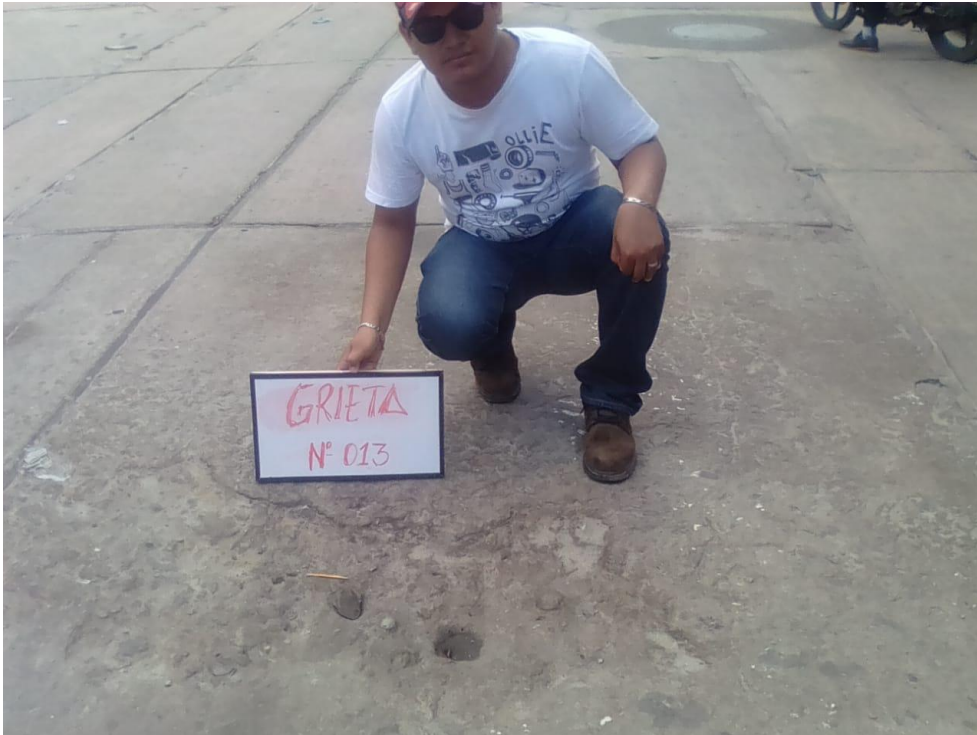
Foto 13 Grieta N° 13 con el tipo de deterioro: Surgencia de finos
