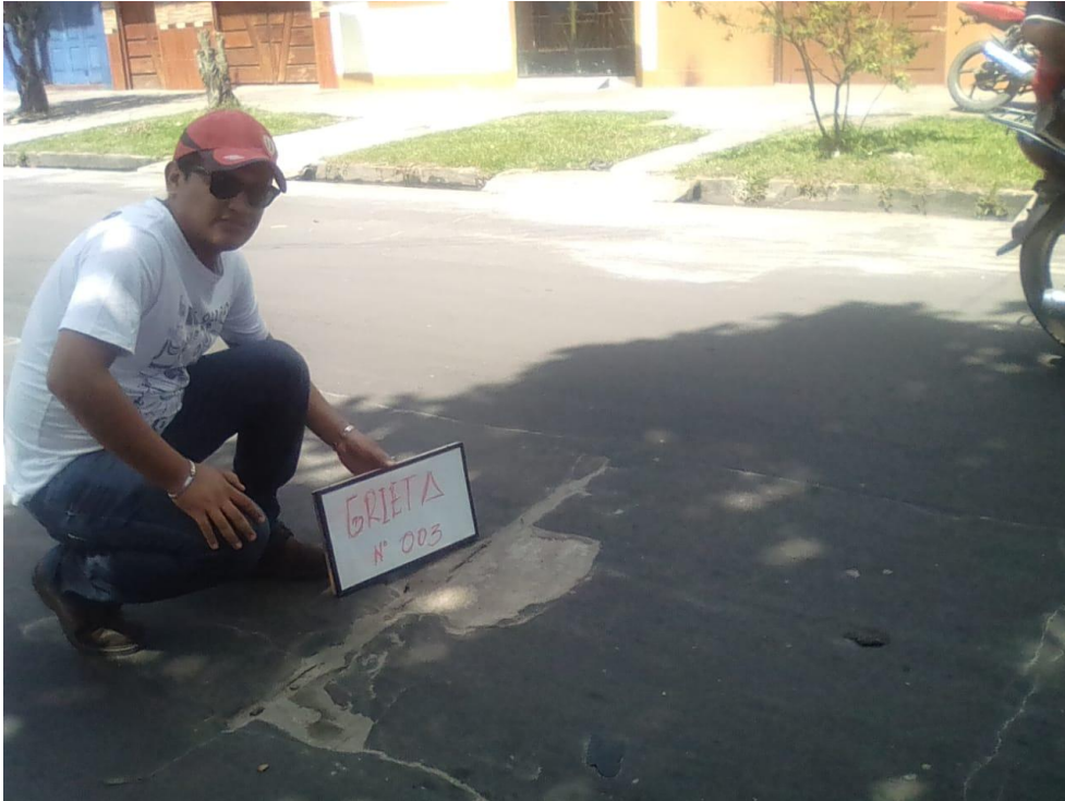
Foto 3 Grieta N° 3 con el tipo de deterioro: Fragmentación múltiple
