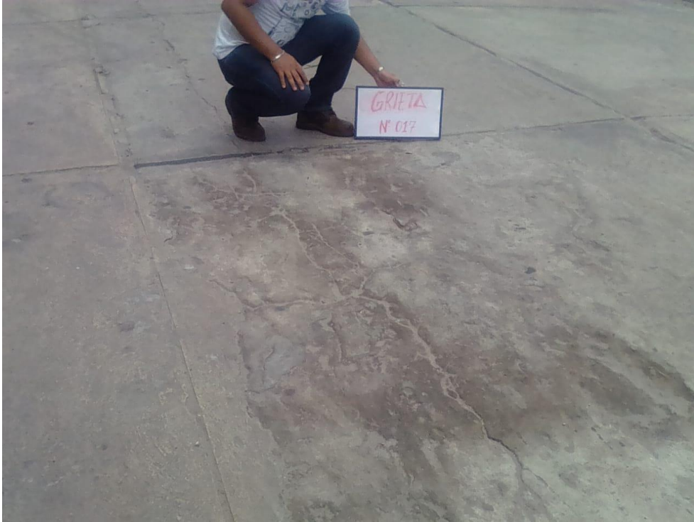
Foto 17 Grieta N° 17 con el tipo de deterioro: Baches
