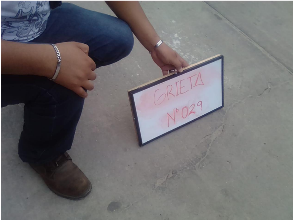
Foto 29 Grieta N° 29 con el tipo de deterioro: Juntas saltadas
