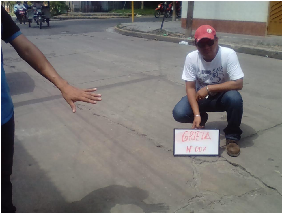
Foto 7 Grieta N° 7 con el tipo de deterioro: Fragmentación múltiple
