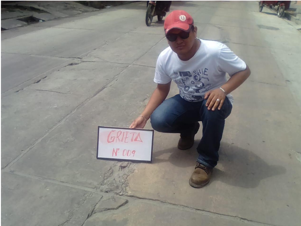
Foto 9 Grieta N° 9 con el tipo de deterioro: Grietas longitudinales y transv.
