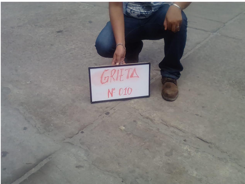
Foto 10 Grieta N° 10 con el tipo de deterioro: Juntas saltadas
