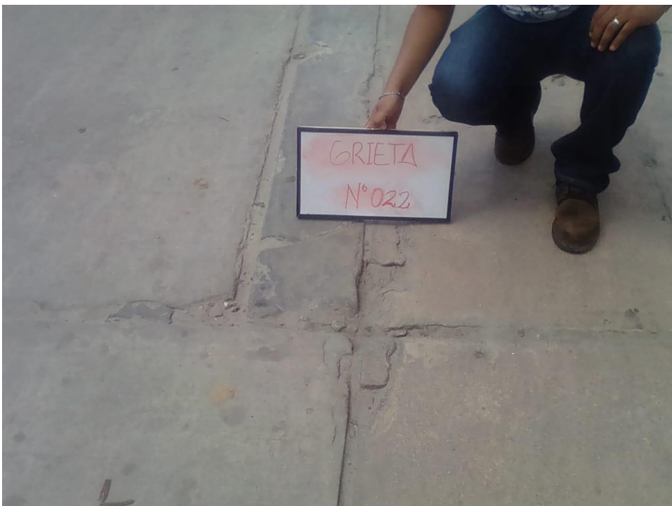
Foto 22 Grieta N° 22 con el tipo de deterioro: Grietas longitudinales y transv.
