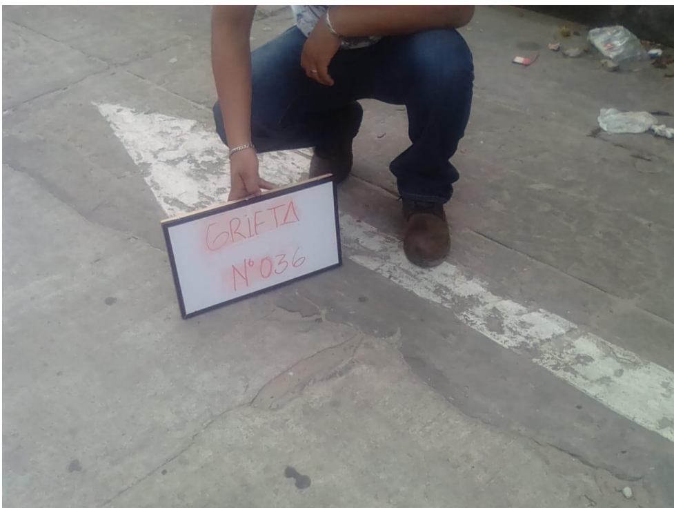
Foto 36 Grieta N° 36 con el tipo de deterioro: Baches
