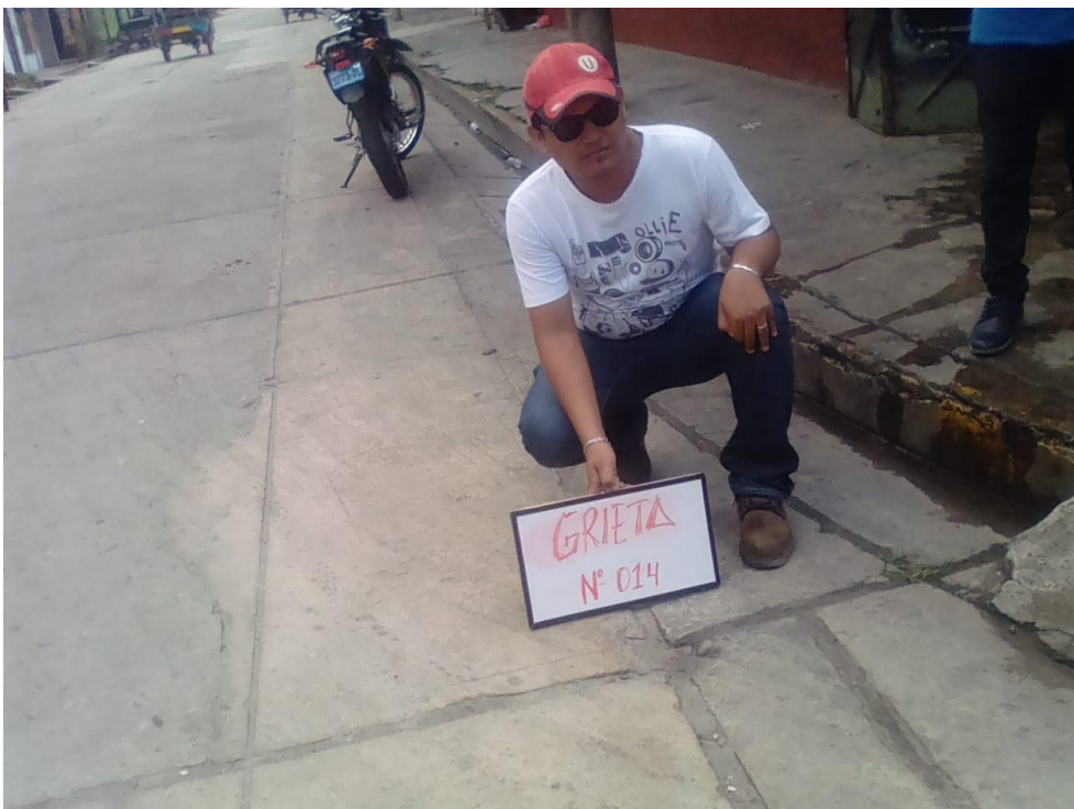
Foto 14 Grieta N° 14 con el tipo de deterioro: Separación entre berma y pavimento
