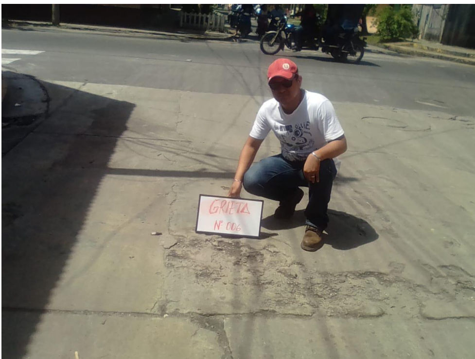
Foto 6 Grieta N° 6 con el tipo de deterioro: Desintegración
