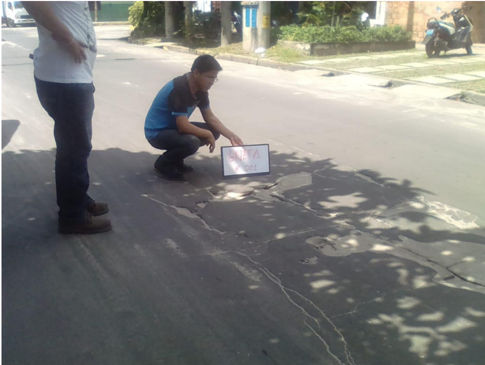
Foto 1 Grieta N° 1 con el tipo de deterioro: Separación de la junta longitudinal
