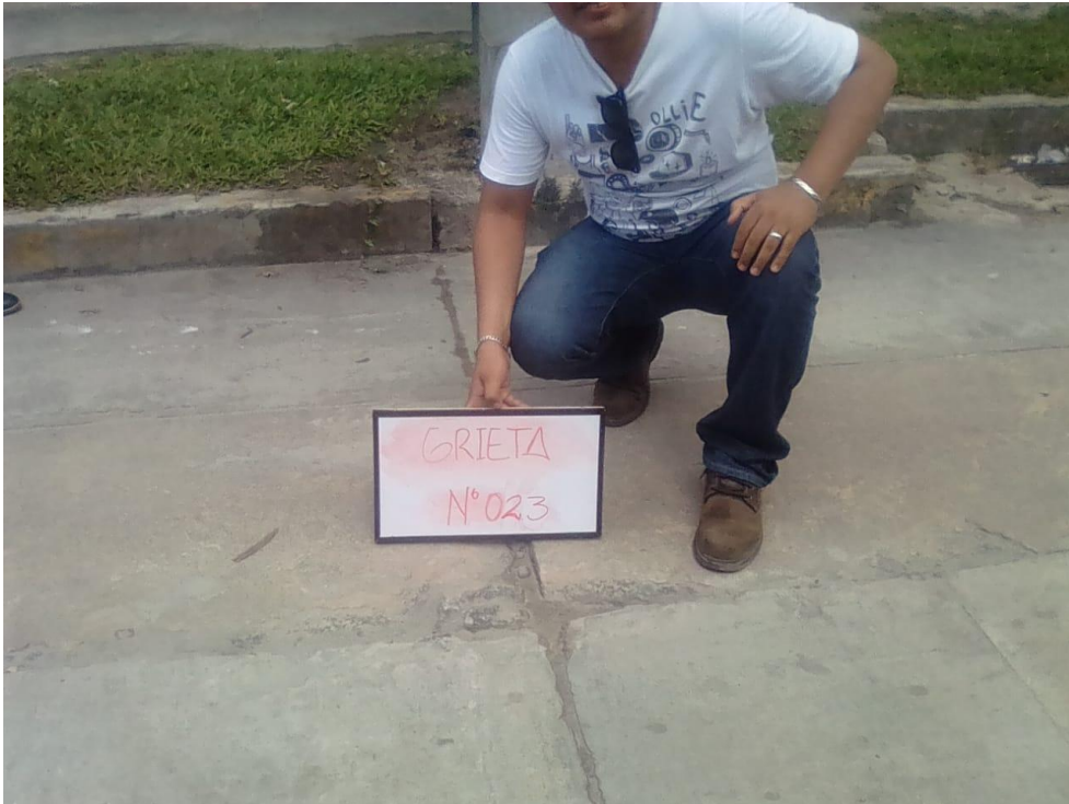
Foto 23 Grieta N° 23 con el tipo de deterioro: Grietas de esquina
