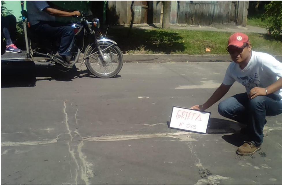
Foto 5 Grieta N° 5 con el tipo de deterioro: Grietas longitudinales y transv.
