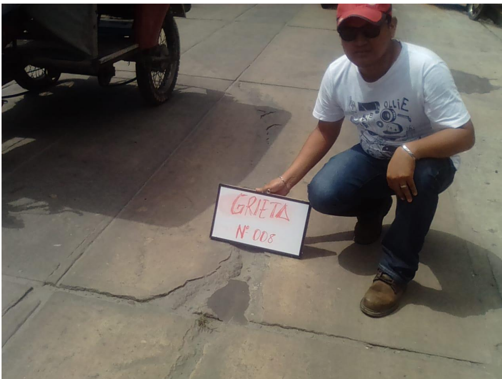
Foto 8 Grieta N° 8 con el tipo de deterioro: Juntas saltadas
