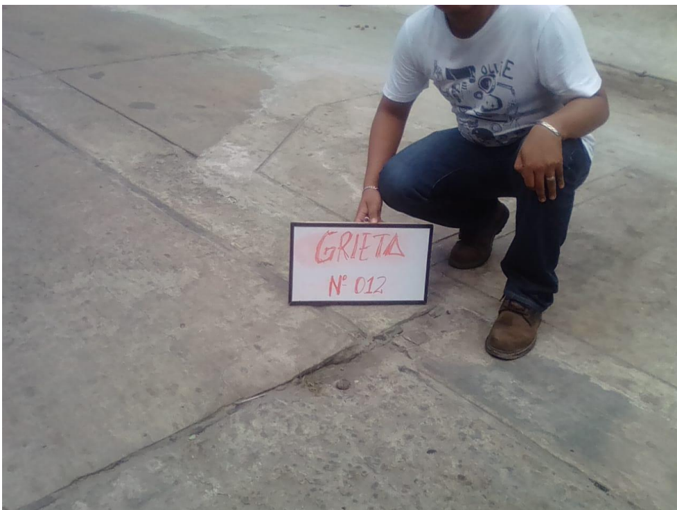
Foto 12 Grieta N° 12 con el tipo de deterioro: Grietas de esquina
