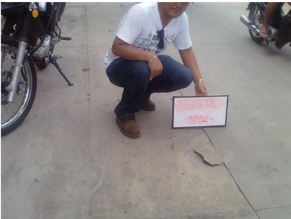
Foto 24 Grieta N° 24 con el tipo de deterioro: Grietas longitudinales y transv.
