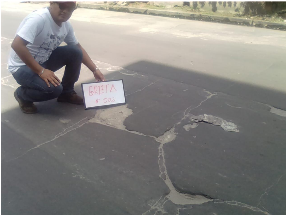
Foto 2 Grieta N° 2 con el tipo de deterioro: Levantamiento localizado
