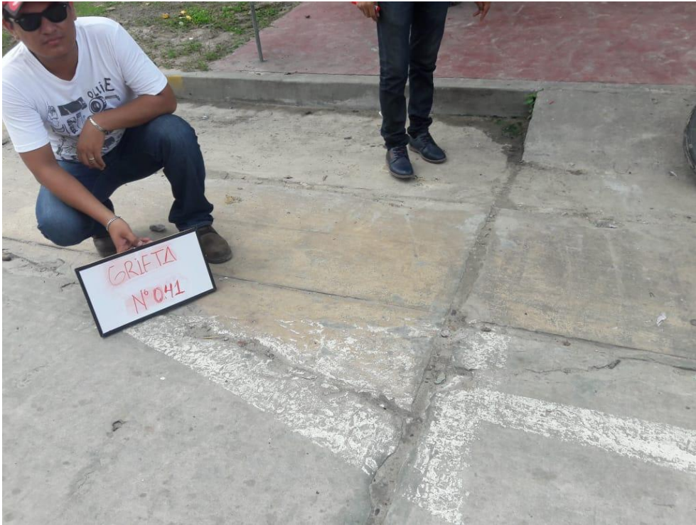
Foto 41 Grieta N° 41 con el tipo de deterioro: Grietas de esquina
