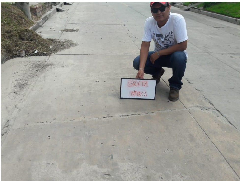
Foto 38 Grieta N° 38 con el tipo de deterioro: Separación de la junta longitudinal
