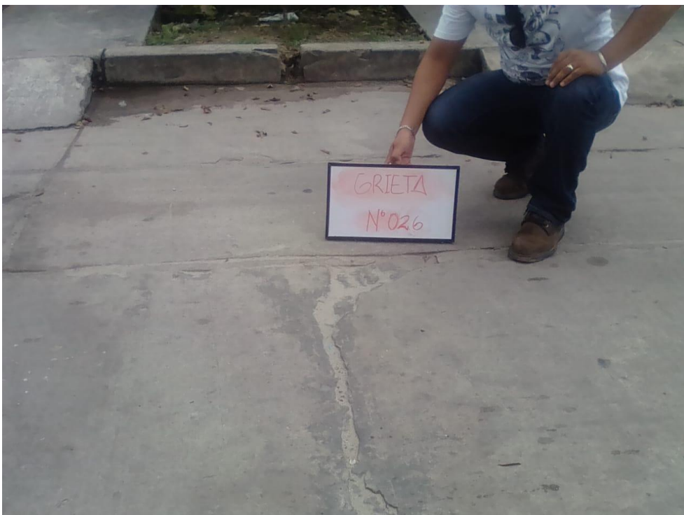
Foto 26 Grieta N° 26 con el tipo de deterioro: Grietas longitudinales y transv.
