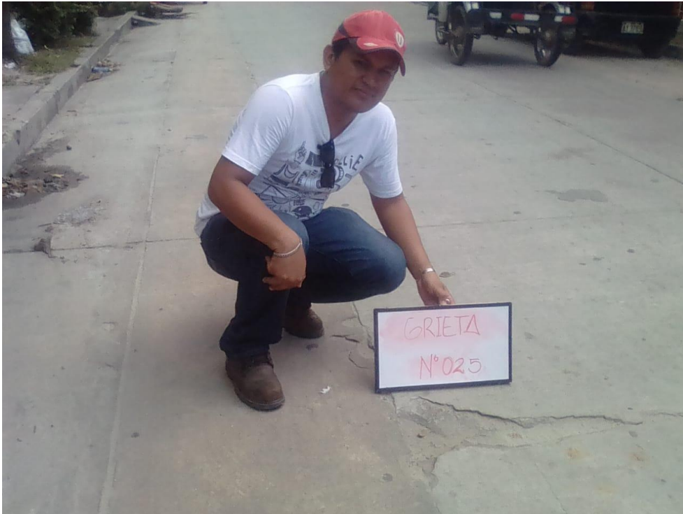
Foto 25 Grieta N° 25 con el tipo de deterioro: Fragmentación múltiple
