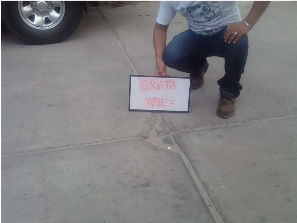
Foto 33 Grieta N° 33 con el tipo de deterioro: Grietas de esquina
