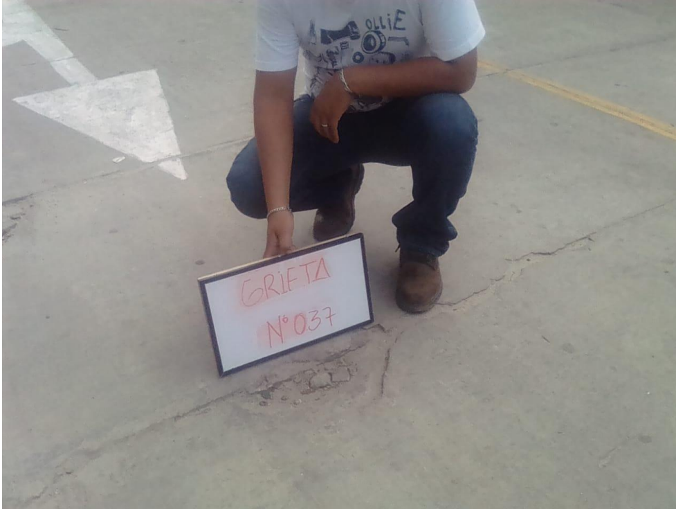
Foto 37 Grieta N° 37 con el tipo de deterioro: Escalonamiento de juntas y grietas
