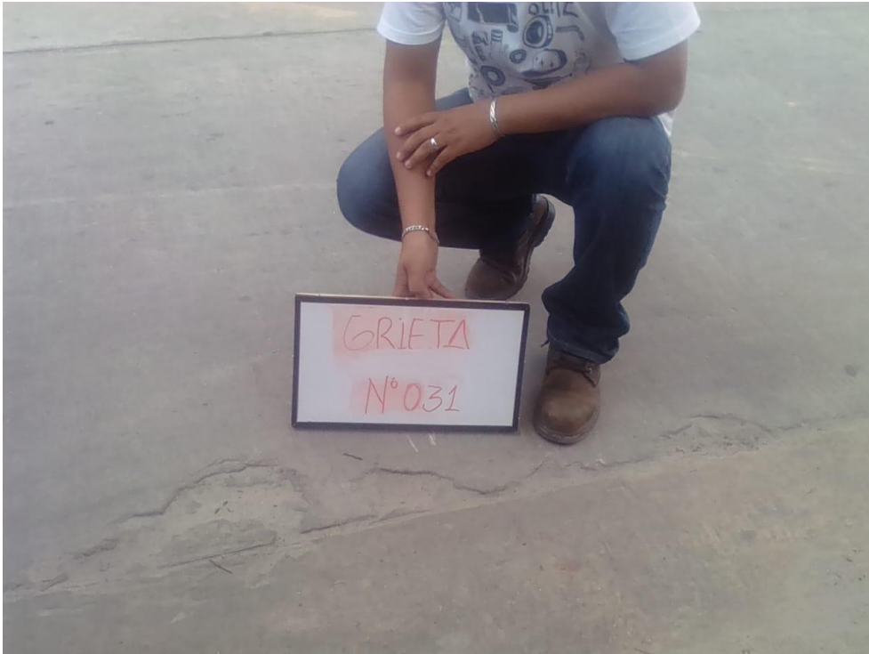
Foto 31 Grieta N° 31 con el tipo de deterioro: Juntas saltadas
