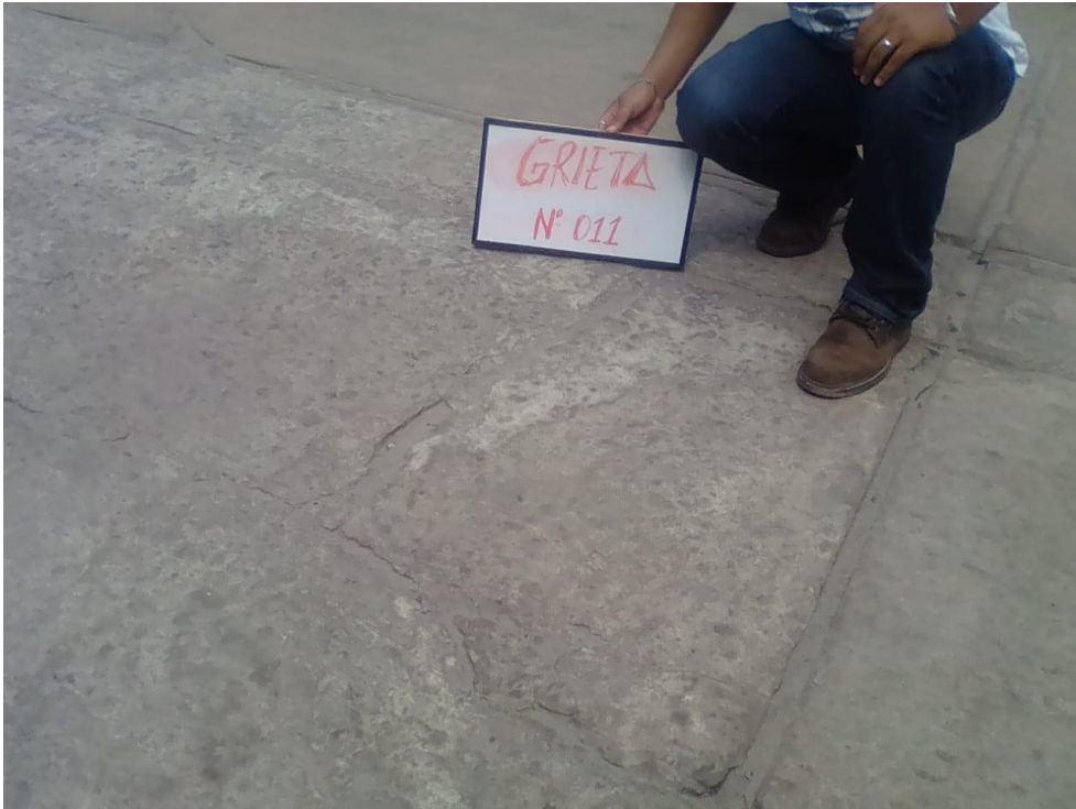
Foto 11 Grieta N° 11 con el tipo de deterioro: Grietas longitudinales y transv.
