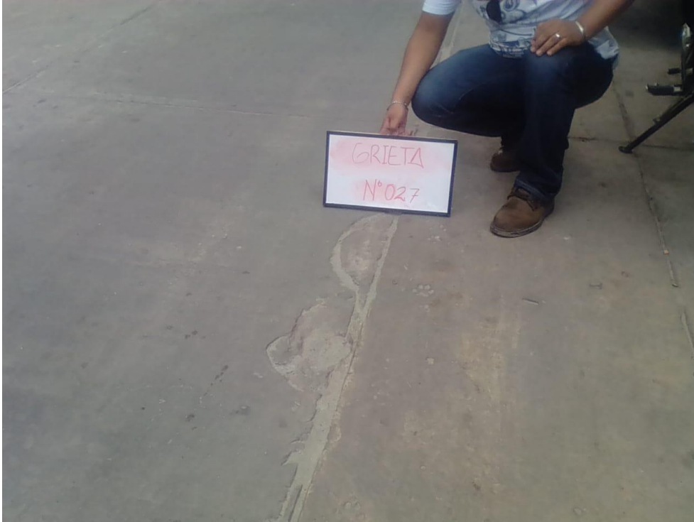
Foto 27 Grieta N° 27 con el tipo de deterioro: Descenso de la berma
