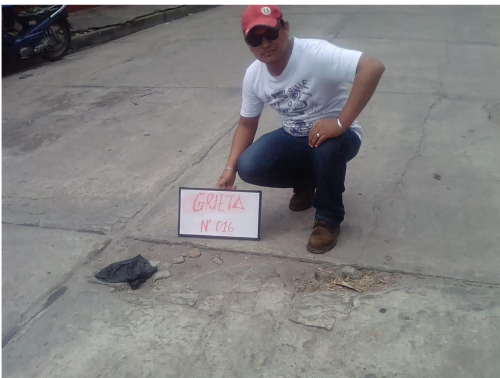
Foto 16 Grieta Nº 16 con el tipo de deterioro: Levantamiento localizado
