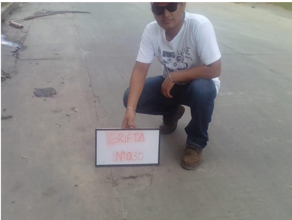
Foto 30 Grieta N° 30 con el tipo de deterioro: Escalonamiento de juntas y grietas
