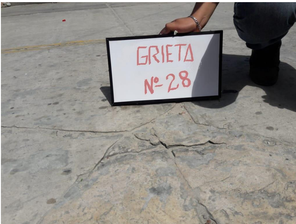
Foto 28 Grieta N° 28 con el tipo de deterioro: Levantamiento localizado
