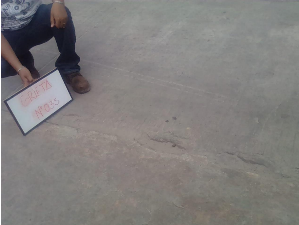
Foto 35 Grieta N° 35 con el tipo de deterioro: Deficiencias del sellado
