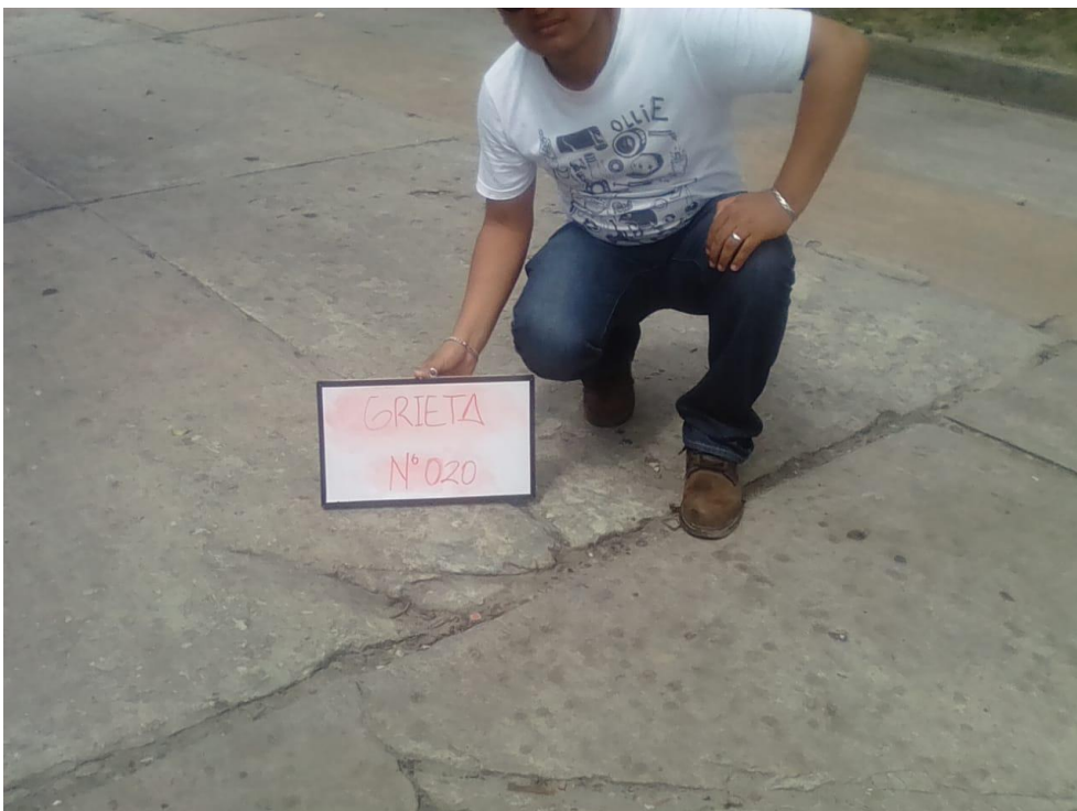
Foto 20 Grieta N° 20 con el tipo de deterioro: Separación de la junta longitudinal
