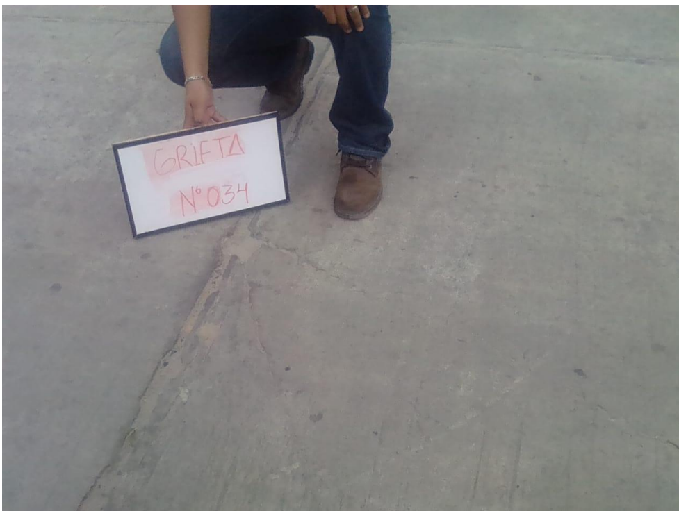
Foto 34 Grieta N° 34 con el tipo de deterioro: Deficiencias del sellado
