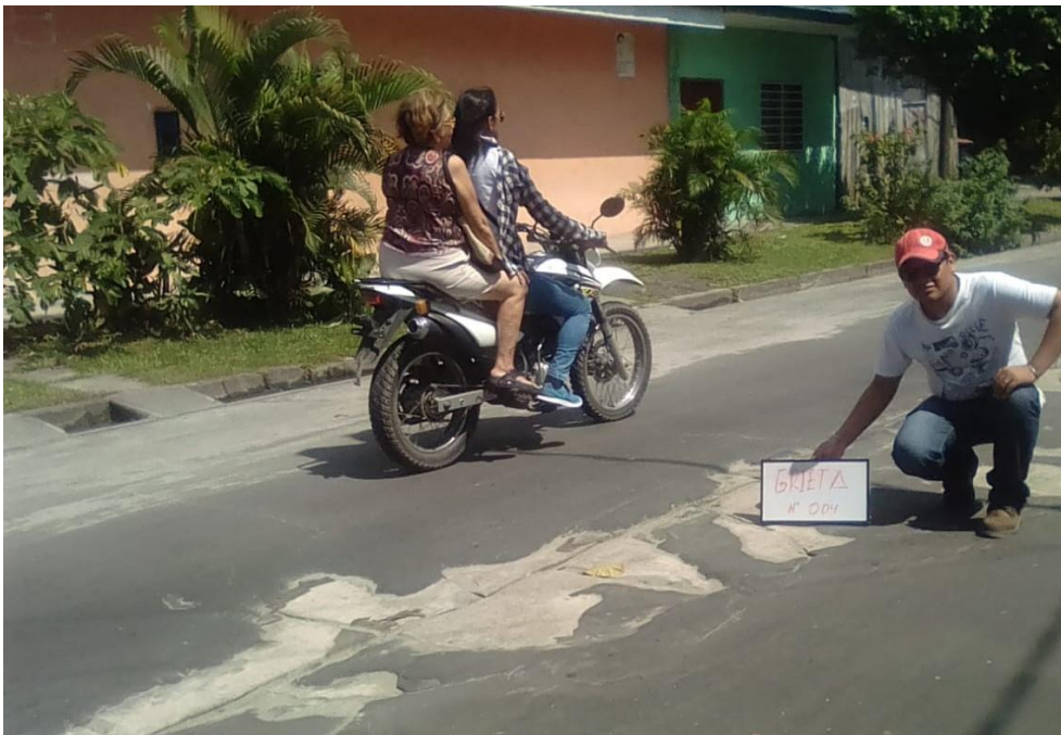
Foto 4 Grieta N° 4 con el tipo de deterioro: Desintegración
