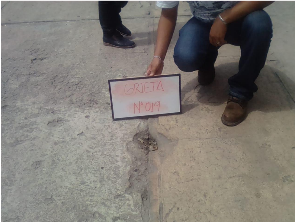
Foto 19 Grieta N° 19 con el tipo de deterioro: Parches deteriorados
