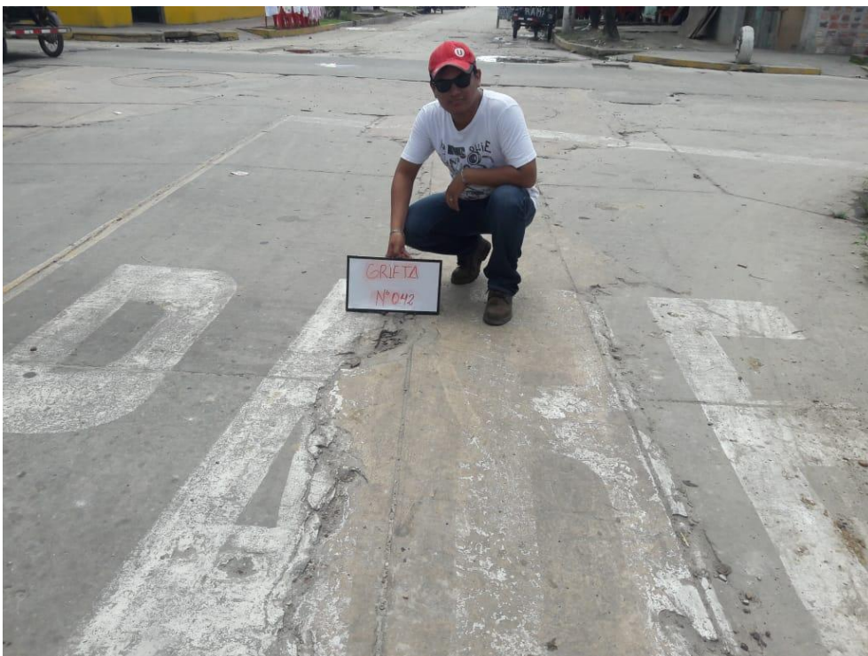
Foto 42 Grieta N° 42 con el tipo de deterioro: Parches deteriorados
