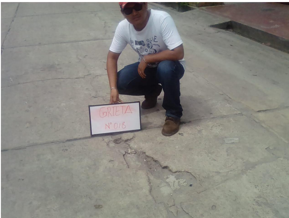
Foto 18 Grieta N° 18 con el tipo de deterioro: Separación de la junta longitudinal
