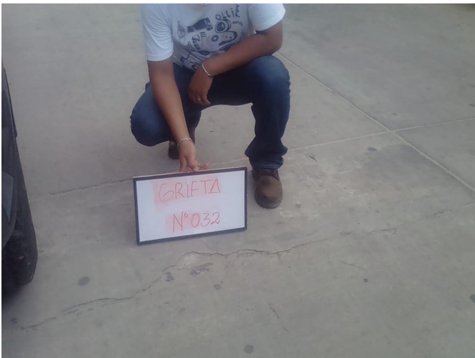
Foto 32 Grieta N° 32 con el tipo de deterioro: Descenso de la berma
