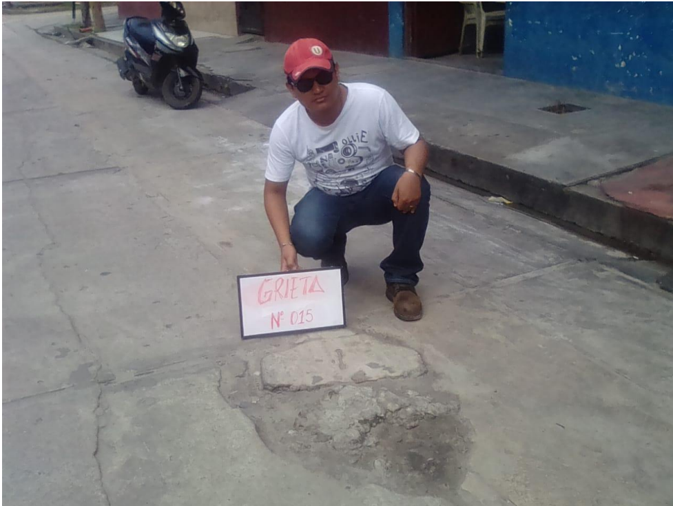
Foto 15 Grieta Nº 15 con el tipo de deterioro: Baches
