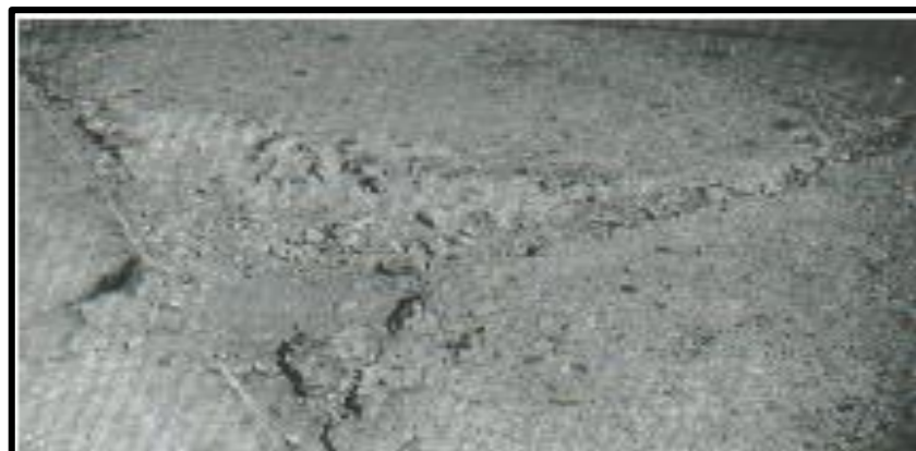
Foto N° 47. Descascaramiento de esquina de alta severidad. Fuente: Pavement Condition Index (PCI).
