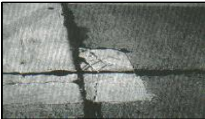
Foto N° 29. Parche pequeño de severidad media. Fuente: Pavement Condition Index (PCI).
