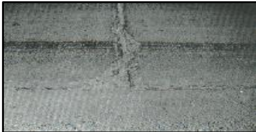
Foto N° 46. Descascaramiento de esquina de severidad media. Fuente: Pavement Condition Index (PCI).
