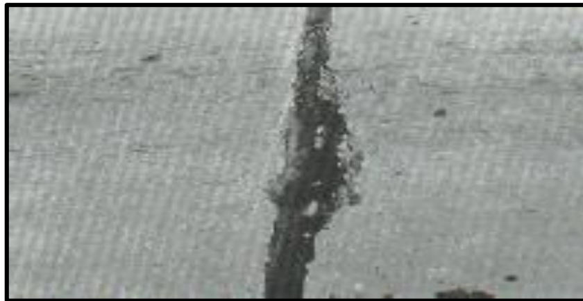
Foto N° 17. Daño del sello de juntas de severidad media. Fuente: Pavement Condition Index (PCI).
