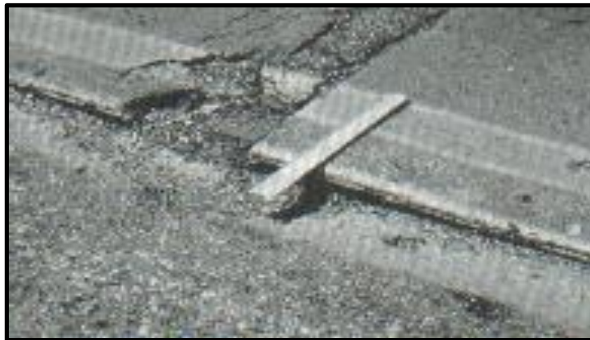
Foto N° 19. Desnivel carril – berma de baja severidad.
