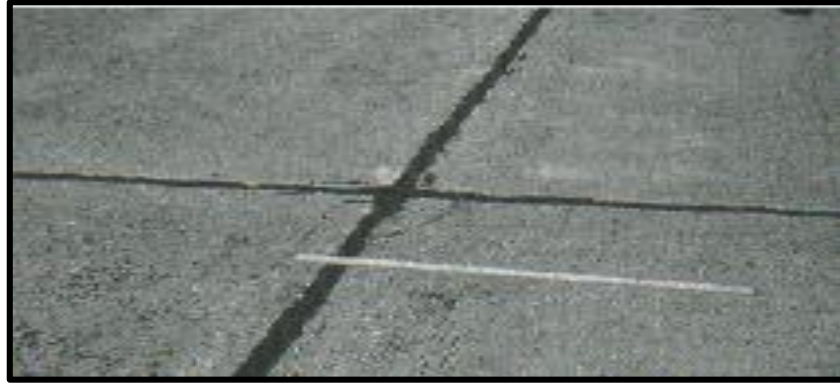
Foto N° 45. Descascaramiento de esquina de baja severidad. Fuente: Pavement Condition Index (PCI).
