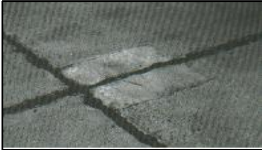
Foto N° 28. Parche pequeño de baja severidad. Fuente: Pavement Condition Index (PCI).
