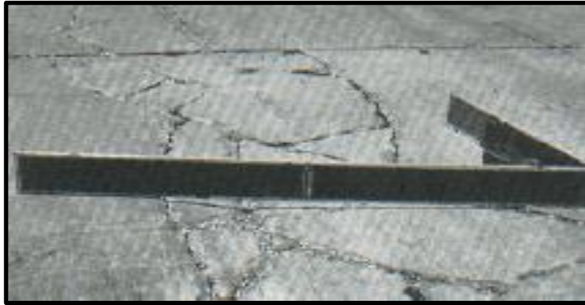
Foto N° 37. Punzonamiento de alta severidad.
