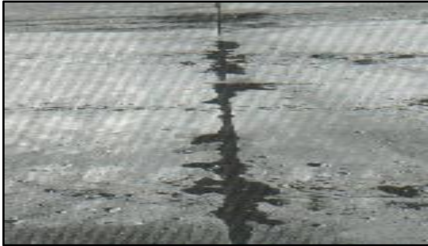
Foto N° 33. Bombeo en una junta. Fuente: Pavement Condition Index (PCI).
