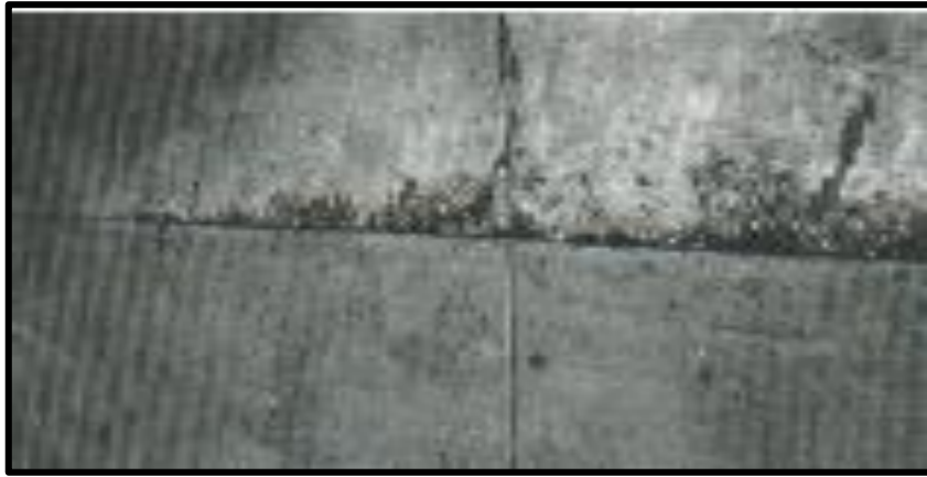
Foto N° 49. Descascaramiento de juntas de severidad media Fuente: Pavement Condition Index (PCI)
