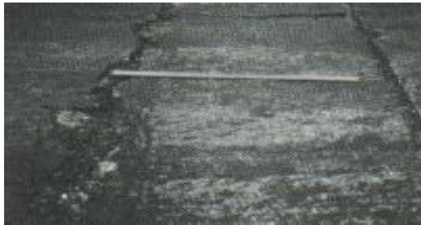
Foto N° 27. Parche grande y acometidas de servicios públicos de alta severidad Fuente: Pavement Condition Index (PCI).
