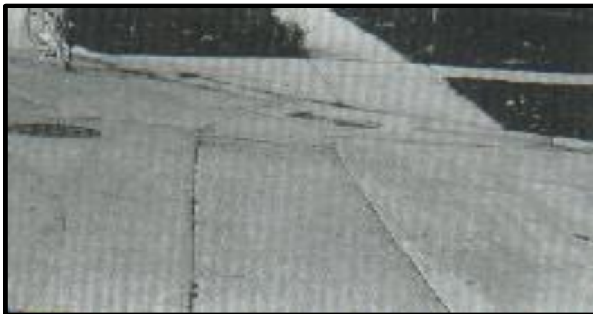
Foto N° 25. Parche grande y acometidas de servicios públicos de baja severidad.
