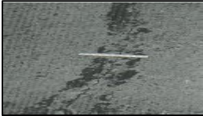
Foto N° 22. Grieta lineales de baja severidad en una losa de concreto simple. Fuente: Pavement Condition Index (PCI).
