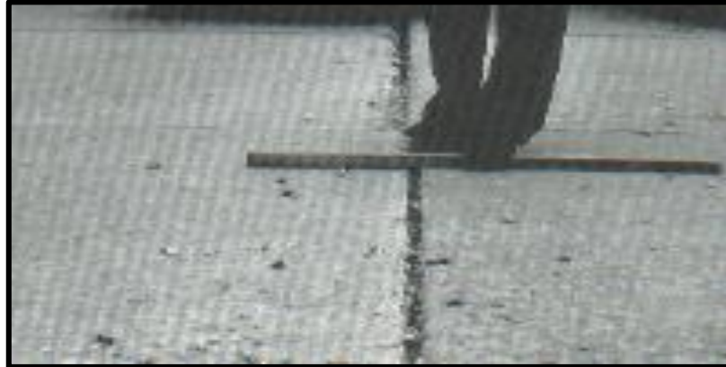
Foto N° 13. Escala de baja severidad.
