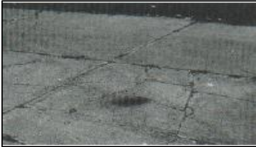
Foto N° 9. Losa Dividida de severidad alta Fuente: Pavement Condition Index (PCI).
