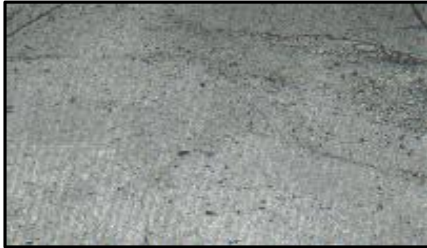
Foto N° 12. Grieta de Durabilidad “D” de alta severidad. Fuente: Pavement Condition Index (PCI).
