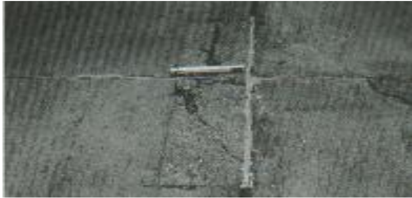
Foto N° 30. Parche pequeño de alta severidad.
