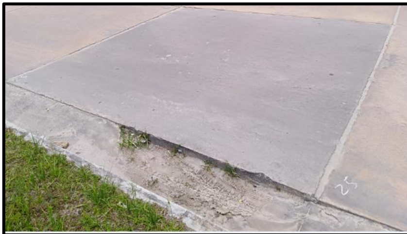
Foto N° 3. Blowup – Buckling (Rotura por Pandeo) de alta severidad. Fuente: Pavement Condition Index (PCI).
