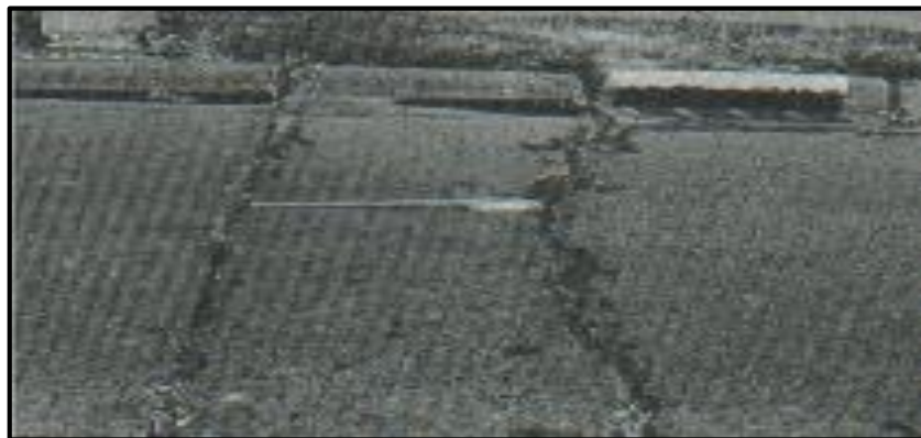
Foto N° 35. Punzonamiento de baja severidad.
