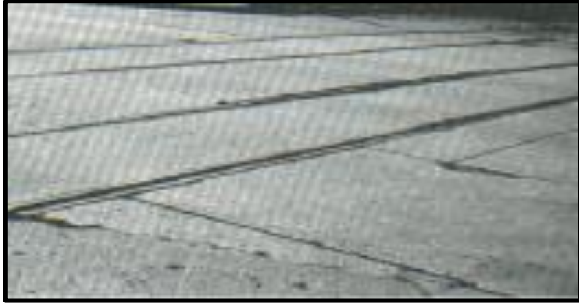
Foto N° 38. Cruces de vía férrea de baja severidad. Fuente: Pavement Condition Index (PCI).
