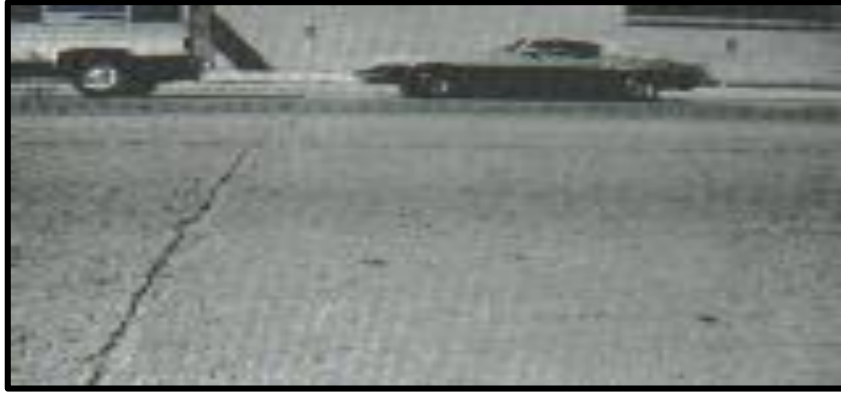
Foto N° 48. Descascaramiento de juntas de baja severidad. Fuente: Pavement Condition Index (PCI).
