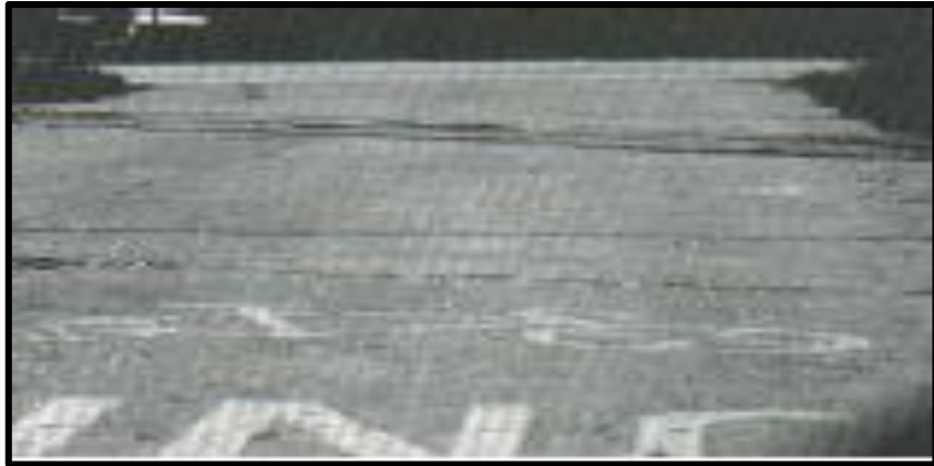
Foto N° 39. Cruces de vía férrea de severidad media. Fuente: Pavement Condition Index (PCI).
