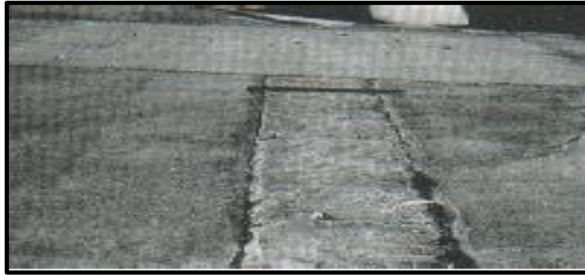
Foto N° 26. Parche grande y acometidas de servicios públicos de severidad media. Fuente: Pavement Condition Index (PCI).
