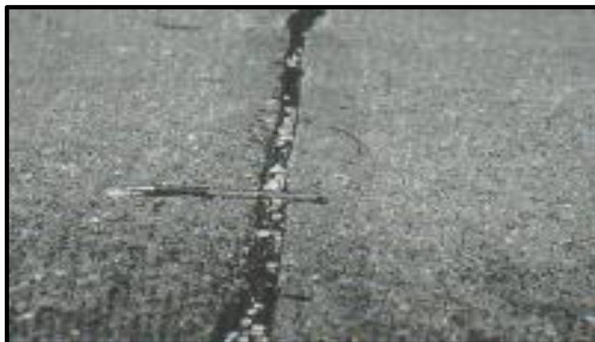
Foto N° 18. Daño del sello de juntas de alta severidad. Fuente: Pavement Condition Index (PCI).
