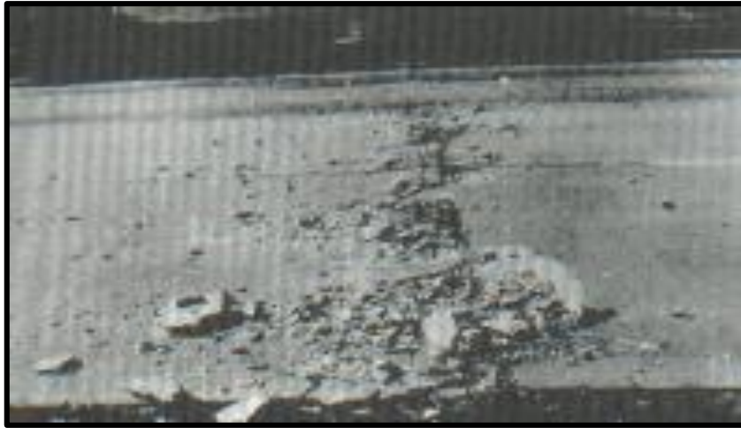
Foto N° 2. Blowup – Buckling (Rotura por Pandeo) de media severidad. Fuente: Pavement Condition Index (PCI).
