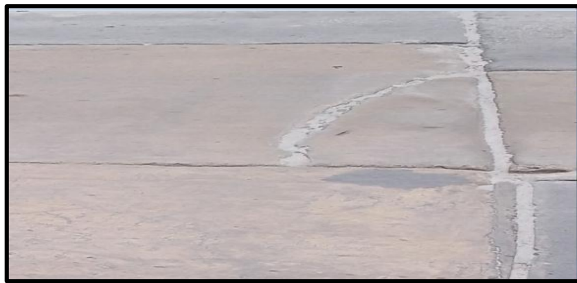
Foto N° 6. Grieta de Esquina de alta severidad.
