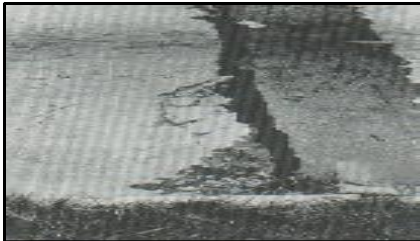
Foto N° 1. Blowup - Buckling (Rotura por Pandeo) de baja severidad Fuente: Pavement Condition Index (PCI).
