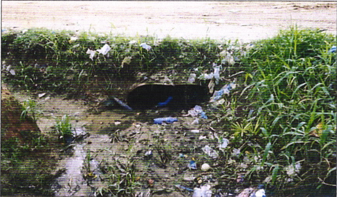
Alcantarilla deteriorada en la progresiva 0+010.
