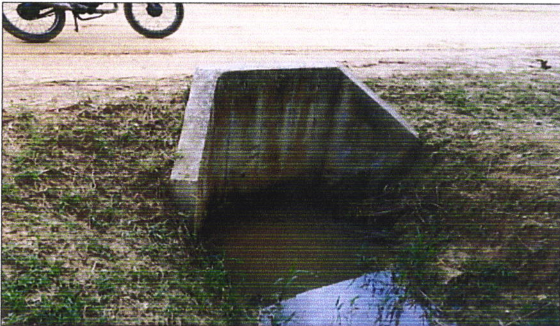
Alcantarilla marco C°A° en la progresiva 3+900, se proyecta cambiar.
