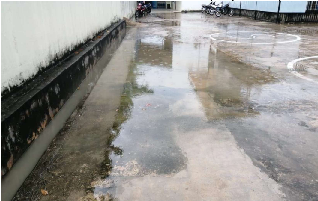
Figura 5. Se observa la problemática que tiene la playa de estacionamiento de la Universidad Científica del Perú durante las precipitaciones pluviales.
