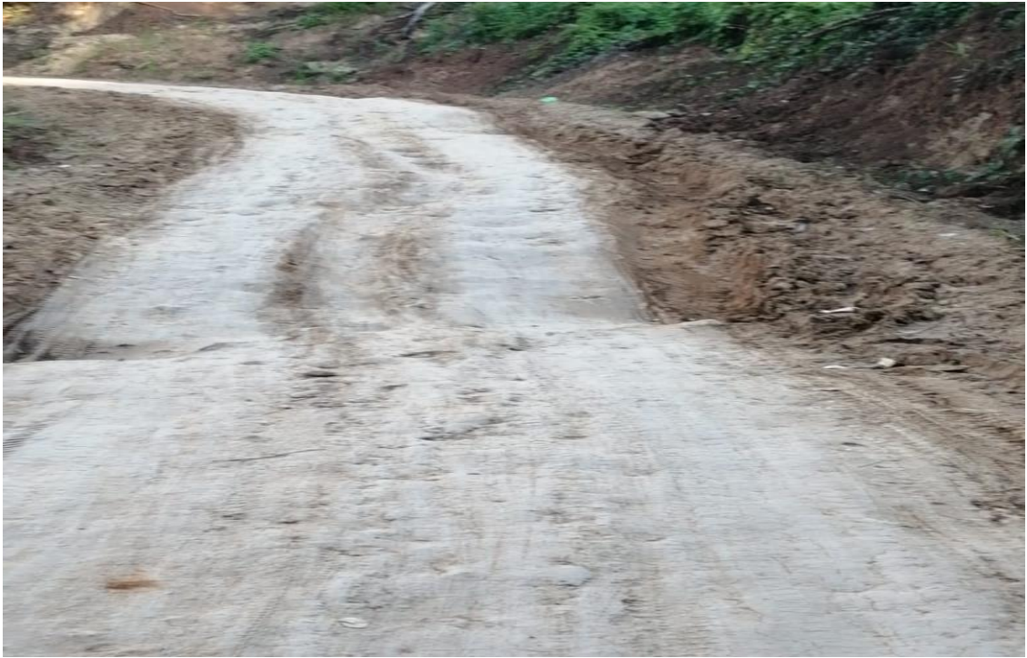
FOTO N°07: EN LA FOTOGRAFÍA SE APRECIA LA PLATAFORMA TOTALMENTE DEFORMADA.
