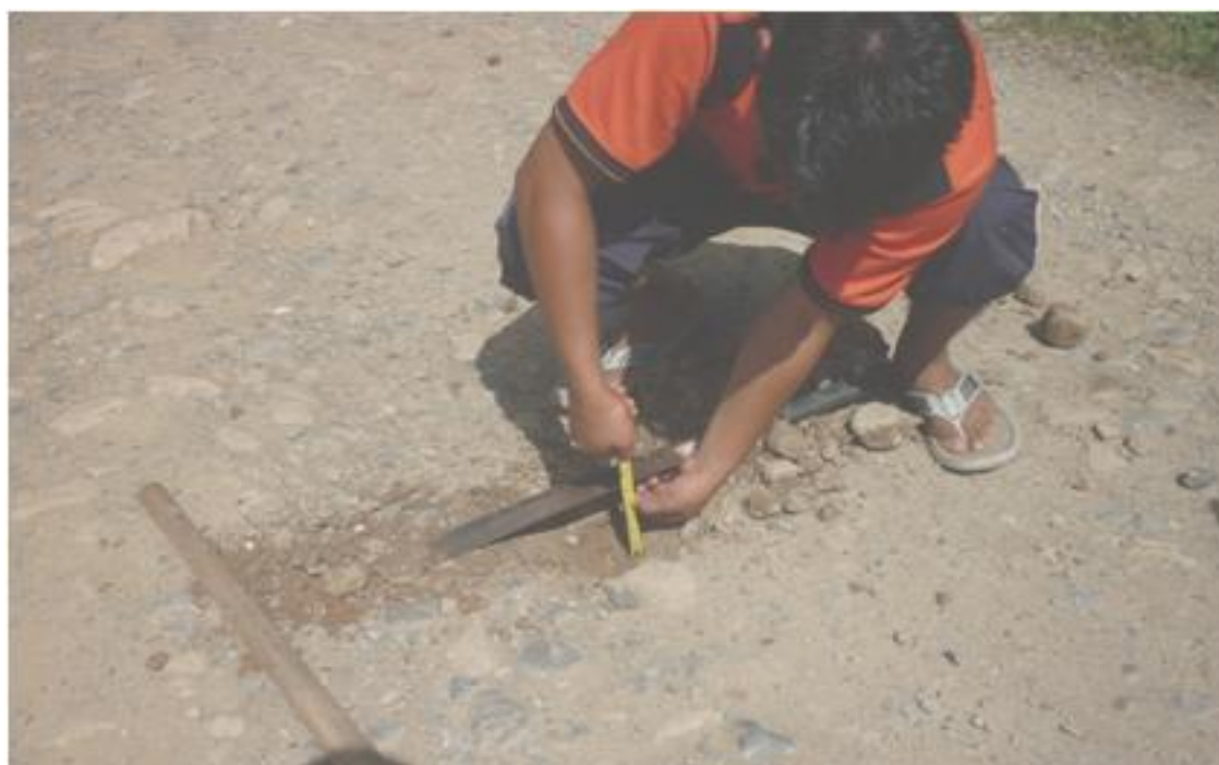
FOTO N°02: EN LA FOTO SE OBSERVA LA DETERMINACION DEL ESPESOR DE LA CAPA DE AFIRMADO, EN LA CUAL SE VERIFICA QUE LA CALZADA DE RODADURA ESTA DETERIORADA.
