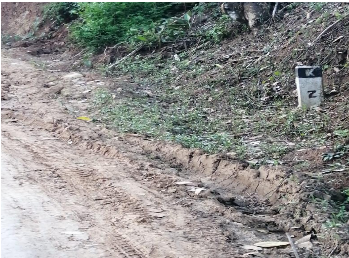
FOTO N°08: SE OBSERVA LA PLATAFORMA TOTALMENTE DEFORMADA Y CON AHUELLAMIENTO DEBIDO A LA AUSENCIA DEL MATERIAL DE AFIRMADO.
