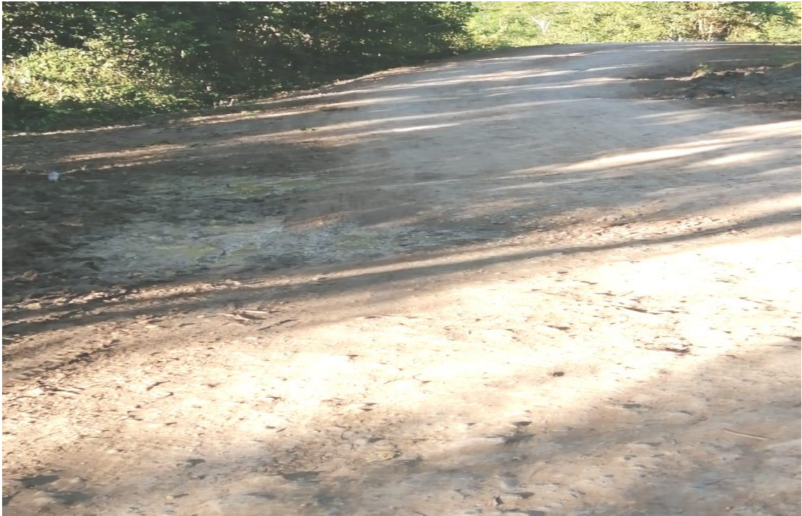
FOTO N°09: SE OBSERVA LA PLATAFORMA TOTALMENTE DETERORRADA, PARA REPOSICIÓN MATERIAL.
