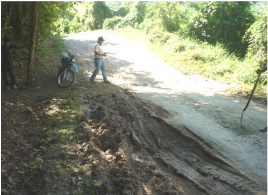
FOTO N°04: EN LA FOTO SE OBSERVA LA TOPOGRAFIA DEL TERRENO ONDULADO CON DETERIORO DE LA PLATAFORMA.
