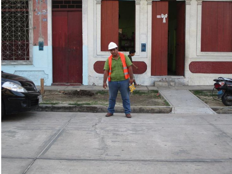
Figura N° 03: Se observa grieta lineal de severidad media.
