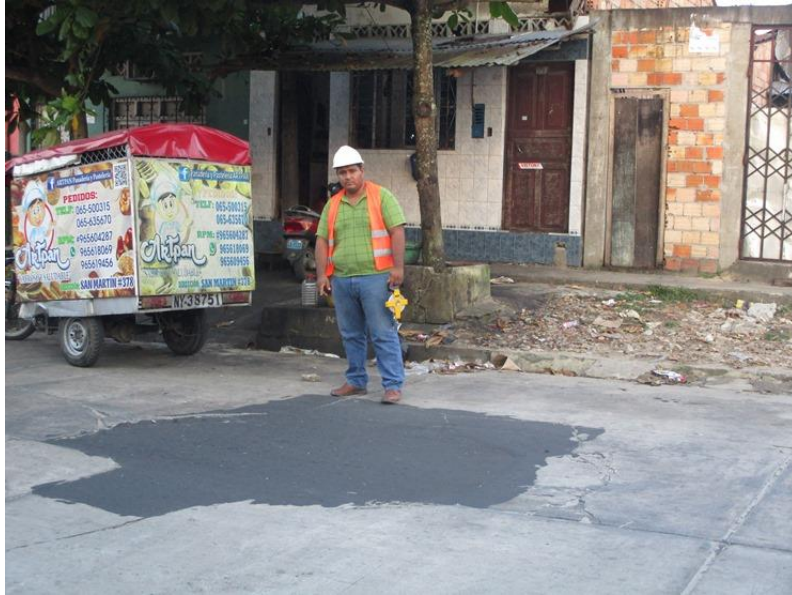
Figura N° 09: Se observa parcheo grande de severidad alta.
