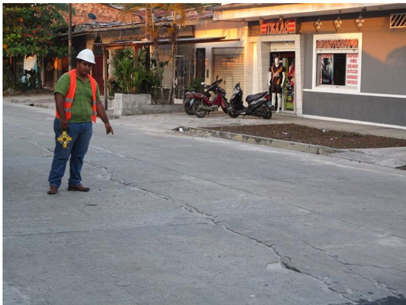
Figura N° 12: Se observa grieta lineal de severidad alta.
