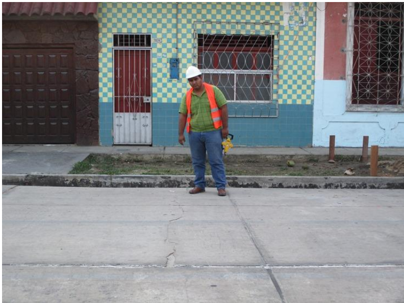
Figura N° 04: Se observa grieta lineal de severidad media.
