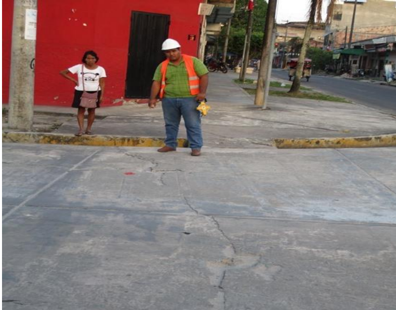
Figura N° 01: Se observa grieta lineal de severidad alta.
