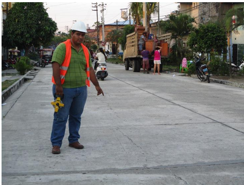
Figura N° 14: Se observa grieta lineal de severidad media.
