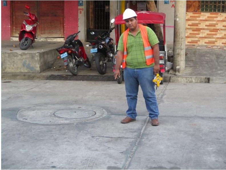
Figura N° 07: Se observa grieta de esquina de severidad media.
