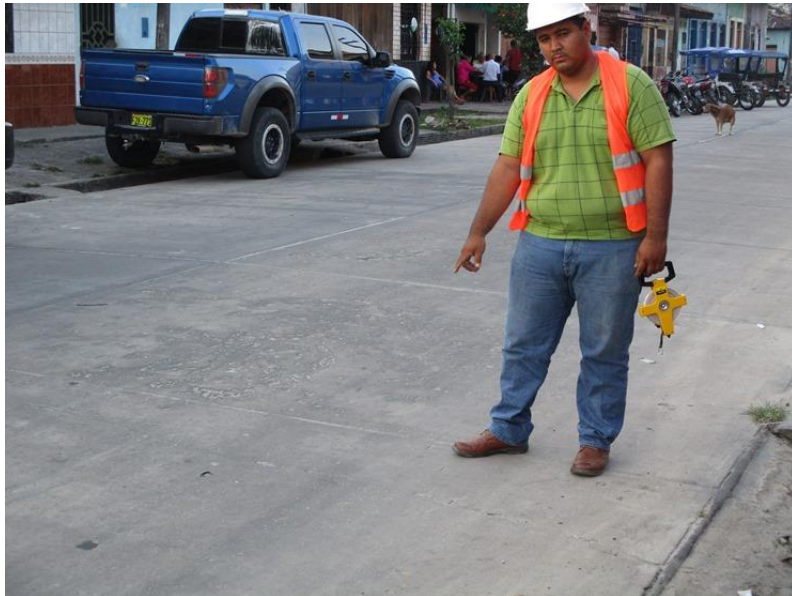
Figura N° 11: Se observa punzonamiento de severidad media.
