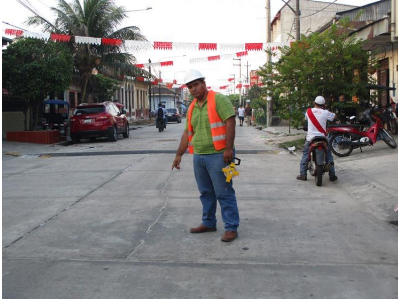
Figura N° 05: Se observa grieta lineal de severidad alta.
