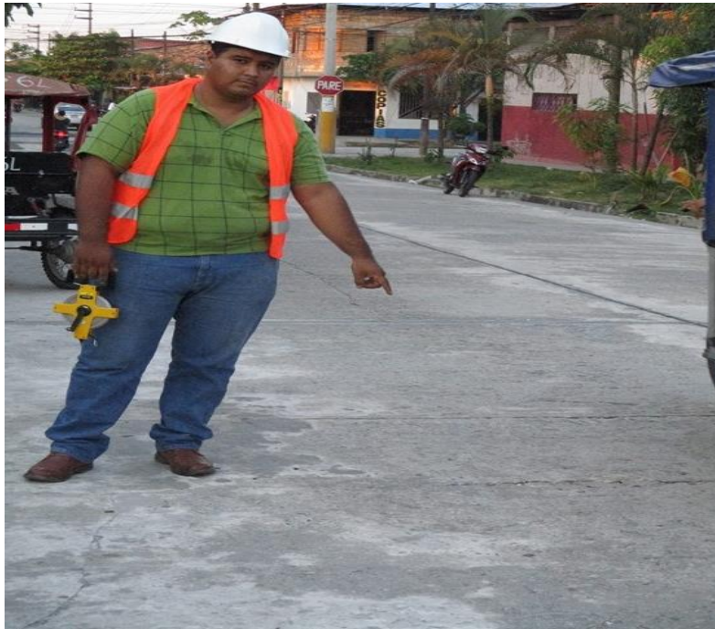
Figura N° 13: Se observa grieta lineal de severidad alta.
