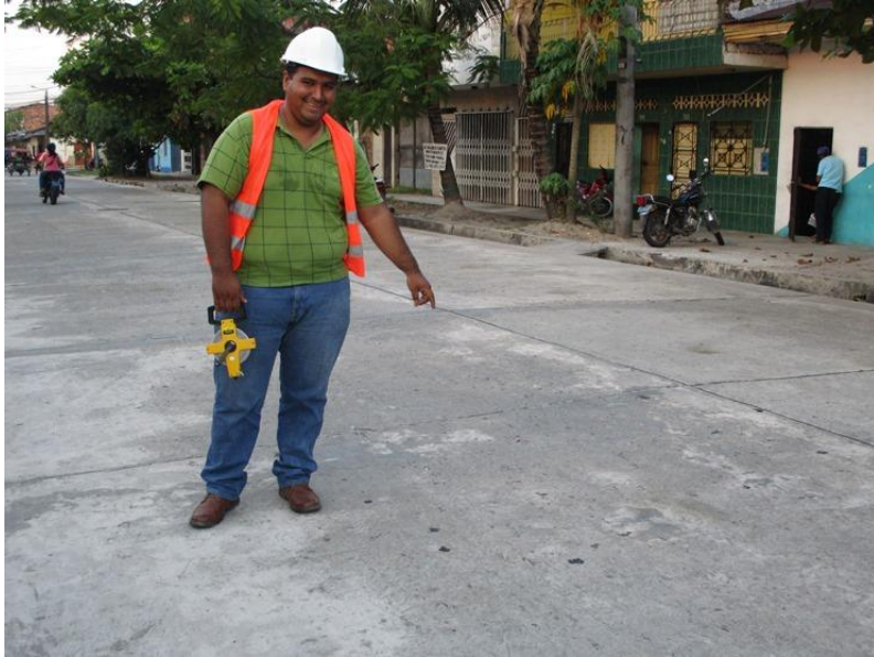
Figura N° 15: Se observa pulimiento de agregado .
