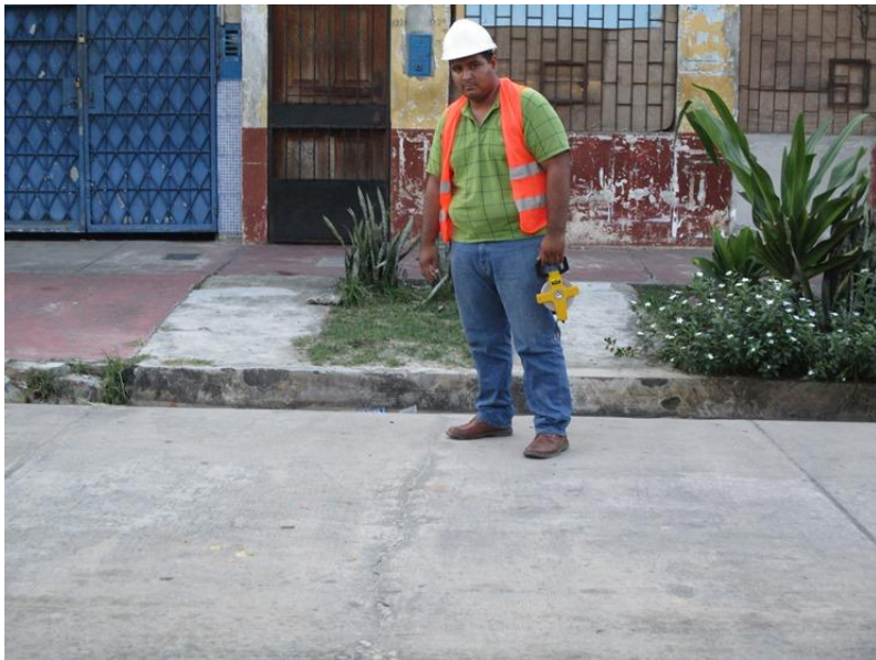
Figura N° 08: Se observa grieta lineal de severidad media.
