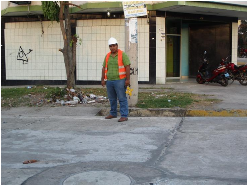
Figura N° 16: Se observa desconchamiento de severidad alta.
