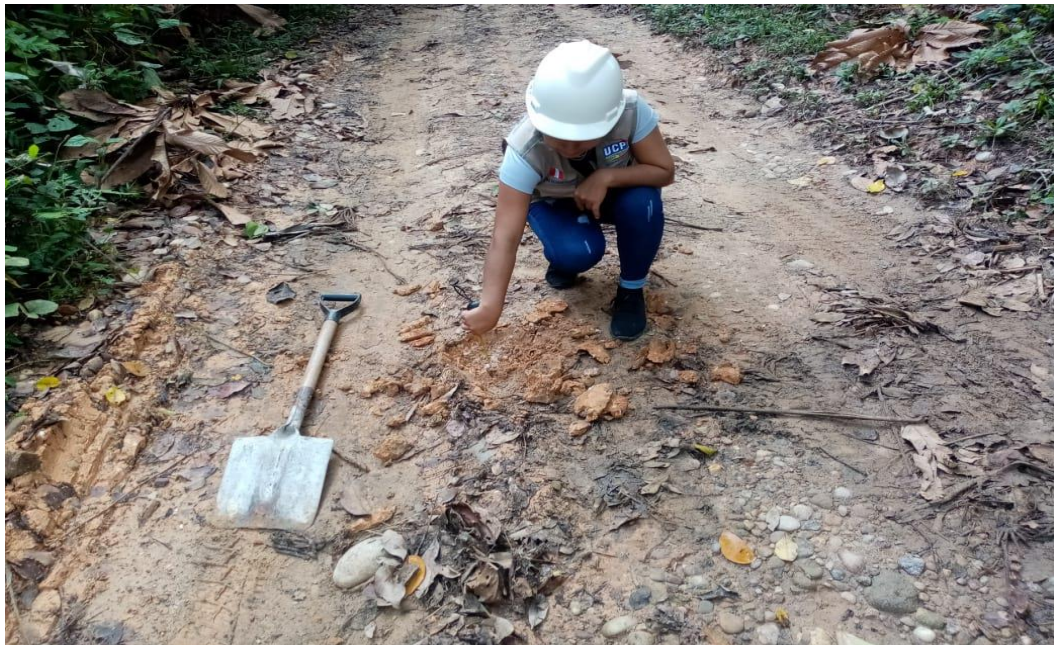
Foto 6: Determinación del espesor de la capa de afirmado, en la cual se verifica que la calzada de rodadura está deteriorada.
