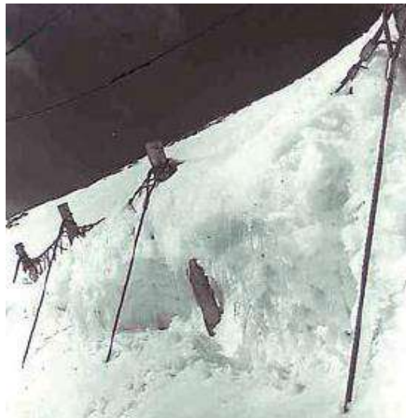
Figura 02. Barrera a base de red de cable para control de avalanchas.
