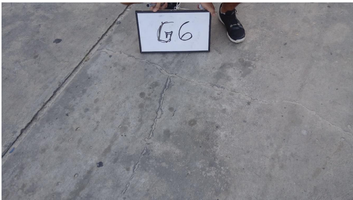
Foto 6 Fisura N° 6 con deterioro: Grietas longitudinales y transversales, está ubicada en la progresiva 0 + 151m.
