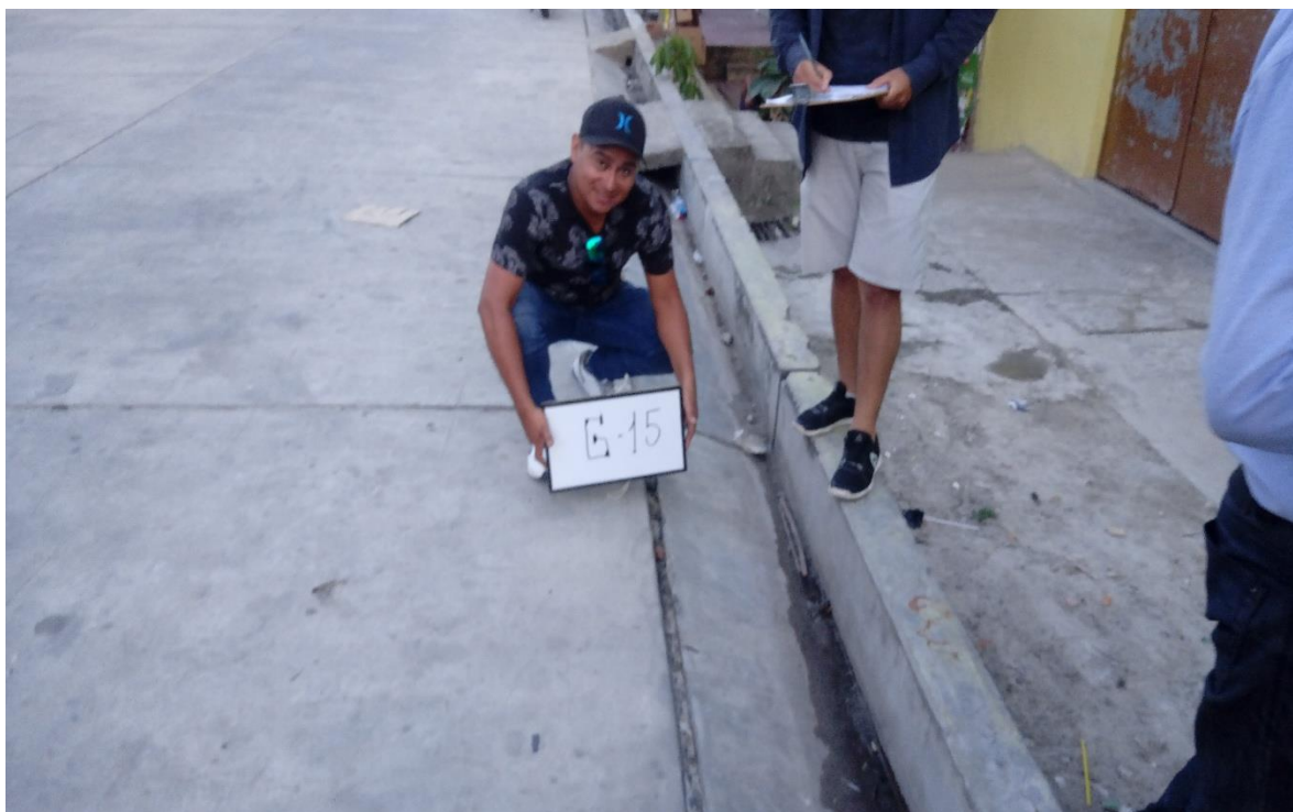
Foto 15 Fisura N° 15 con deterioro: Separación de la junta longitudinal, está ubicada en la progresiva 0 + 322m.
