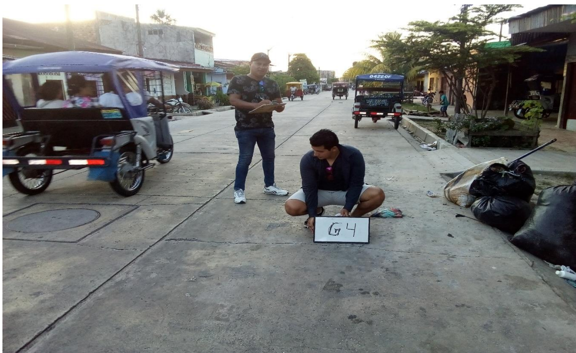
Foto 4 Fisura N° 4 con deterioro: Grietas longitudinales y transversales, está ubicada en la progresiva 0 + 62,19m.
