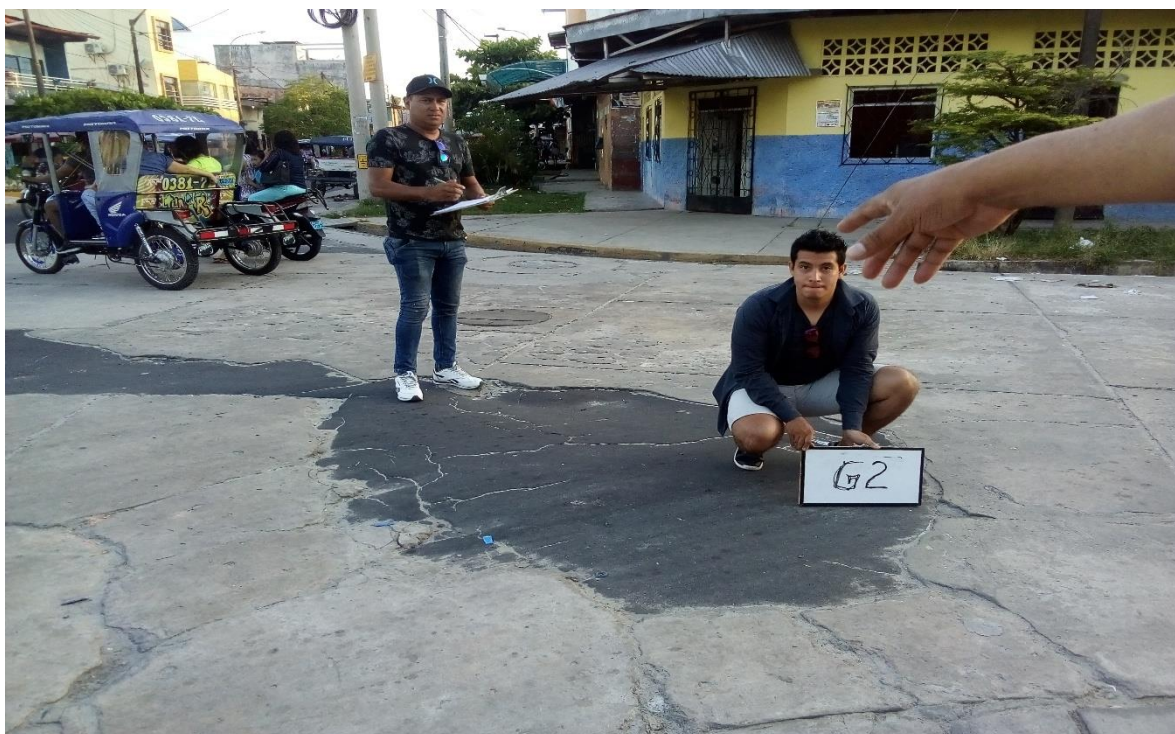
Foto 2 Fisura N° 2 con deterioro: Grietas de esquina, está ubicada en la progresiva 0 + 22,52m.
