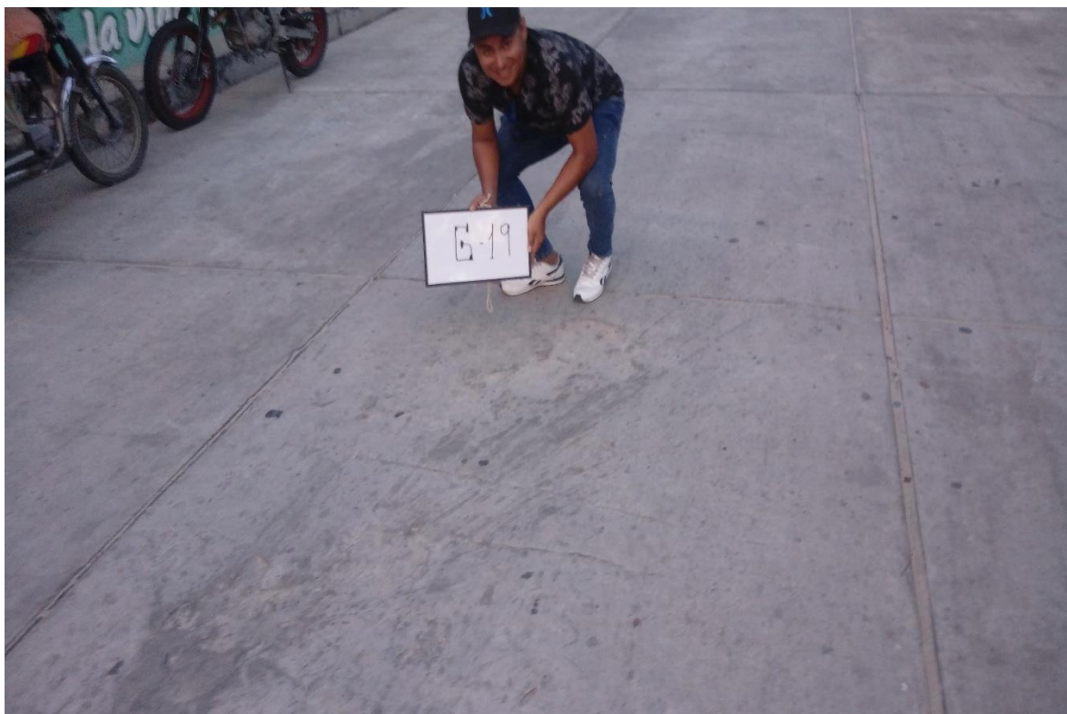
Foto 19 Fisura N° 19 con deterioro: Parches deteriorados, está ubicada en la progresiva 0 + 415,8m.
