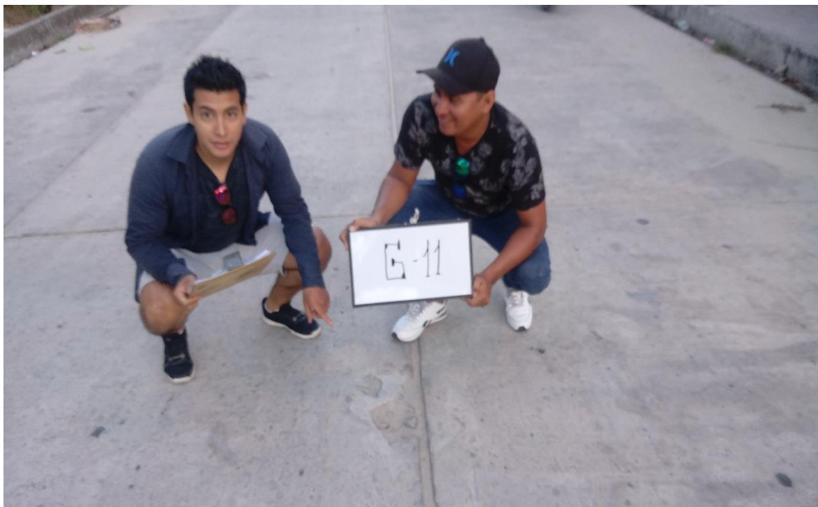
Foto 11 Fisura N° 11 con deterioro: Fisuramiento por retracción (tipo malla), está ubicada en la progresiva 0 + 247m.
