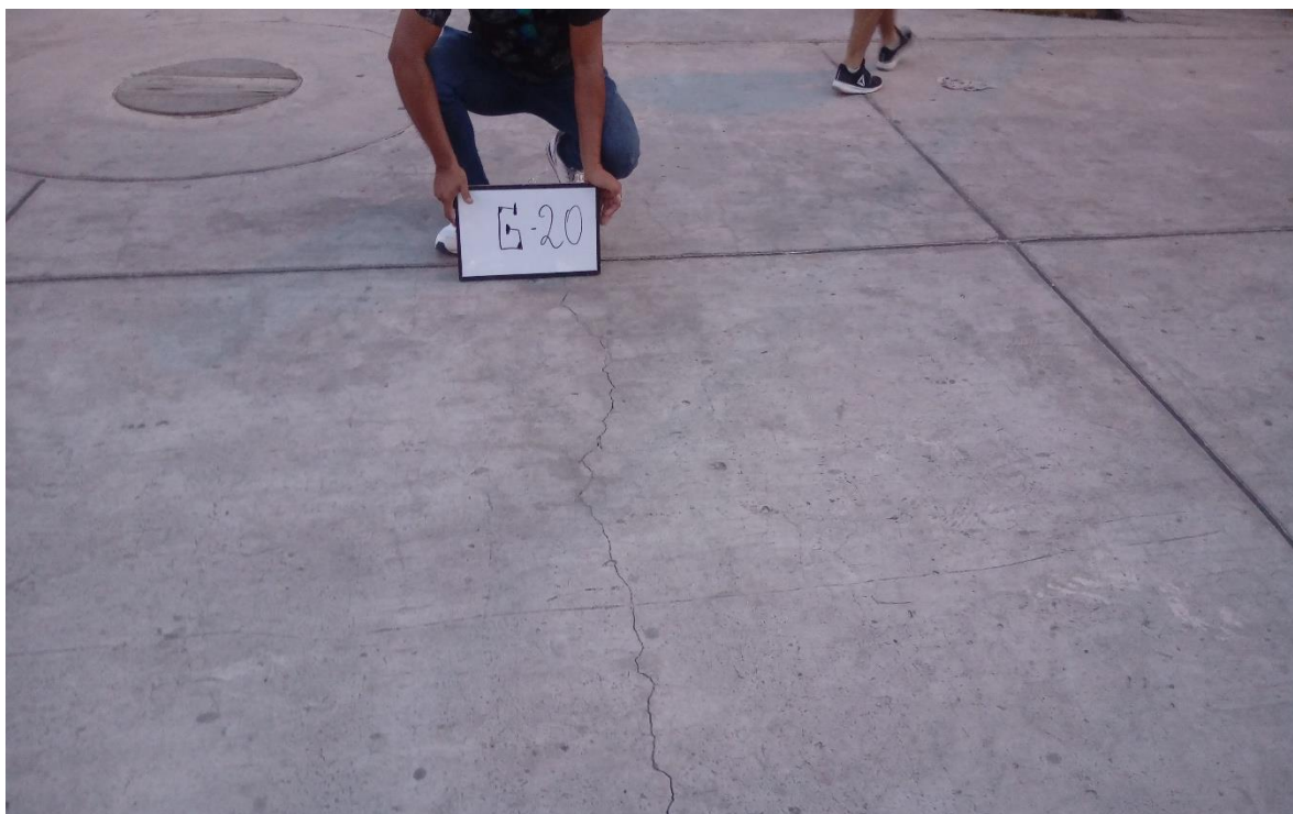
Foto 20 Fisura N° 20 con deterioro: Juntas saltadas, está ubicada en la progresiva 0 + 456m.
