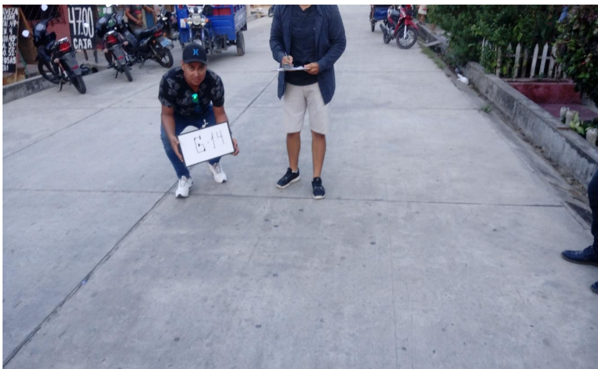
Foto 14 Fisura N° 14 con deterioro: Grietas longitudinales y transversales, está ubicada en la progresiva 0 + 304,4m.
