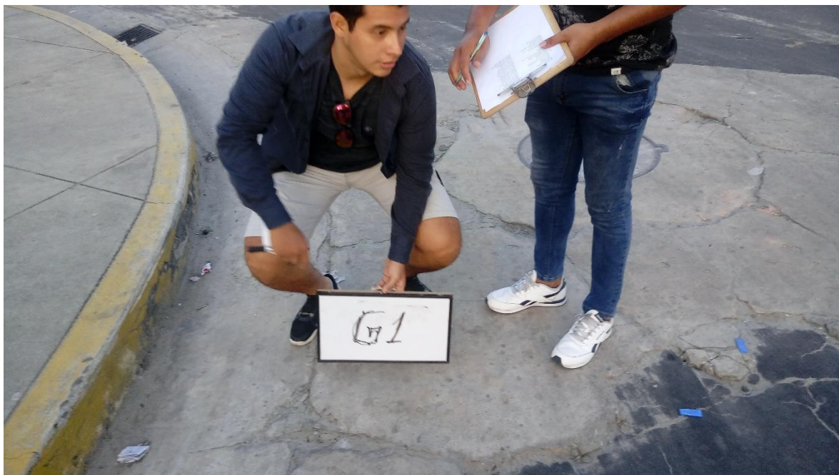
Foto 1 Grieta N° 1 con deterioro: Grietas de esquina, está ubicada en la progresiva 0 + 1,74m.
