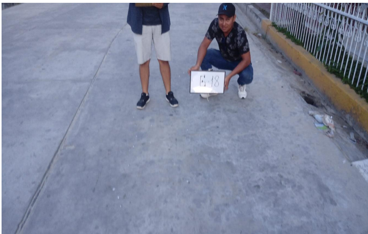
Foto 18 Fisura N° 18 con deterioro: Escalonamiento de juntas y grietas, está ubicada en la progresiva 0 + 402m.
