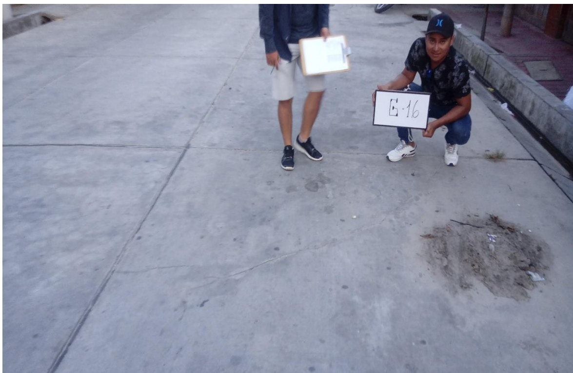
Foto 16 Grieta N° 16 con deterioro: Grietas longitudinales y transversales, está ubicada en la progresiva 0 + 346m.
