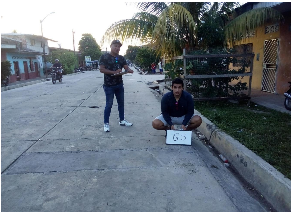
Foto 5 Grieta N° 5 con deterioro: Descenso de la berma, está ubicada en la progresiva 0 + 140m.
