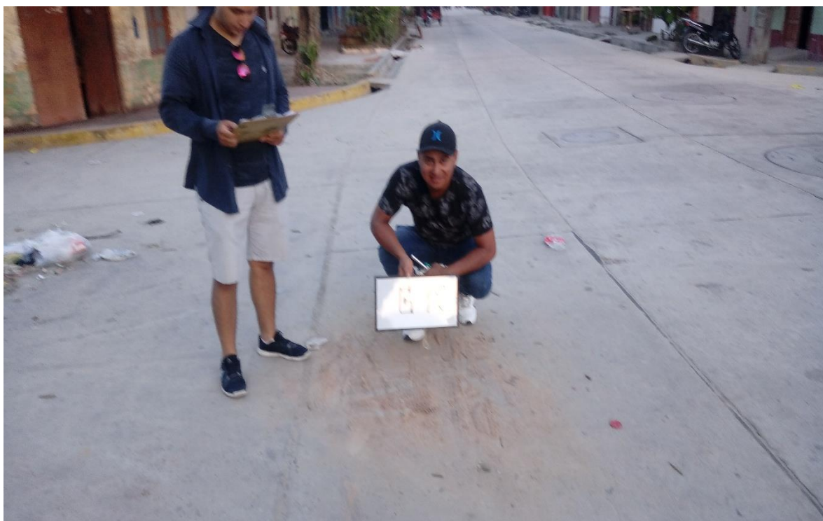
Foto 12 Fisura N° 12 con deterioro: Baches, está ubicada en la progresiva 0 + 270,2m.
