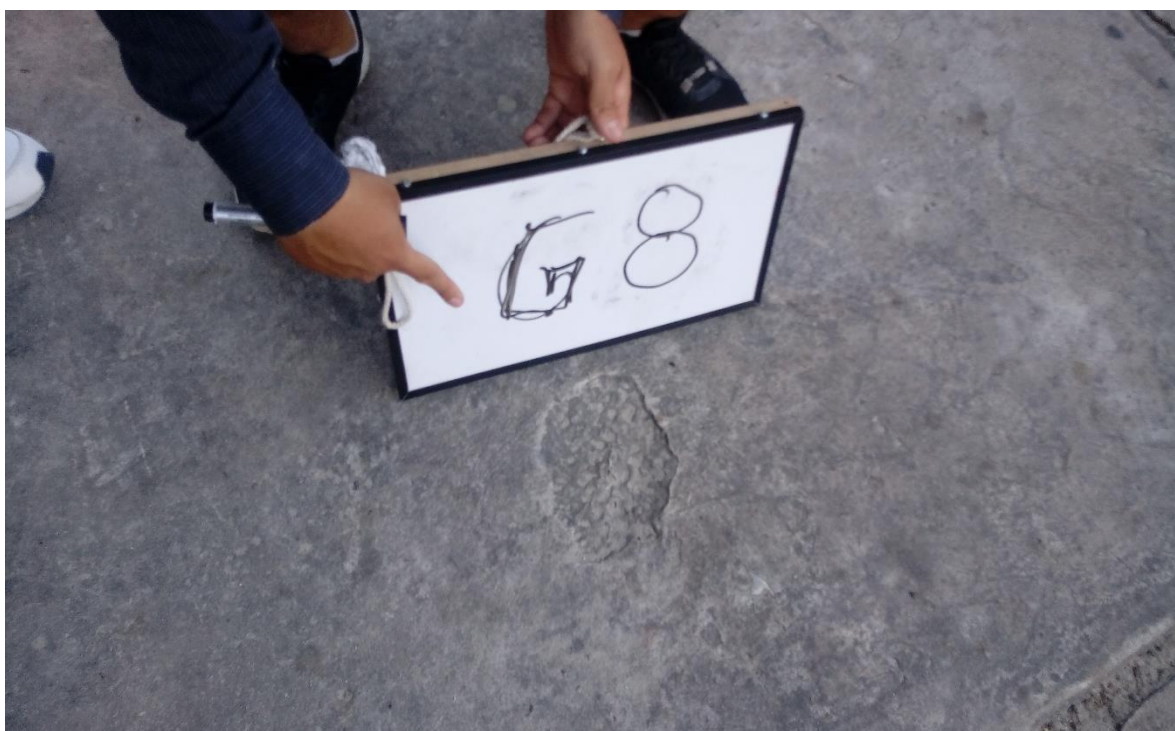
Foto 8 Grieta N° 8 con deterioro: Desintegración, está ubicada en la progresiva 0 + 198m.
