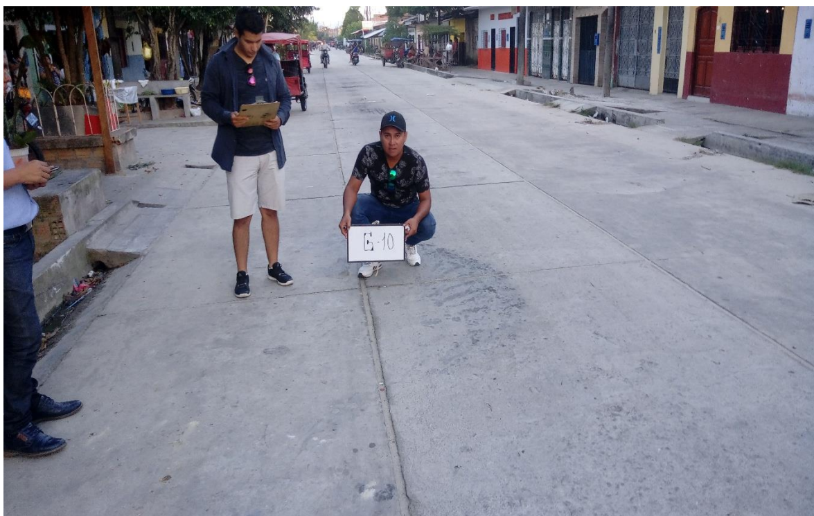
Foto 10 Fisura N° 10 con deterioro: Separación de la junta longitudinal, está ubicada en la progresiva 0 + 237,4m.
