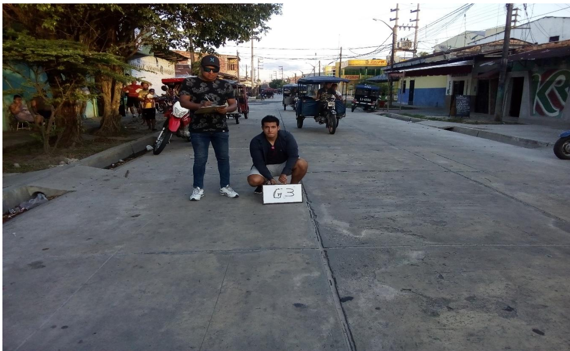
Foto 3 Fisura N° 3 con deterioro: Grietas longitudinales y transversales, está ubicada en la progresiva 0 + 44,46m.
