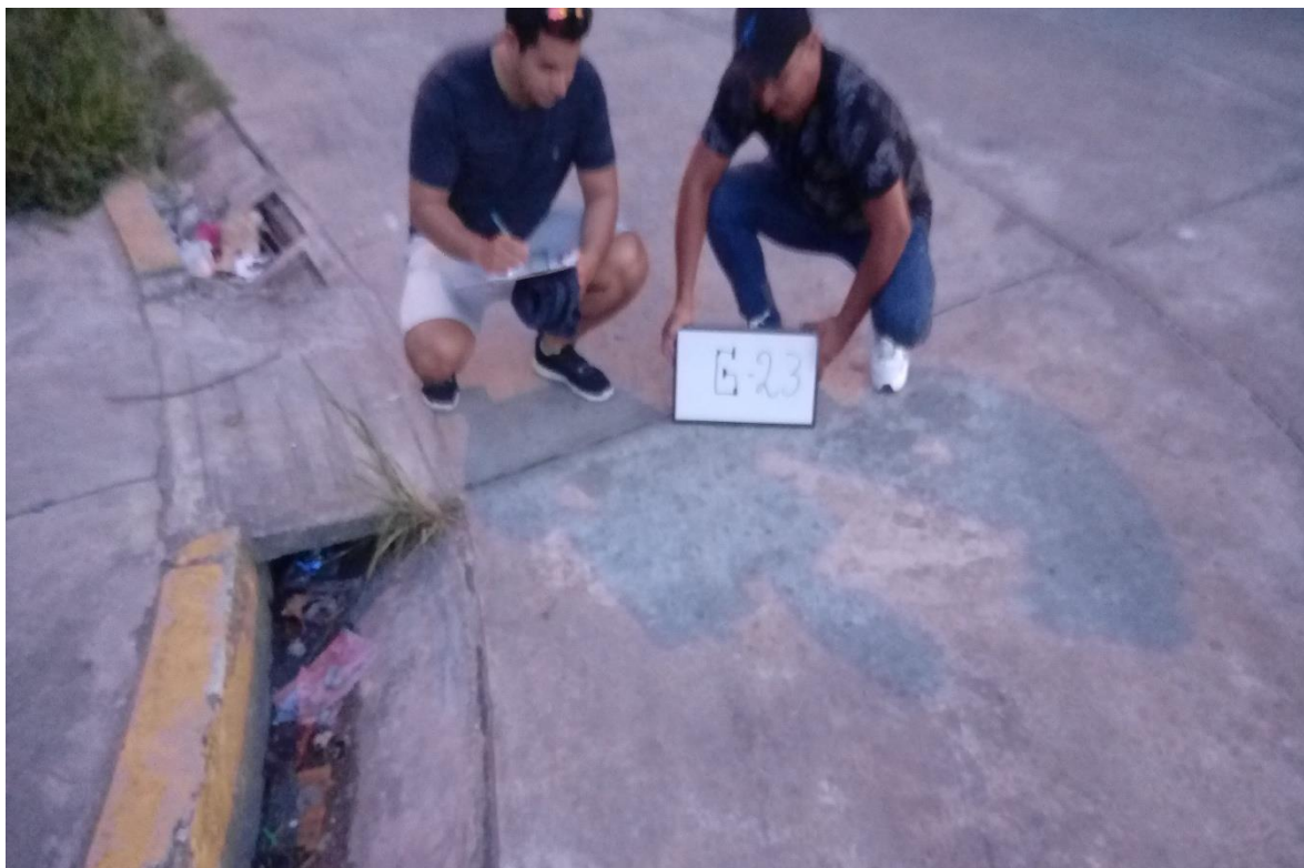
Foto 23 Grieta N° 23 con deterioro: Surgencia de finos, está ubicada en la progresiva 0 + 535,2m.
