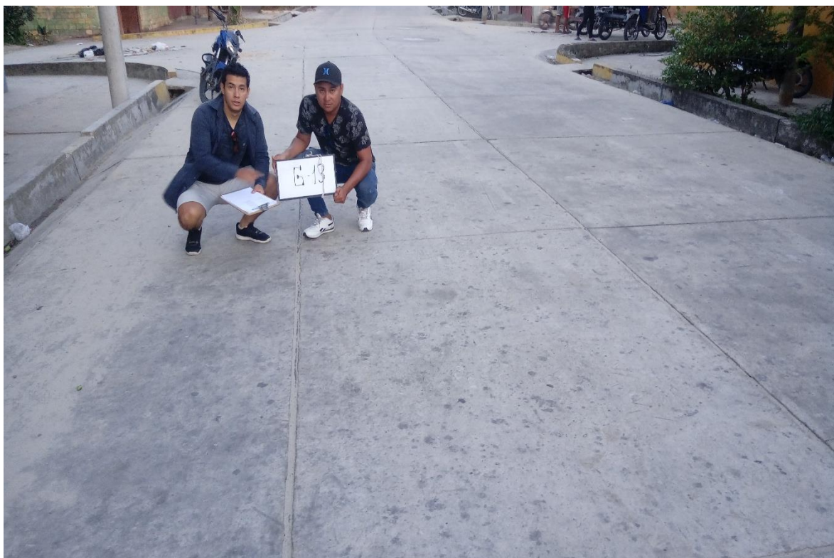
Foto 13 Fisura N° 13 con deterioro: Levantamiento localizado, está ubicada en la progresiva 0 + 287,2m.
