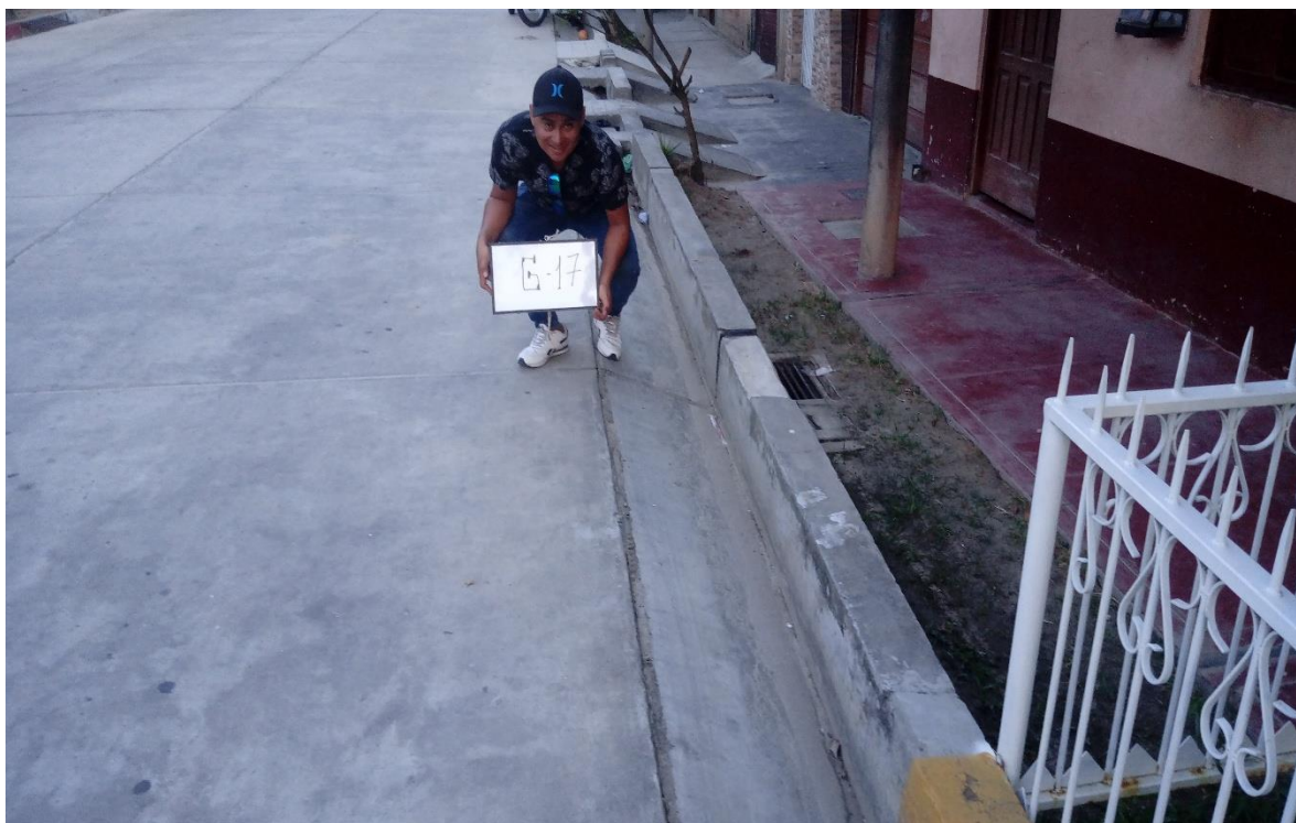
Foto 17 Fisura N° 17 con deterioro: Separación entre berma y pavimento, está ubicada en la progresiva 0 + 392,4m.
