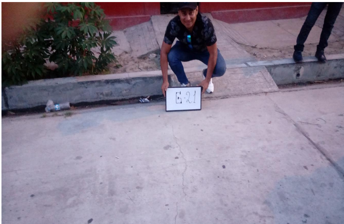
Foto 21 Fisura N° 21 con deterioro: Descenso de la berma, está ubicada en la progresiva 0 + 467m.
