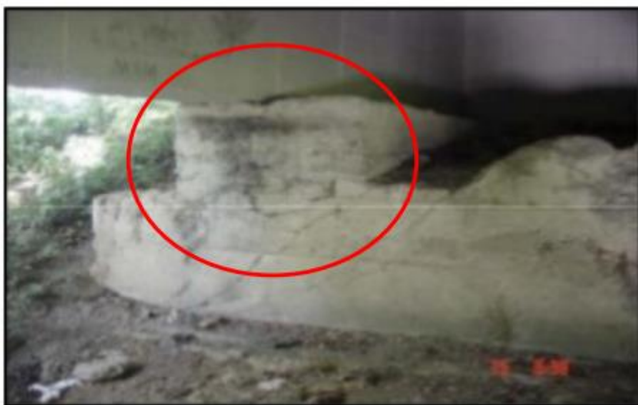
Ilustración 6: Aplastamiento en pilares
