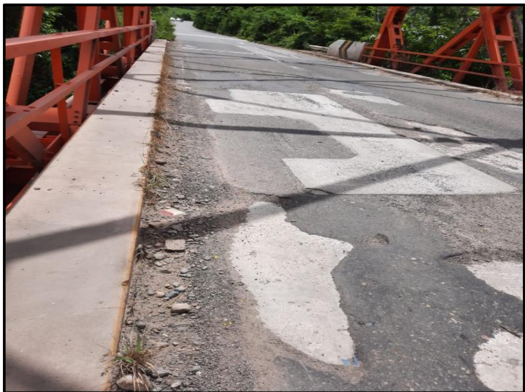
Foto N°24: Se aprecia el estado de la Carpeta de rodadura y vereda
