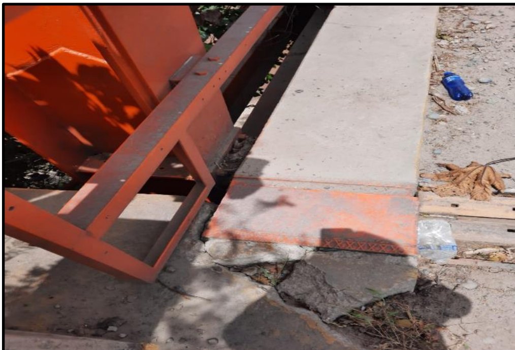
Foto N°29: Se aprecia el estado de la vereda lado izquierdo.
