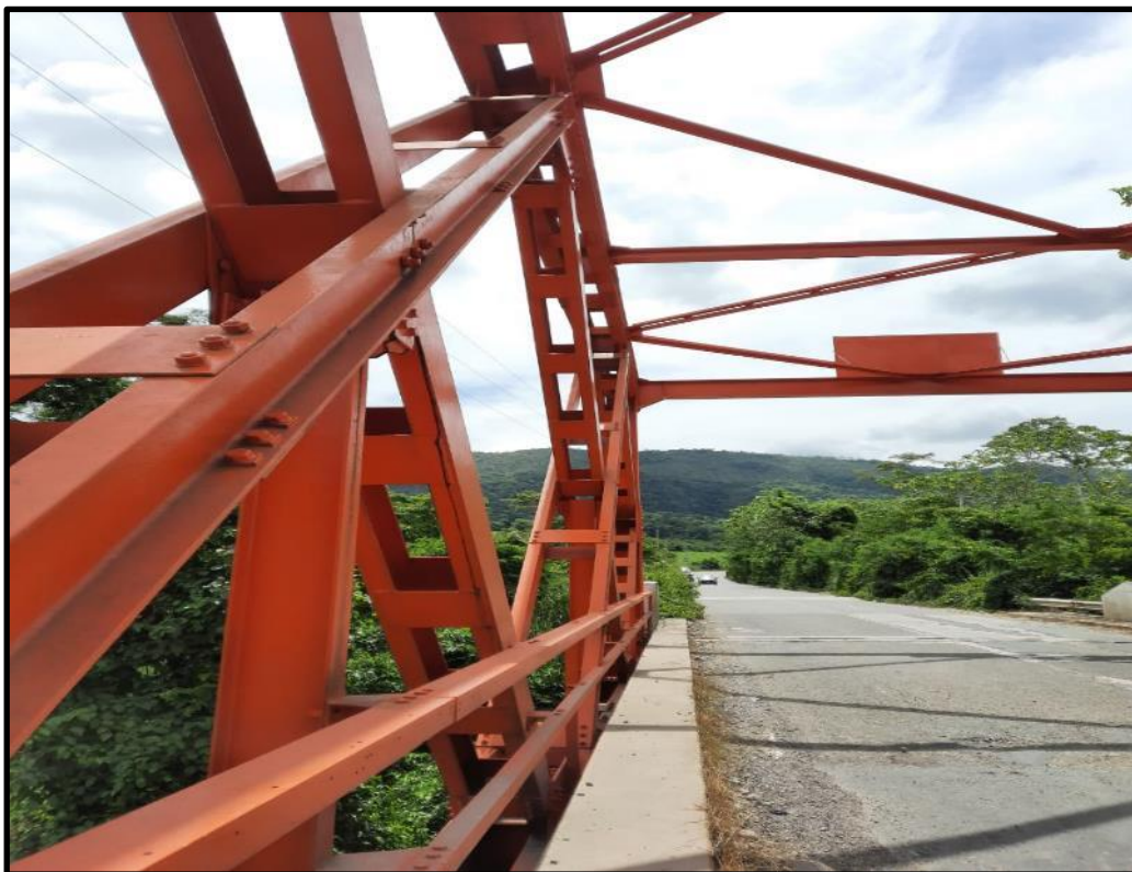
Foto N°25: Se aprecia el estado de la Carpeta de rodadura y vereda
