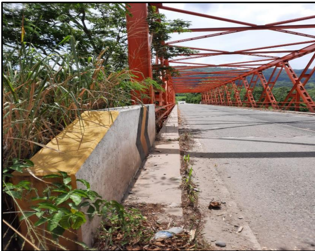
Foto N°03: Se aprecia el estado actual de guardavia y vereda - Lado izquierdo
