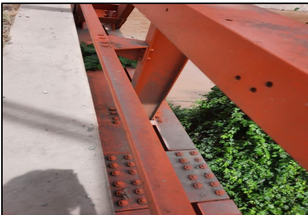
Foto N°31: Se aprecia el estado actual de los empalmes metálicos
