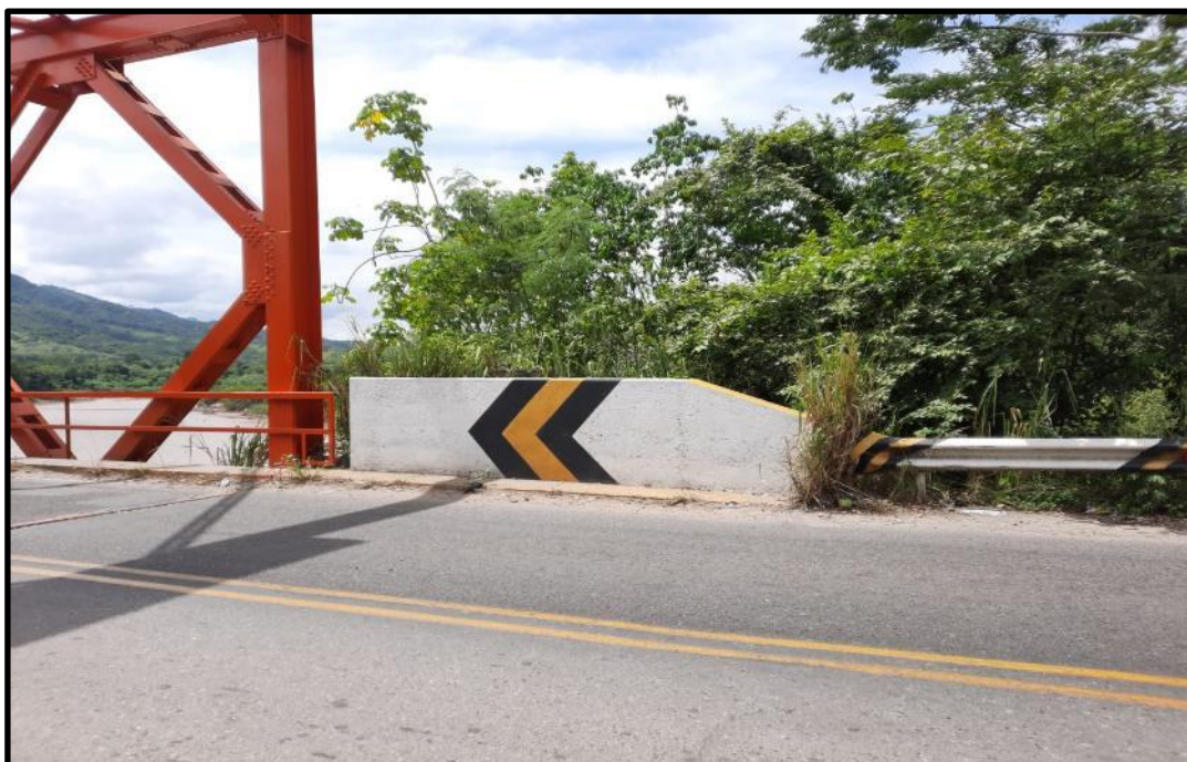
Foto N°04: Se aprecia el estado actual de guardavia y vereda - Lado derecho
