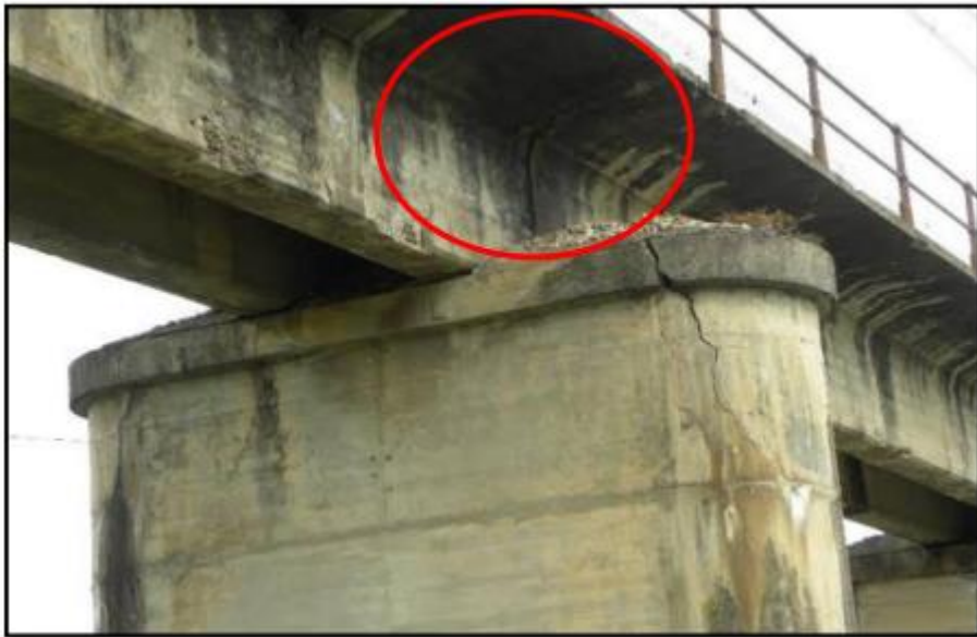
Ilustración 9: Eflorescencia en pilares y plataforma del puente
