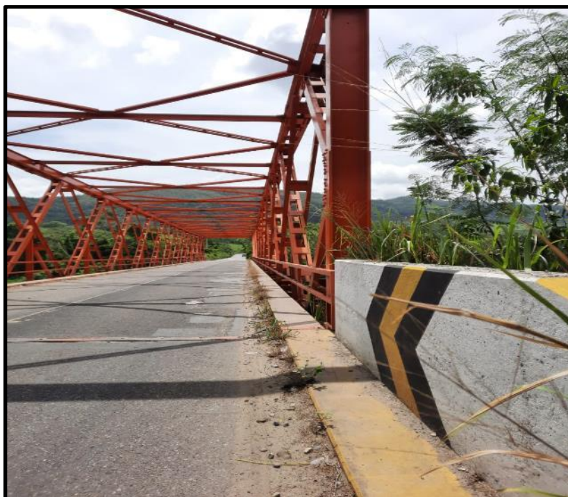
Foto N°02: Se aprecia la guardavía lateral - Lado derecho
