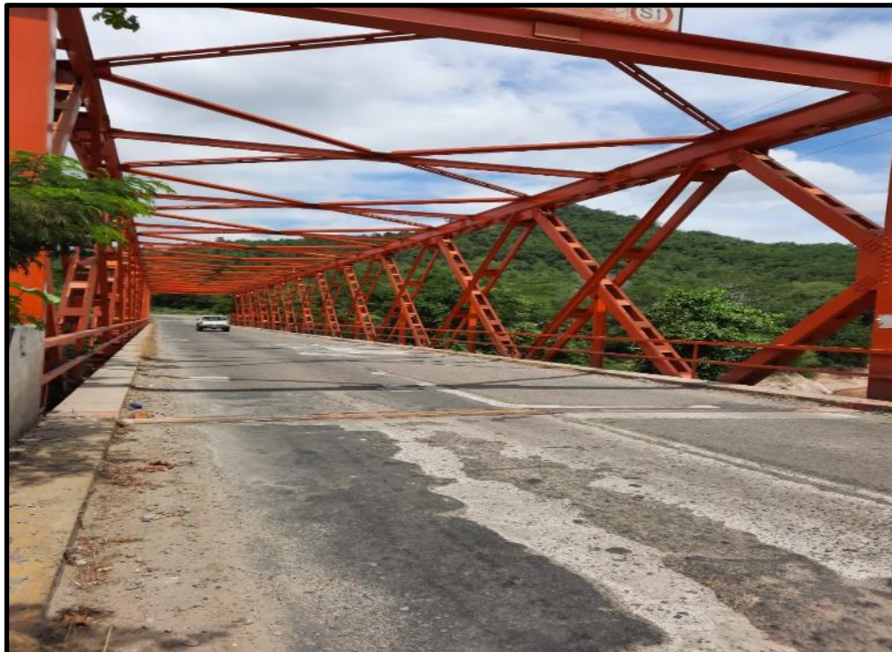
Foto N°28: Se aprecia el estado de la carpeta de rodadura y secciones metálicas
