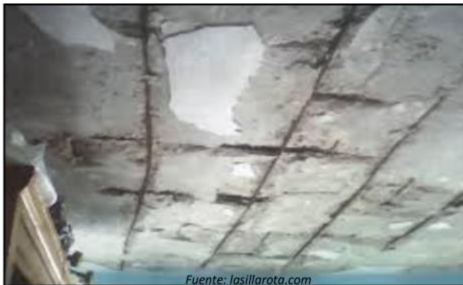
Ilustración 7: Desconchamientos losa de acercamiento
