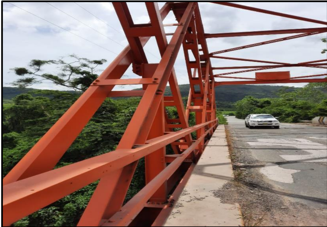
Foto N°23: Se aprecia el estado de la Carpeta de rodadura
