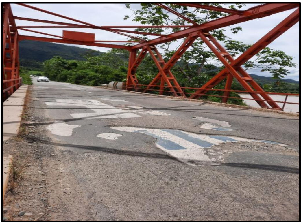
Foto N°22: Se aprecia el estado de la Carpeta de rodadura.
