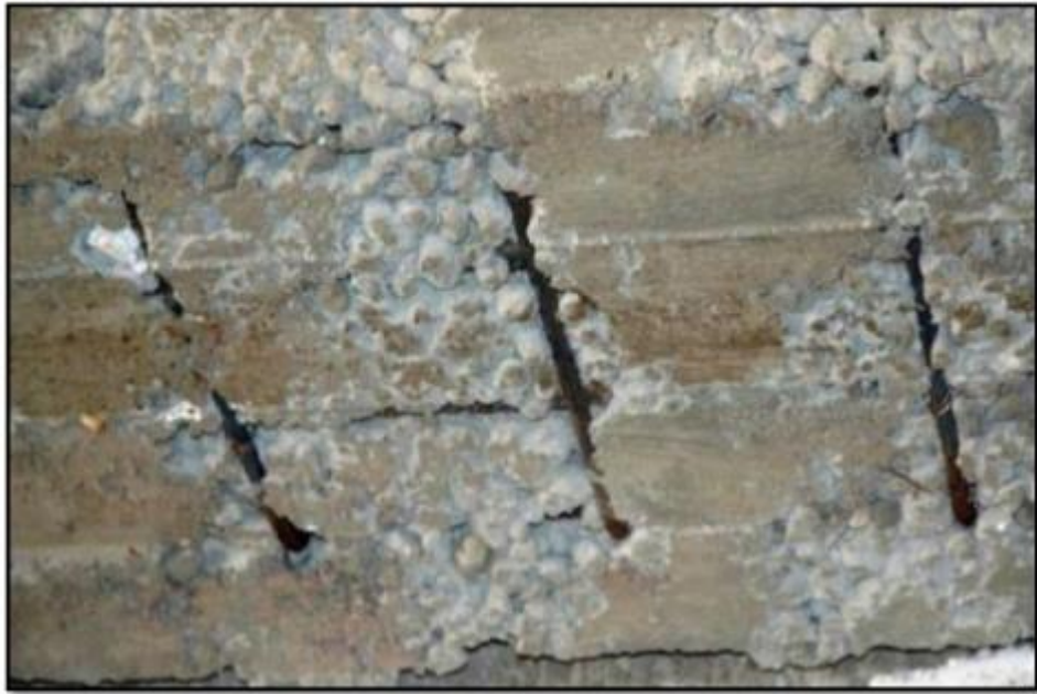
Ilustración 11: Segregación en losa armada
