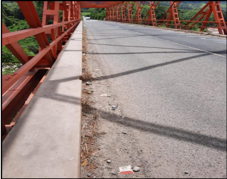
Foto N°07: Se aprecia el estado de la vereda y vía.
