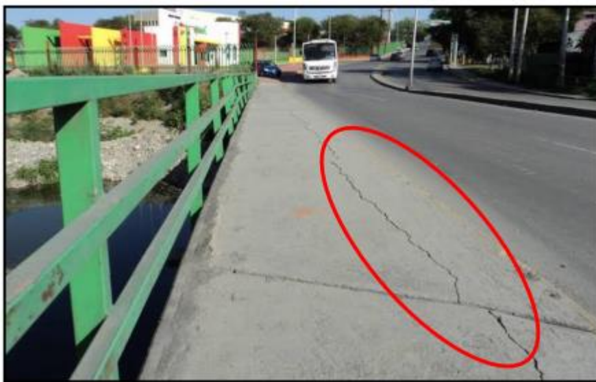
Ilustración 5: Fractura en losa de pavimento
