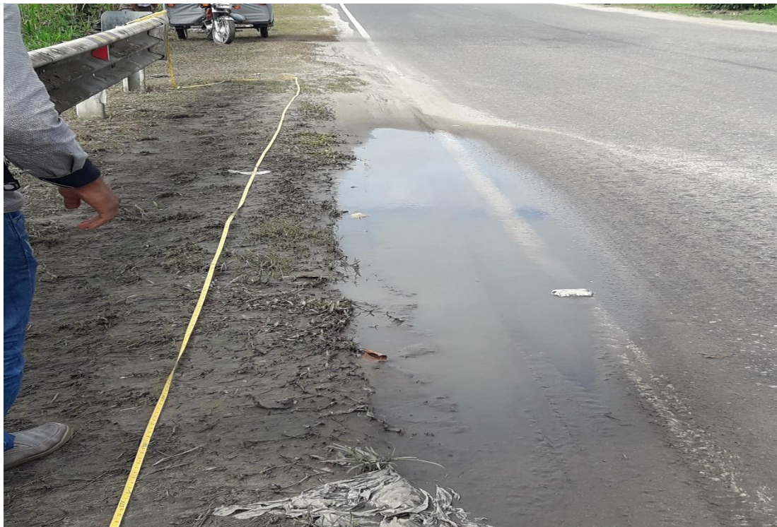
IMAGEN N°06: Acumulación de agua pluvial sobre el pavimento.
