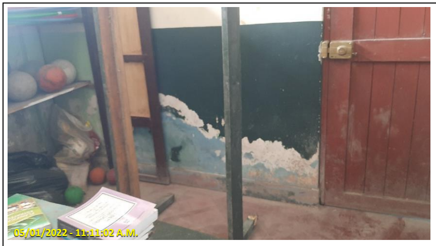
FALTA LIMPIEZA Y PINTURA EN EL AREA DE AUDITORIUM.
