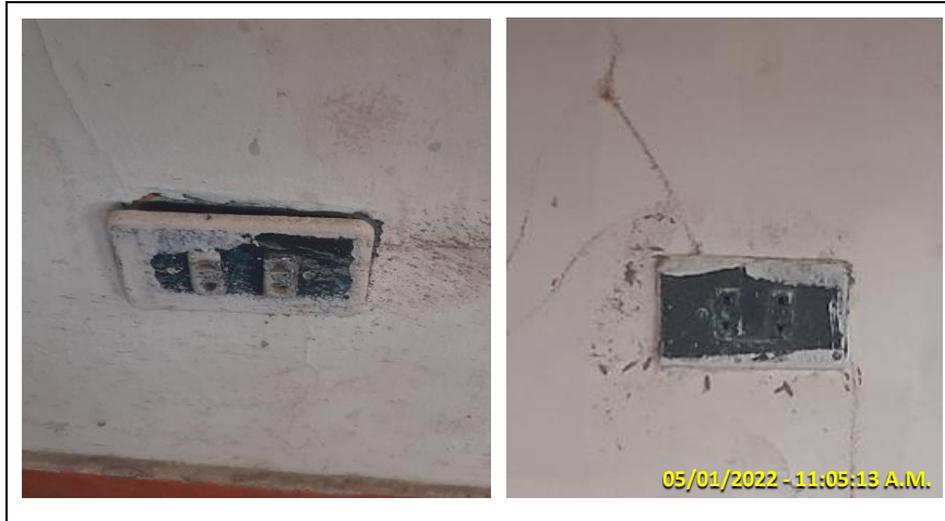
SE OBSERVA TOMACORRIENTES DETERIORADOS
