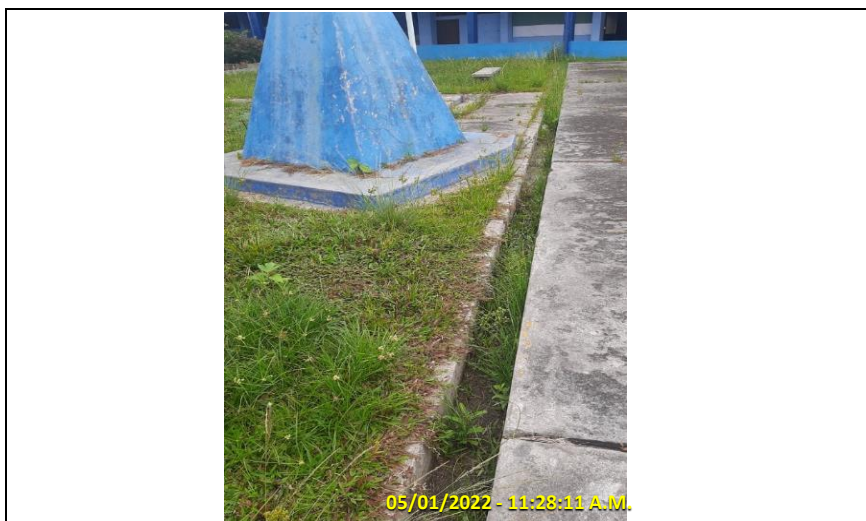
CUNETAS INTERIORES CON MALEZA LO QUE OCASIONA ANIEGOS EN PERIODOS DE LLUVIAS.
