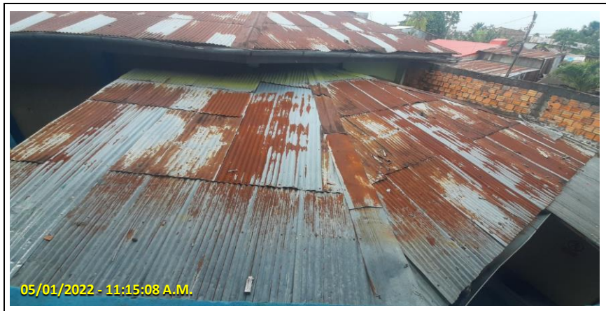
SE OBSERVA LA COBERTURA DE LOS SSHH DETERIORADOS.
