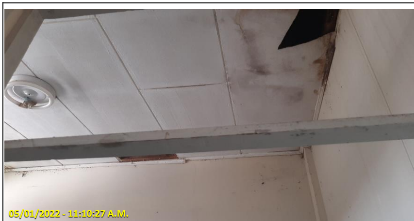
SE OBSERVA EL CIELORASO DETERIORADO EN AREA DE SSHH
