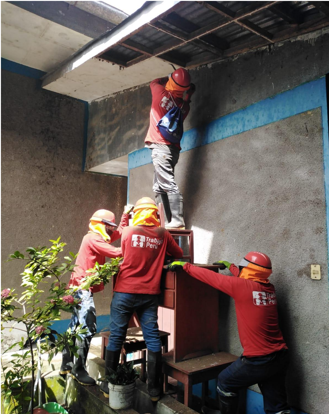
FOTOGRAFÍA 07: IDENTIFICACIÓN DE PELIGRO CAIDA DE ALTURA
