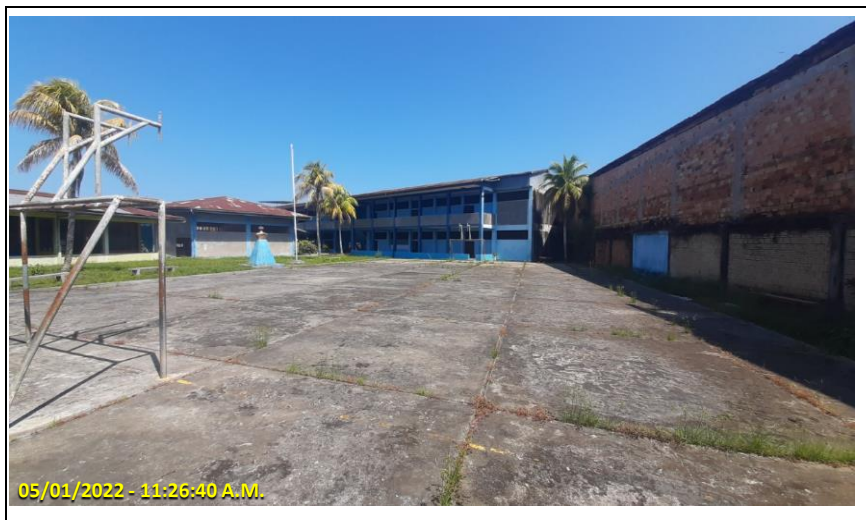
LOSA DEPORTIVA CON FALTA DE PINTURA PARA DEMARCAR. ARCOS SIN TABLEROS Y CON FALTA DE MANTENIMIENTO
