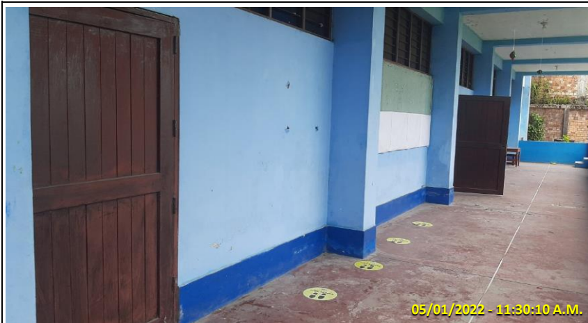
SE OBSERVA LA FALTA DE LIMPIEZA EN EL PISO.
