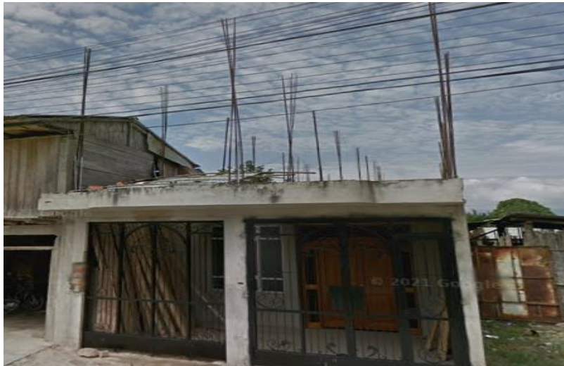
Grafico 31:vivienda en mal estado
