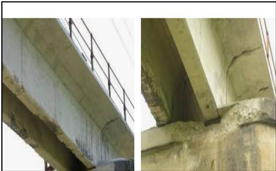
Ilustración 10: Cambio de Color del concreto en pilares y plataforma del puente Av. del Mediterráneo Calle 30 Madrid
