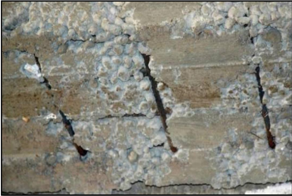
Ilustración 11: Segregación en Losa Armada
