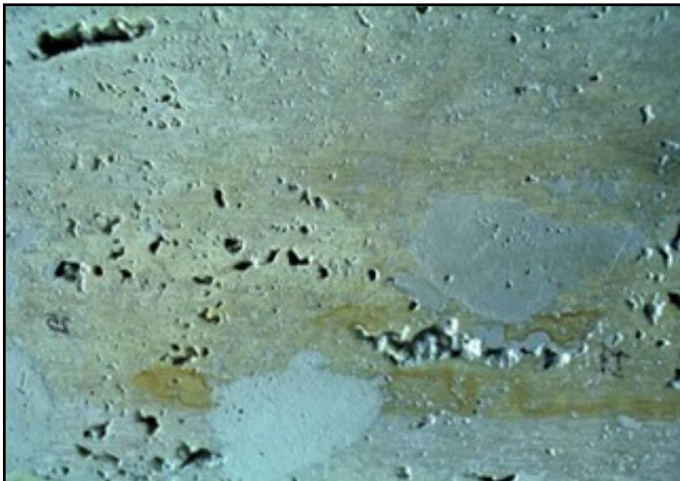
Ilustración 14: Oquedades en Columnas
