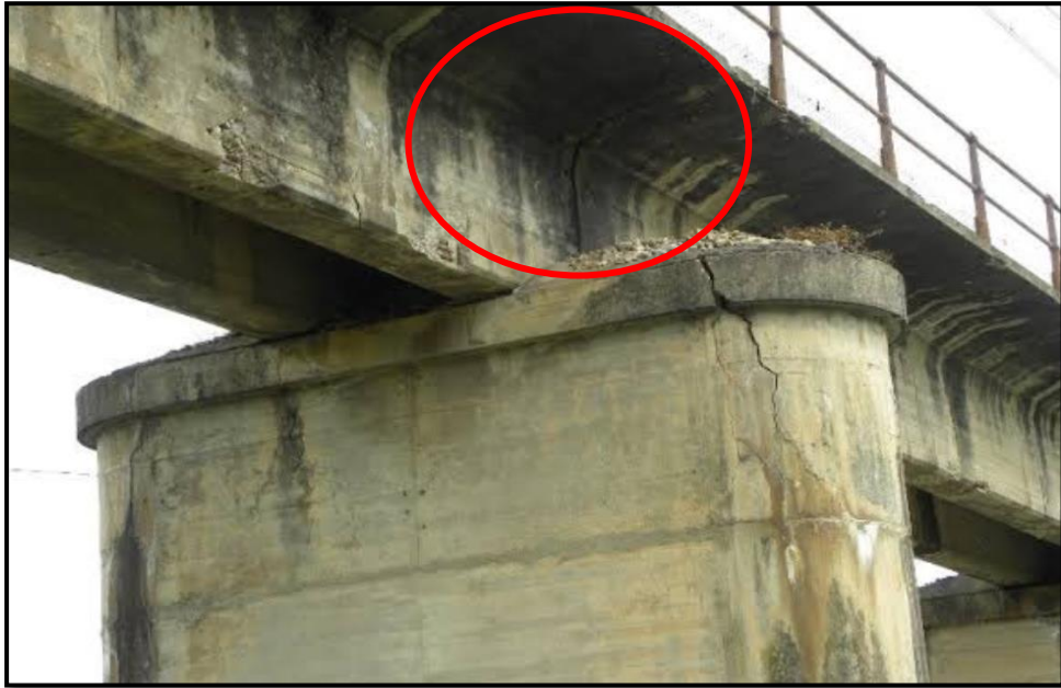
Ilustración 9: Eflorescencia en pilares y plataforma del puente Av. del Mediterráneo Calle 30 Madrid
