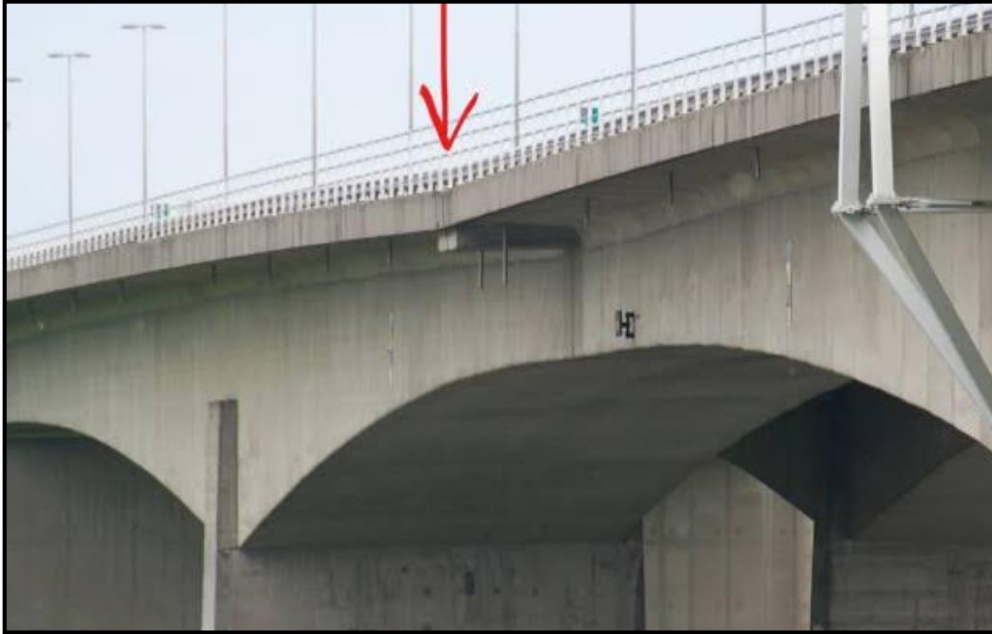
Ilustración 15: Deflexión en plataforma de puente
