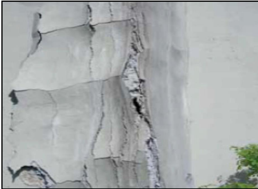
Ilustración 12: Cambio de Color del concreto en pilares y plataforma del puente Av. del Mediterráneo Calle 30 Madrid
