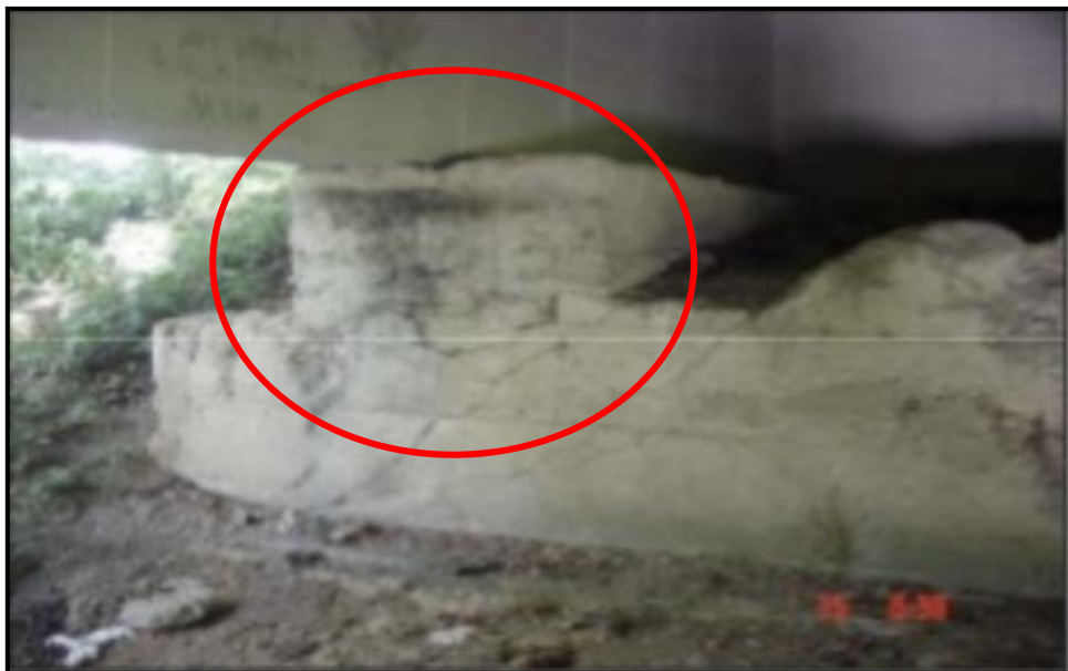
Ilustración 6: Aplastamiento en Pilares de Puente Laureano Gómez España
