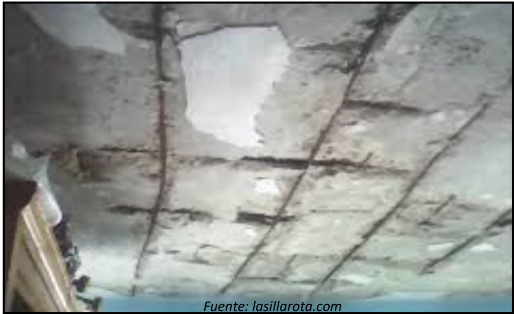
Ilustración 7: Desconchamientos losa de acercamiento Distribuidor vial de Cuernavaca México.
