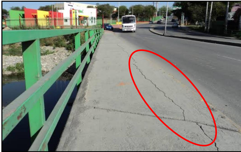
Ilustración 5: Fractura en Losa de Plataforma Puente San Sebastián - México
