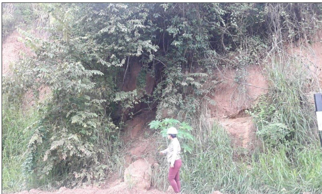
Figura 34: Se observó problemas de erosión en el talud.
