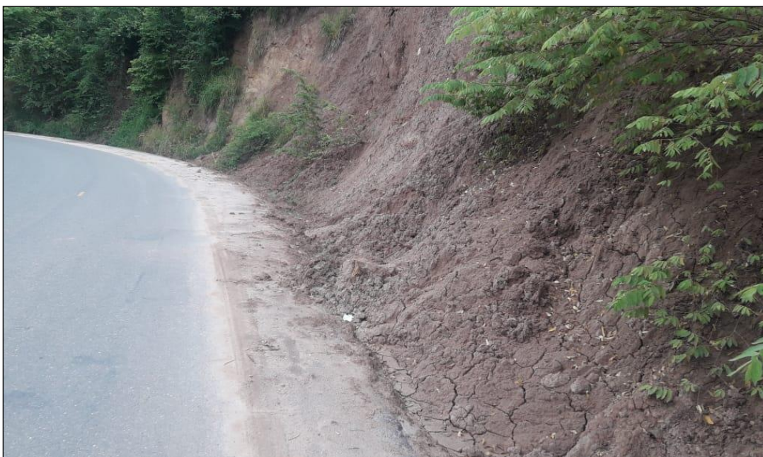
Figura 35: Se observó colmatación de material en grandes proporciones en las cunetas revestidas.
