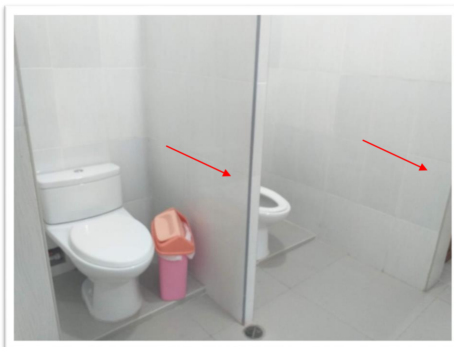
Figura 5: Servicios Higiénicos dentro de los dormitorios Fuente: Autoría Propia
