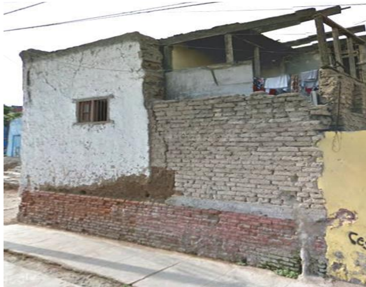
Figura 05. Estado de las Fachadas de la Quinta. Fuente: (Pino K., S. Tokumura, 2017).
