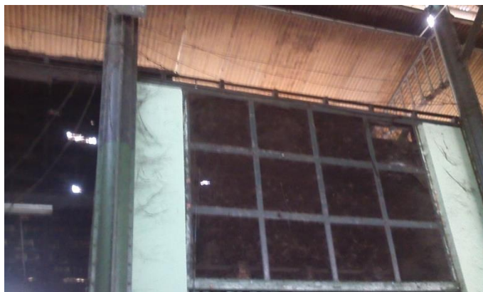
Figura 41. Suciedad en la estructura metálica del mercado. Fuente: Propia.
