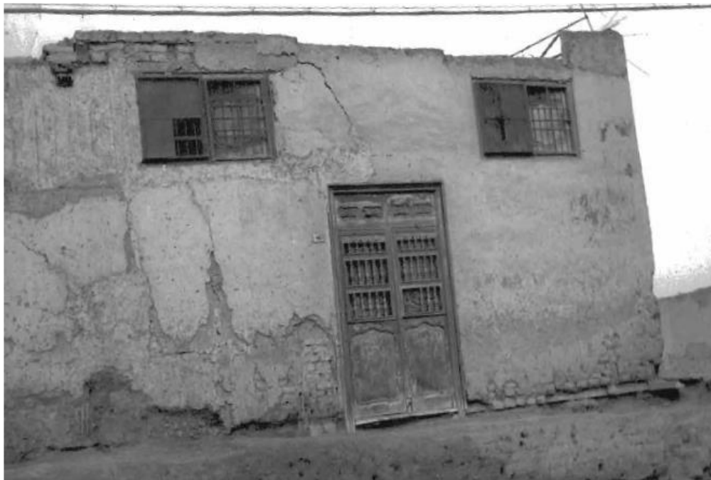
Figura 04. Estado de las Fachadas de la Quinta. Fuente: (Pino K., S. Tokumura, 2017).
