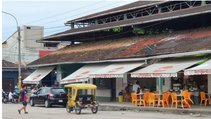
Figura 42. Sistemas eléctricos y pluviales en mal estado. Fuente: Elaboración propia.
